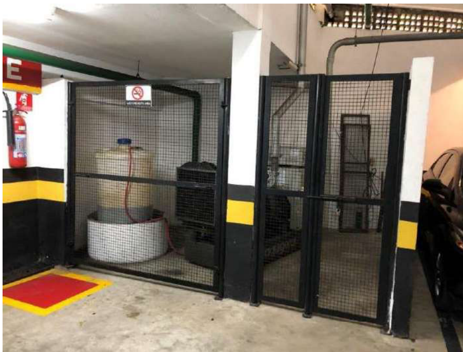
Foto 16. Vista parcial do gerador do edifício.
