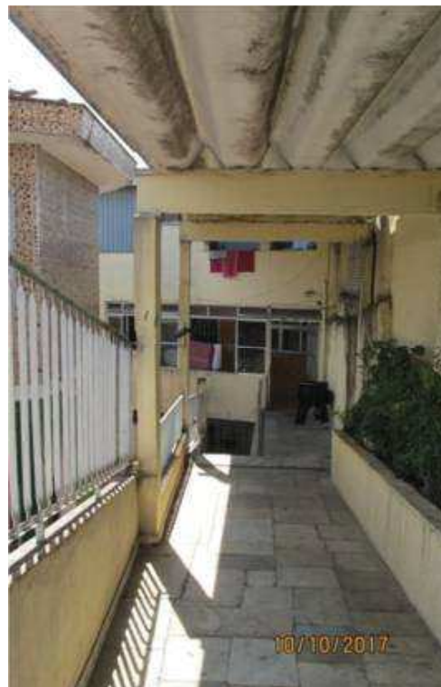
Foto 18) Vista do corredor de acesso a, segundo informado, 03 (três) moradias, com largura de 2,00 metros. Observar acabamento de piso e paredes, cobertura em telhas fibrocimento, tipo calhetão, sobre estrutura em madeira aparente.
