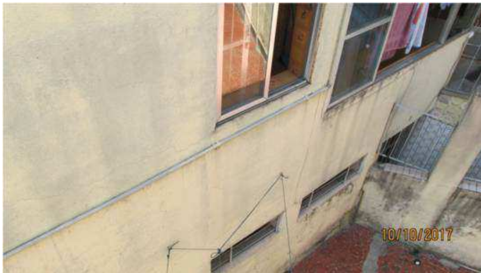
Foto 19) Vista da elevação de fundos da construção, que se eleva após o corredor de acesso. Observar fachada em massa única, caixilhos metálicos no piso inferior e em alumínio no intermediário e dependências azulejadas.
