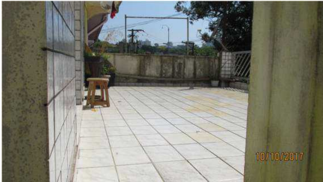
Foto 07) Vista do terraço frontal, sobre as garagens. Observar acabamento de piso, fachada e guardacorpo em alumínio.
