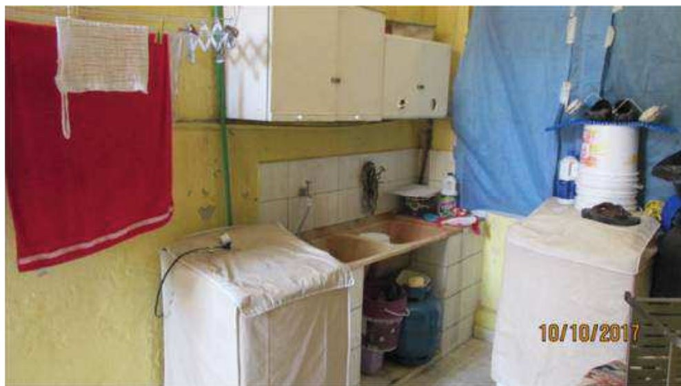
Foto 12) Vista da área de serviço. Observar acabamento de piso e paredes, tanque duplo em material sintético apoiado sobre alvenaria, parede hidráulica revestida por azulejos na área molhável.
