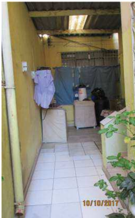
Foto 11) Vista do corredor em direção à área de serviço. Observar acabamento de piso e paredes, cobertura em telhas de fibrocimento sobre estrutura em madeira aparente.
