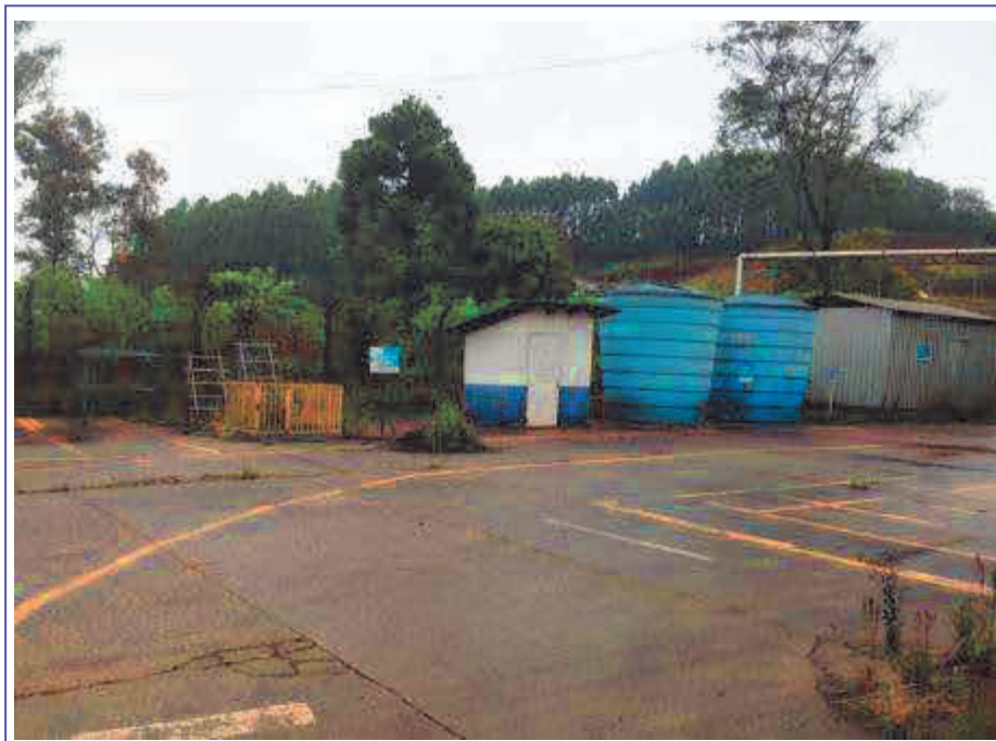
CASA DE BOMBAS
