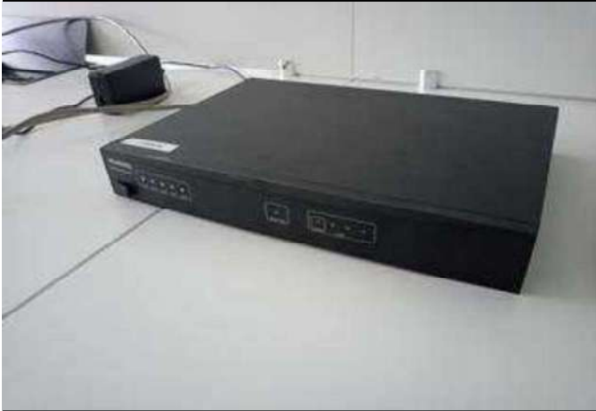
ITEM 1,417 - ROTEADOR HUAWEI AR161F LOCAL: SERVIDOR
