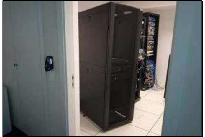
ITEM 1,398 - RACK SERVIDOR APC LOCAL: SERVIDOR
