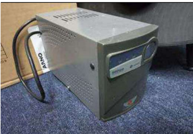
ITEM 1,371 - ESTABILIZADOR RAGTECH SENSE MICROPROCESSOR LOCAL: SALA INFORMÁTICA
