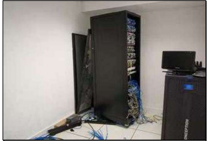
ITEM 1,416 - RACK SERVIDOR GRANDE LOCAL: SERVIDOR
