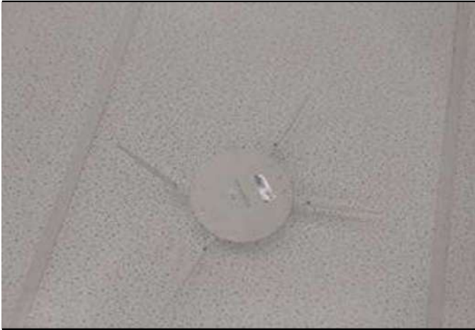
ITEM 1,391 - ROTEADOR WIFI FORTINET LOCAL: SALA DE DESCOMPRESSÃO
