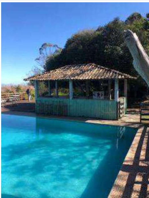
Foto 27 – pequena estrutura ao redor da piscina – acabamento de madeira apresentando muito desgaste, telhas com muitos sinais de infiltrações - estrutura com muito risco de insalubridade.
