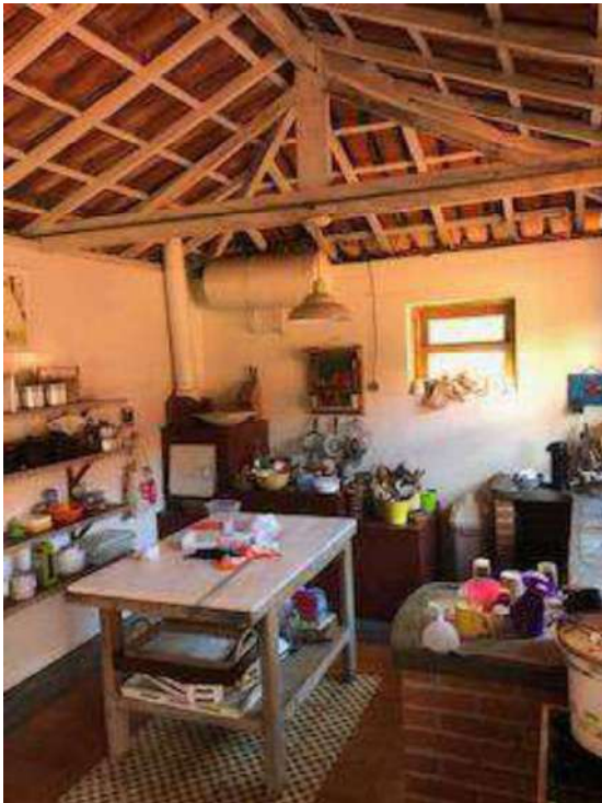
Foto 23 – cozinha sem forro e telhado aparente
