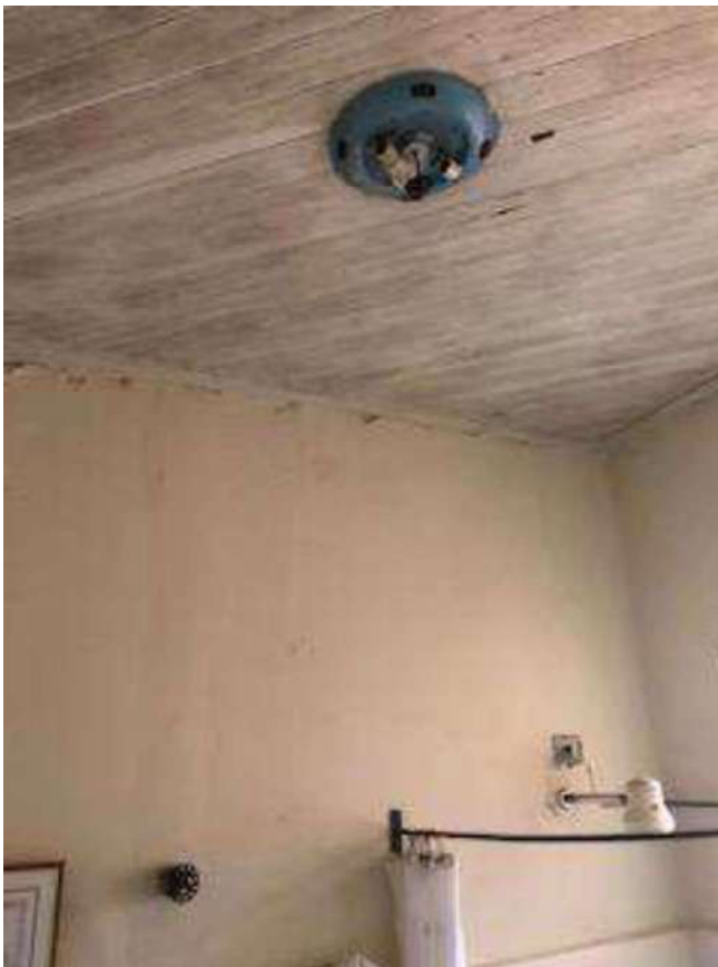
Foto 20 - detalhe para fissuras aparentes entre parede e teto e vazamentos (na projeção do cano de registro)
