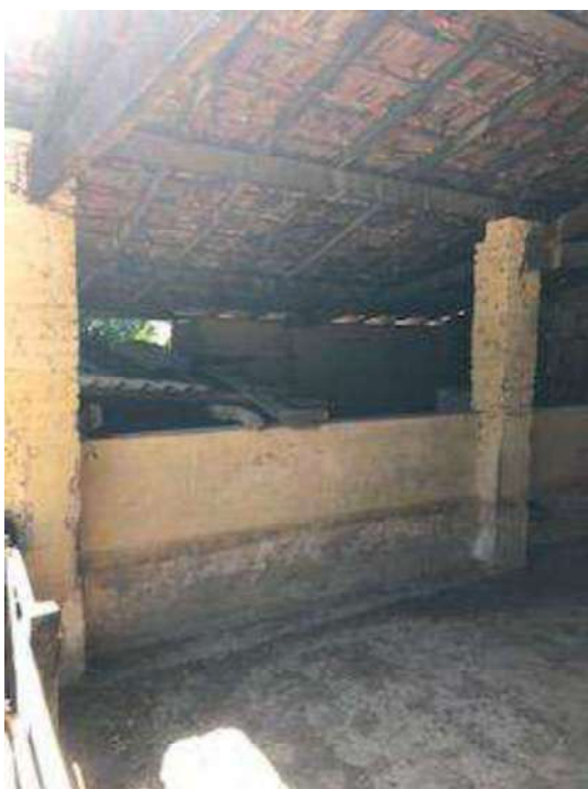
Foto 40 – Situação de falta de manutenção e até perigo de desabamento (antiga benfeitoria, barracão 2)
