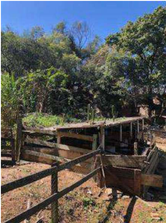
Foto 45 – cercas e pequenas estruturas deficientes
