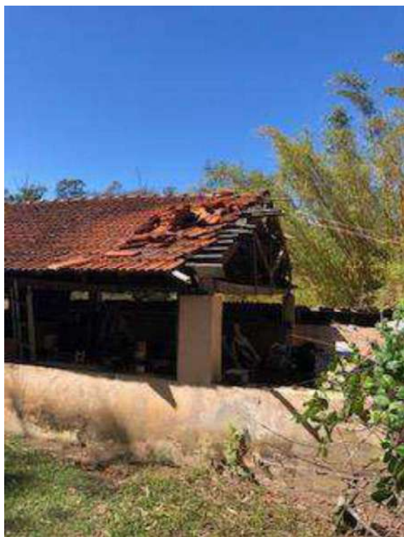
Foto 36— apesar de não ser a casa do caseiro, era uma benfeitoria produtiva em frente à casa do caseiro, e demonstra a falta de manutenção do proprietário em relação às instalações
