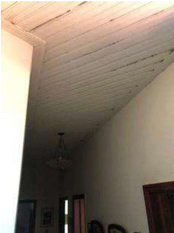
FOTO 12 – Detalhe do teto em quase toda extensão da casa apresenta fissuras e mau estado de conservação do forro de madeira
