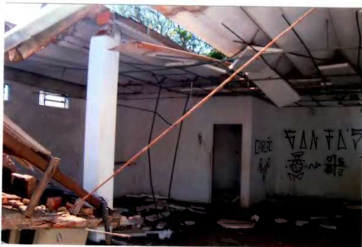
Vista parcial das condições do prédio destinado a administração e loja de conveniência do posto
