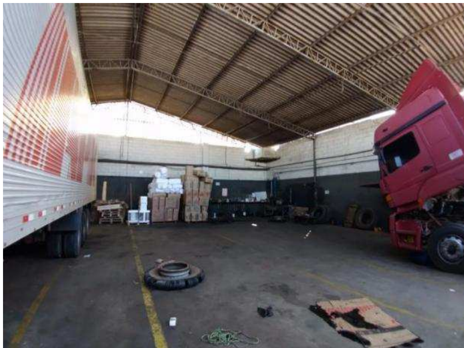
VISTA DA OFICINA DE REPAROS MECÂNICOS.
