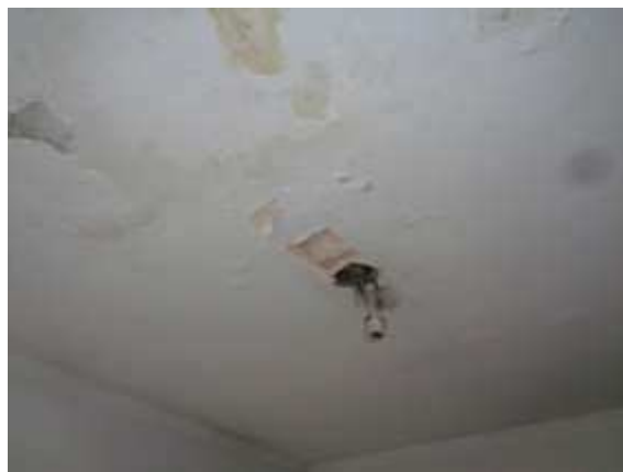
Vista parcial do teto escritório - umidade
