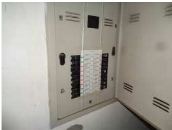
Vista parcial do quadro de distribuição
