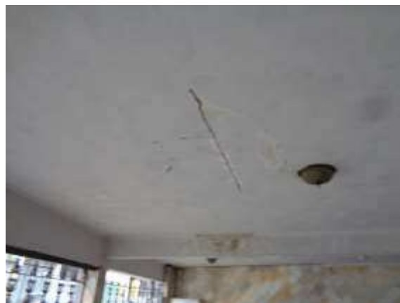
Vista parcial do teto da garagem – umidade
