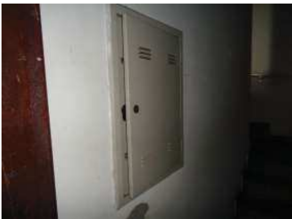
Vista parcial do quadro de distribuição
