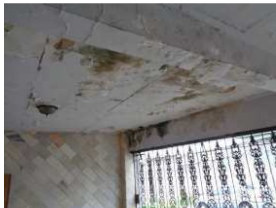
Vista parcial do teto da garagem – umidade
