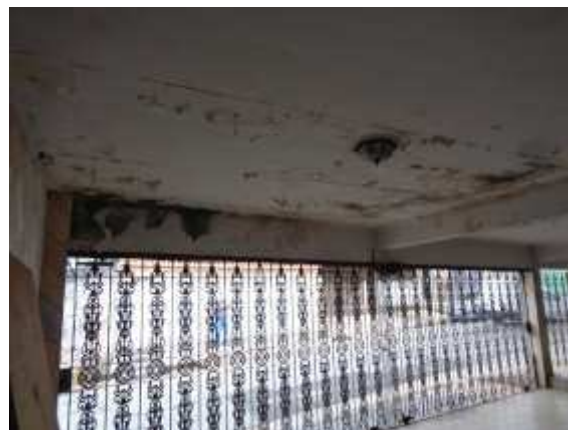
Vista parcial do teto da garagem – umidade
