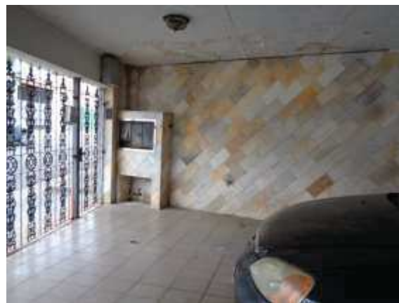
Vista parcial do teto da garagem – umidade
