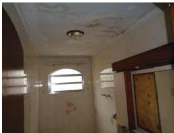
Vista parcial do teto banheiro - umidade
