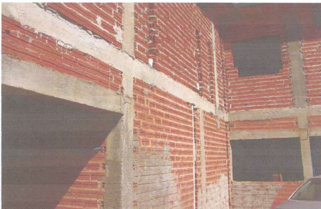
FOTO 05 - Vista da área externa do quintal onde vemos a obra sem reboco e sem instalações hidráulicas ou elétricas.
