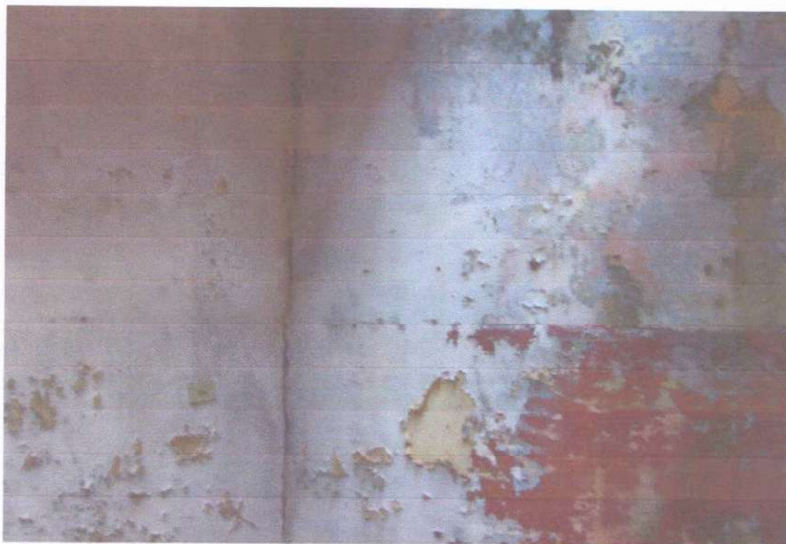
FOTO 13 - Vista interna de um dos cômodos frontais onde vemos seu estado de conservação.
