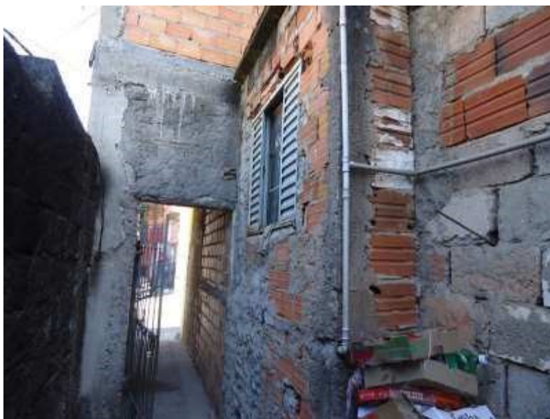
Foto 03- Detalhe externo da edificação – Pav. Térreo – Instalações hidráulica precária
