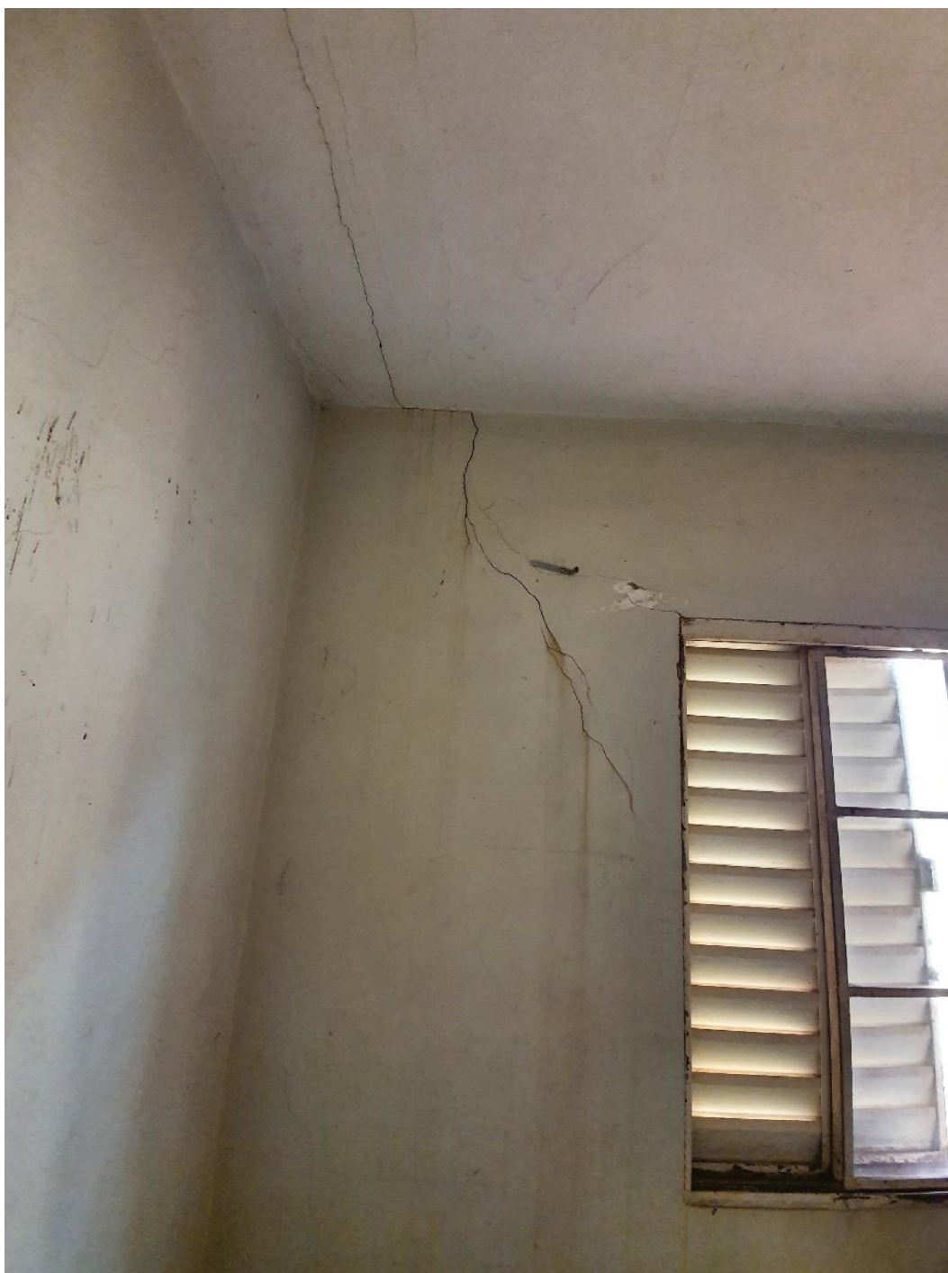
Foto 15 – Detalhe da rachadura na laje a qual desce em ângulo pela parede onde se encontra a janela do quarto.
