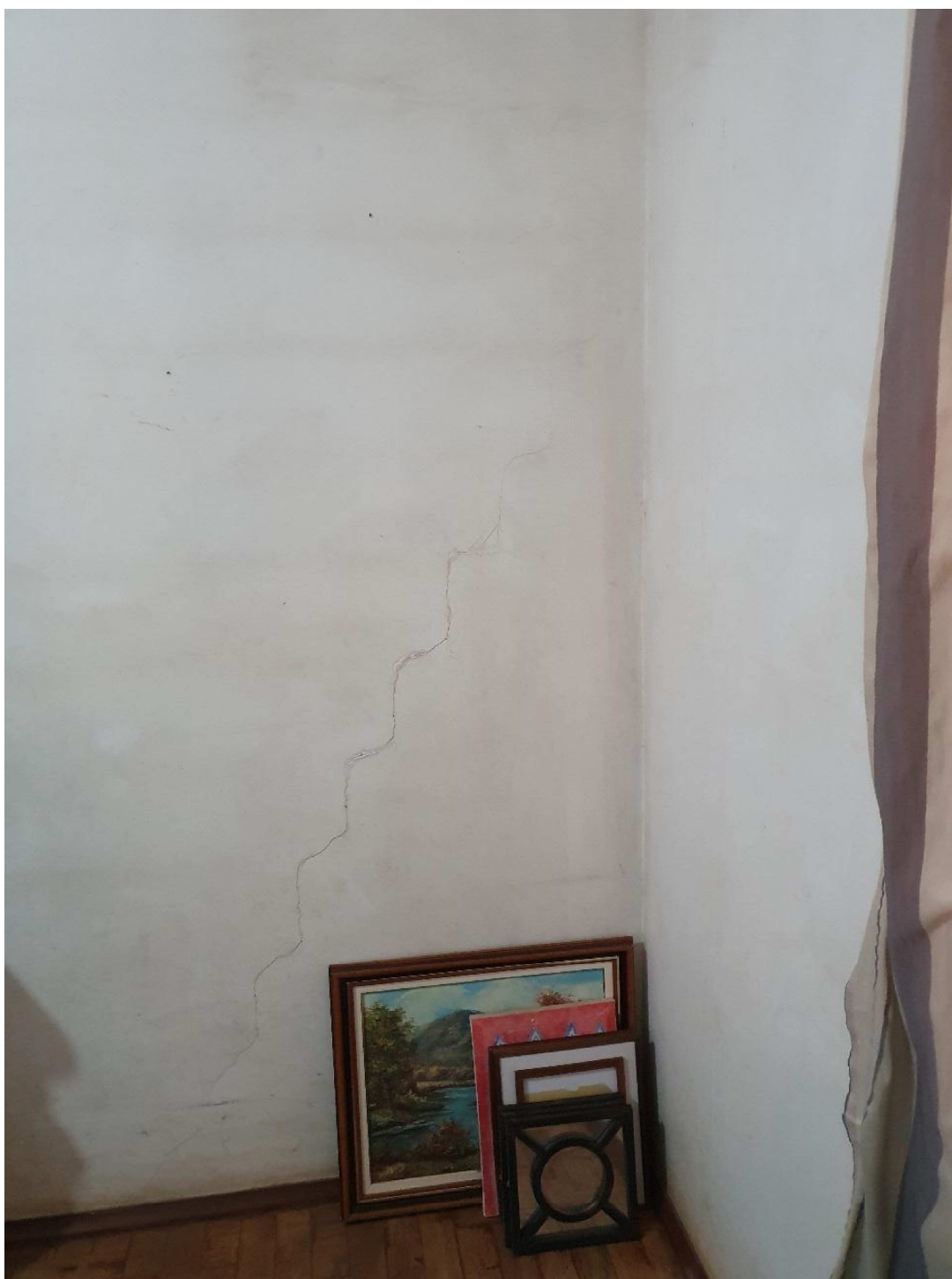
Foto 60 – Mesma parede foto anterior, trinca em 45 °
