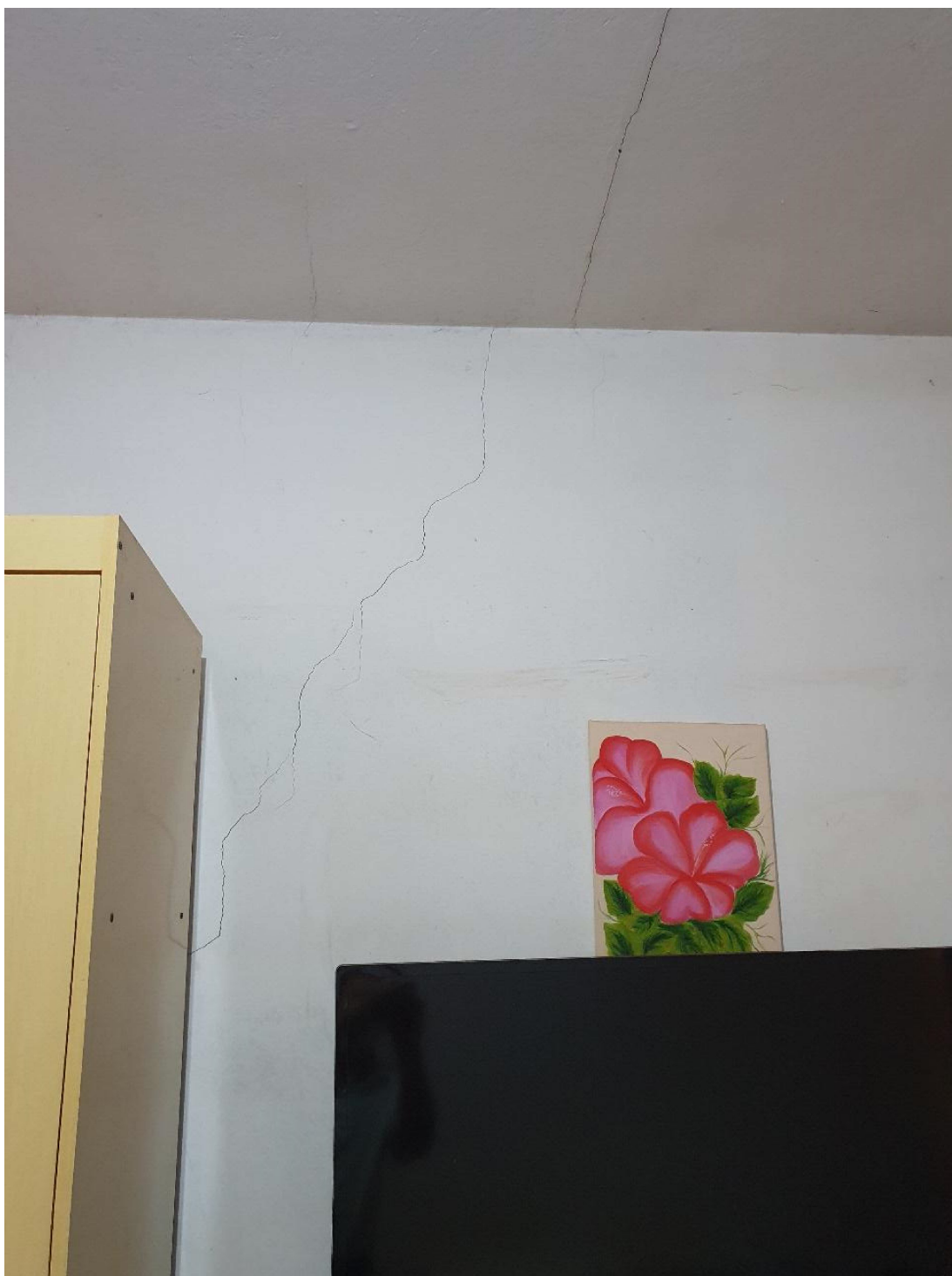
Foto 59 – Trincas descem em 45 ° pela parede de frente para a porta.
