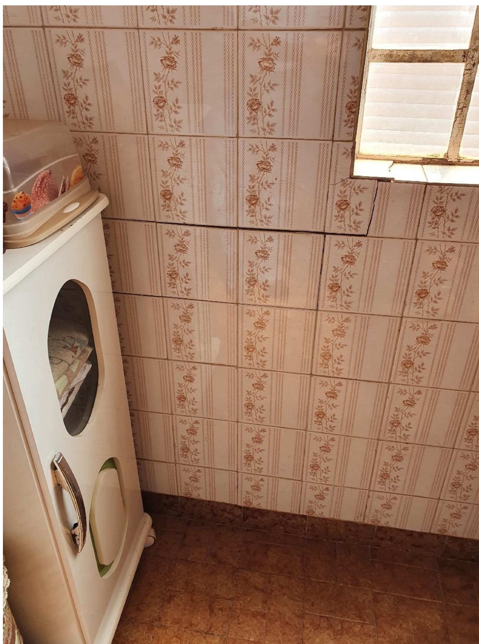
Foto 41 – Rachaduras no azulejo lado esquerdo.
