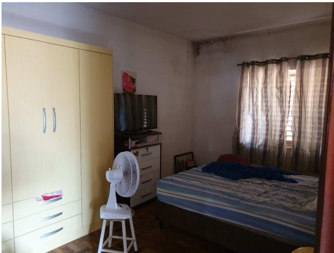
Foto 55 – Detalhe de infiltração na parede da janela.
