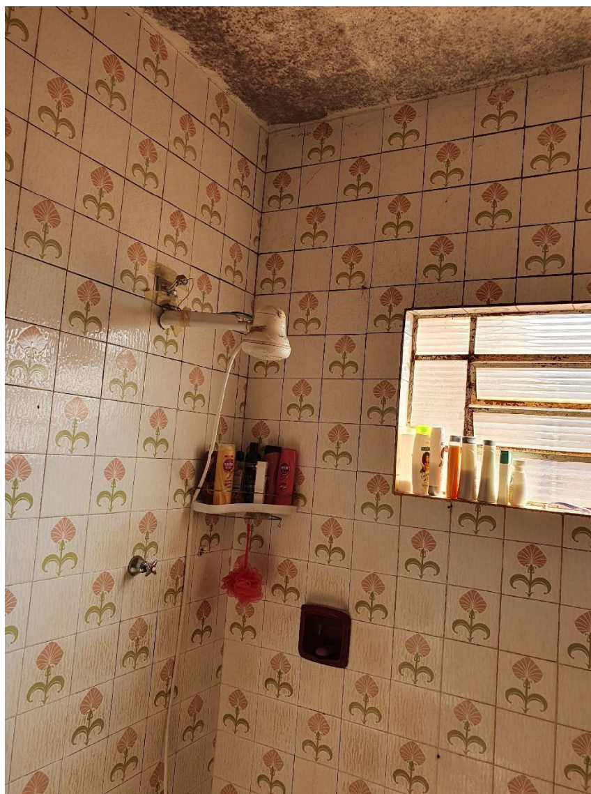
Foto 33 – Infiltração na laje do banheiro.
