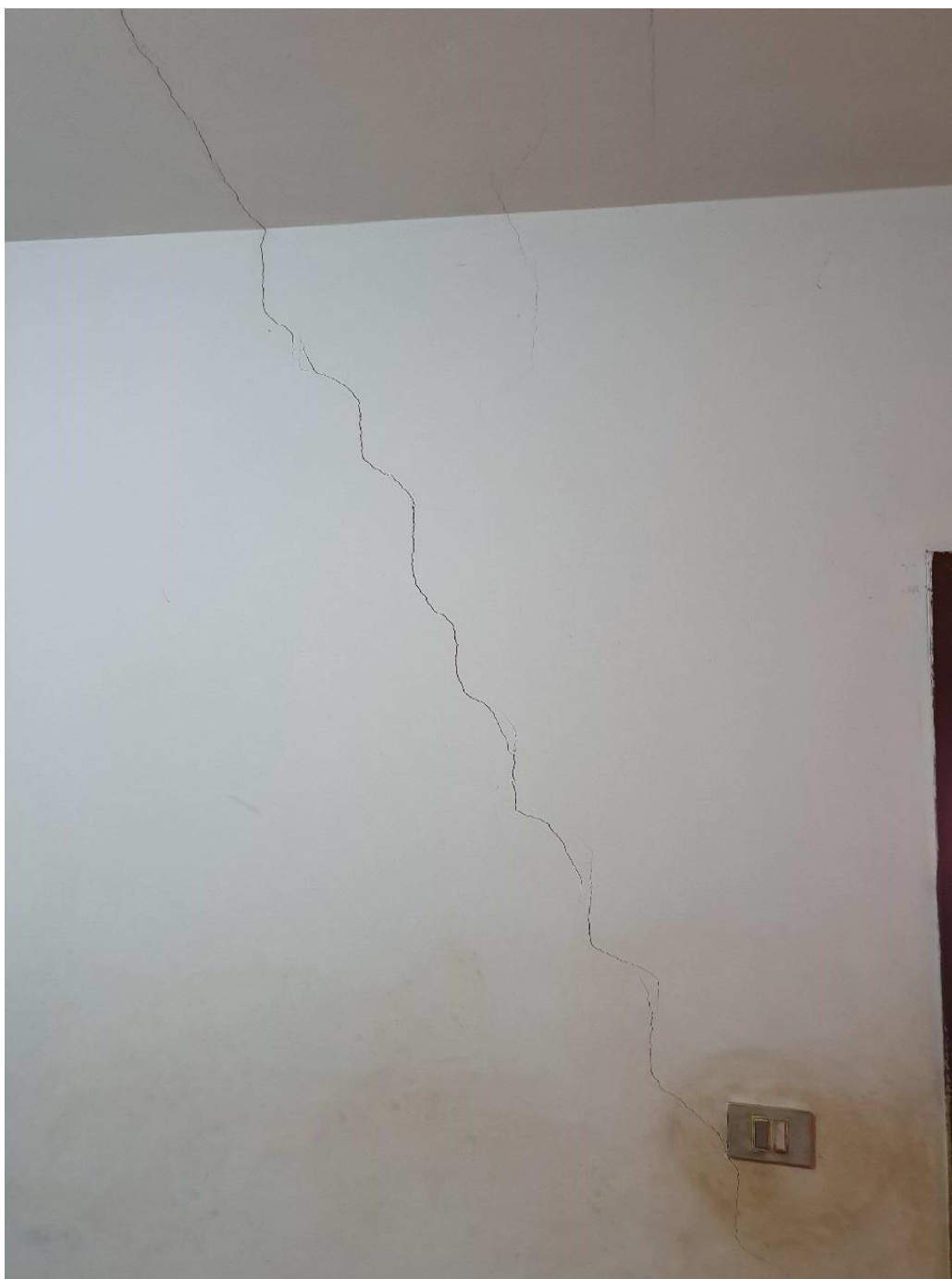
Foto 61- Rachadura que desce em ângulo, da laje até o batente da porta.
