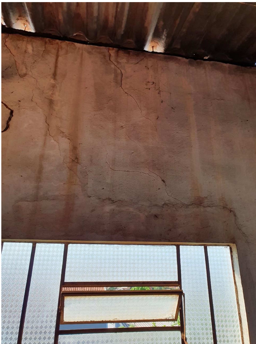
Foto 19 – Parede acima da janela da lavanderia, rachaduras em ângulo e perto da janela, na horizontal.
