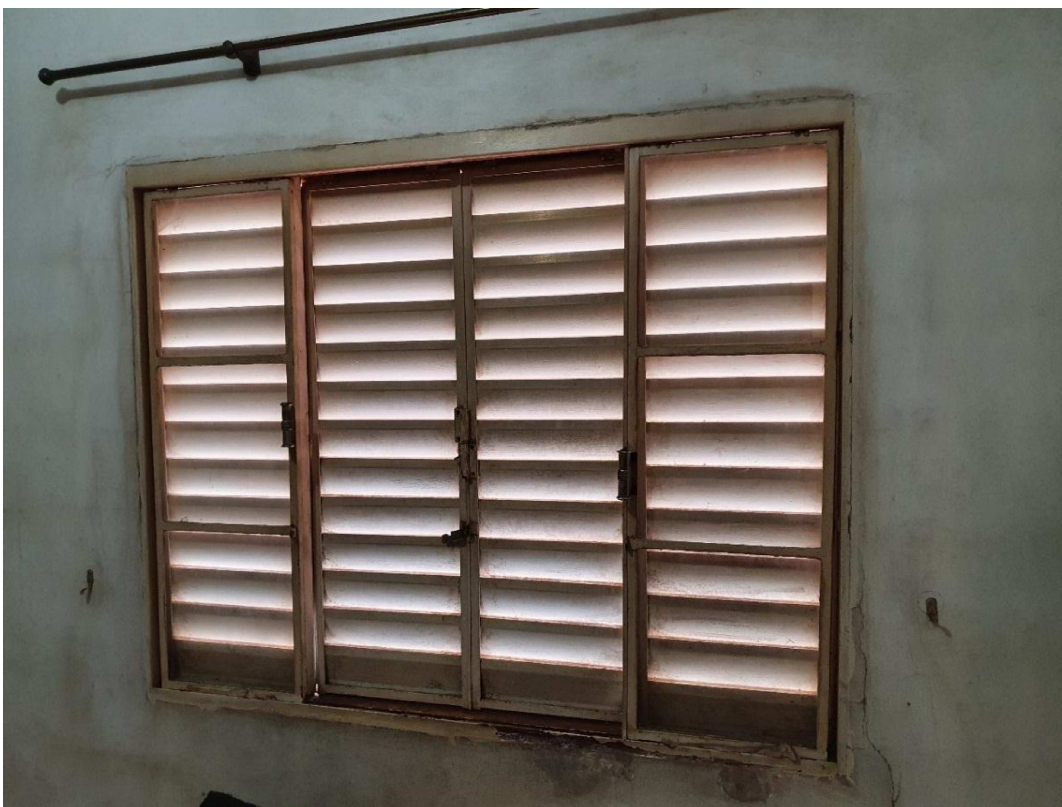
Foto 44 – Janela necessita de manutenção, a parede apresenta várias trincas.
