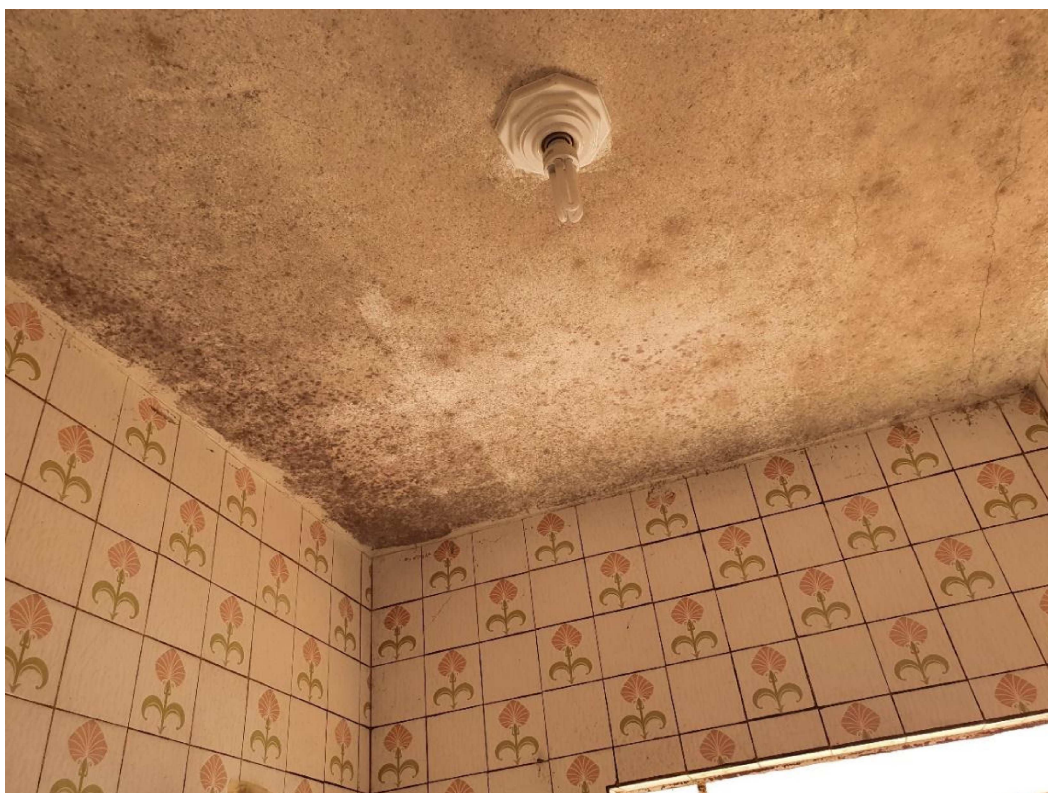
Foto 34 – Trincas na laje, em toda a sua extensão.
