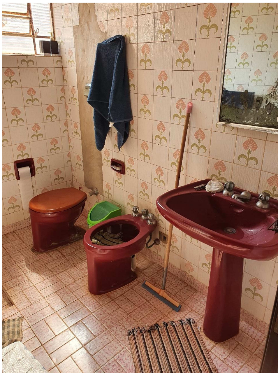
Foto 31 – Banheiro, faltam azulejos no local onde houve conserto do encanamento do vaso sanitário.
