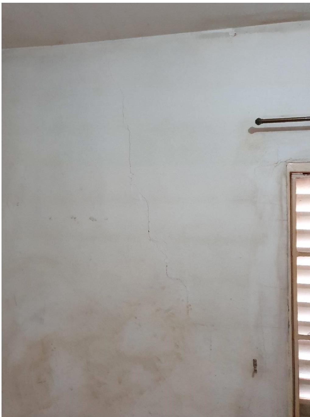
Foto 47 – Trinca em ângulo de 45° ao lado esquerdo da janela
