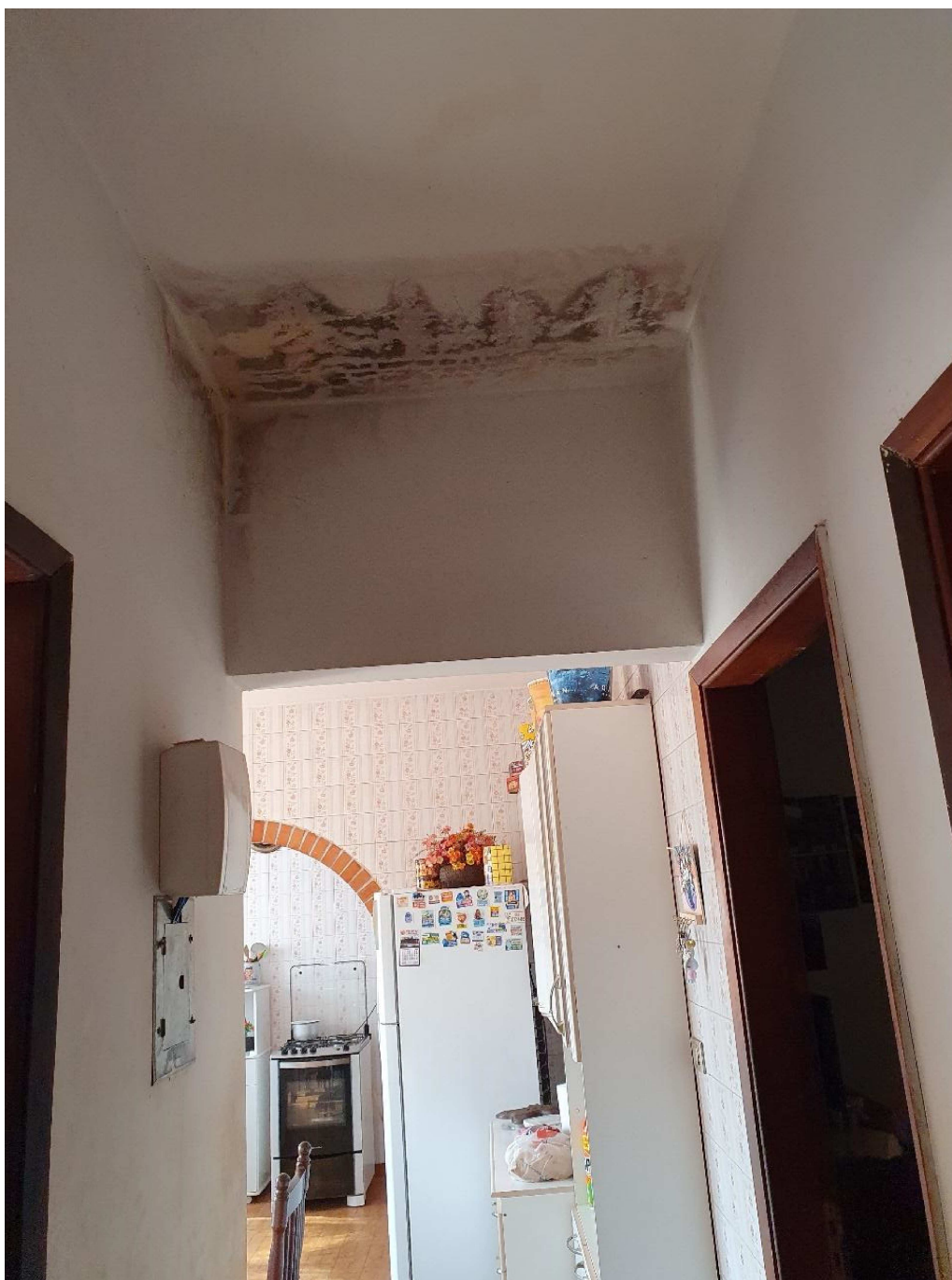
Foto 53 – Detalhe da infiltração na laje do corredor.
