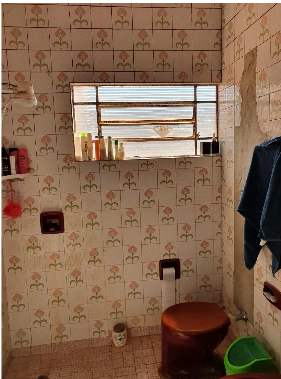
Foto 32 – Vitro enferrujado e com vidro quebrado.
