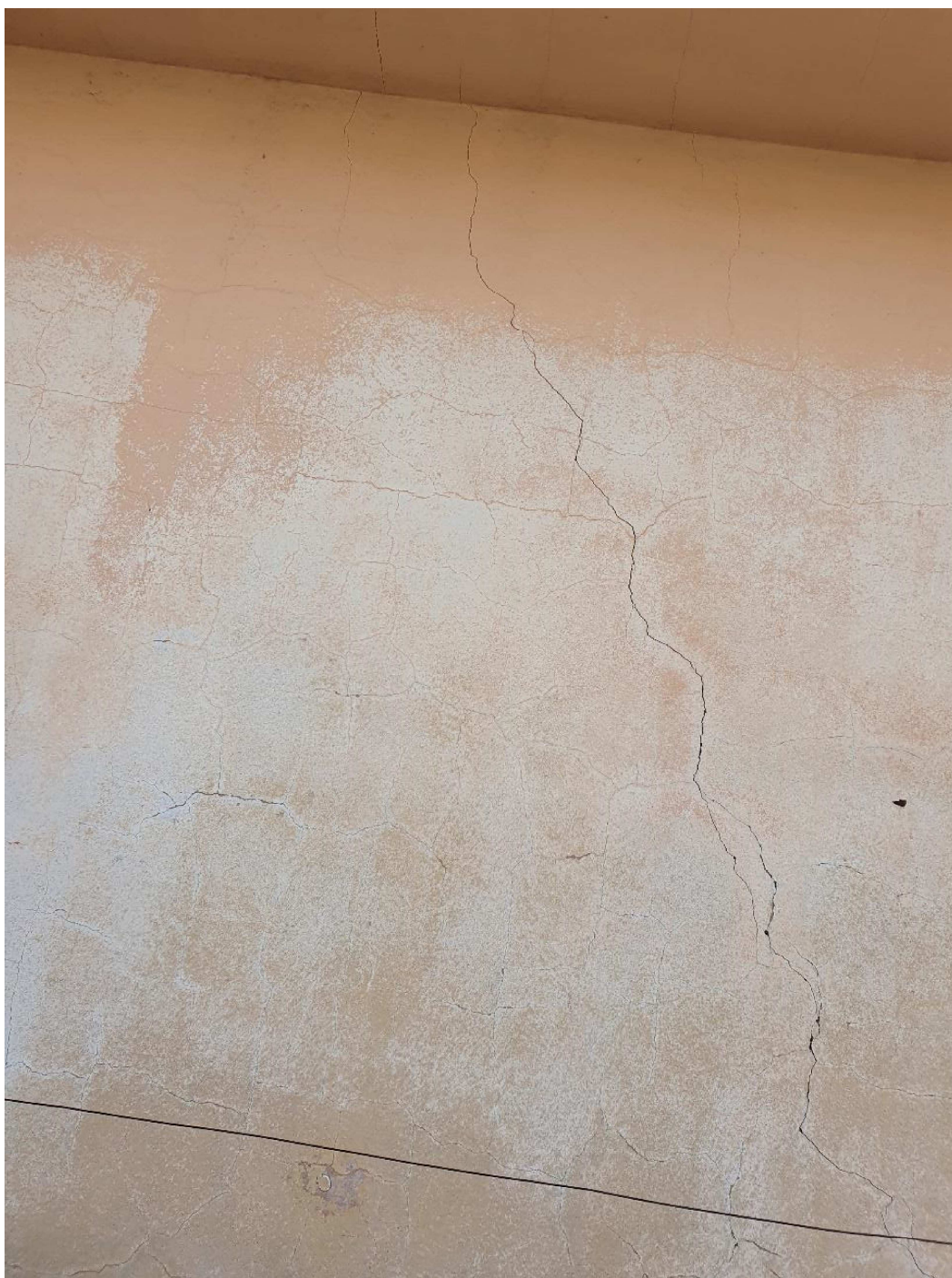
Foto 66 – Rachadura na parte externa que vem de dentro, de cima abaixo.
