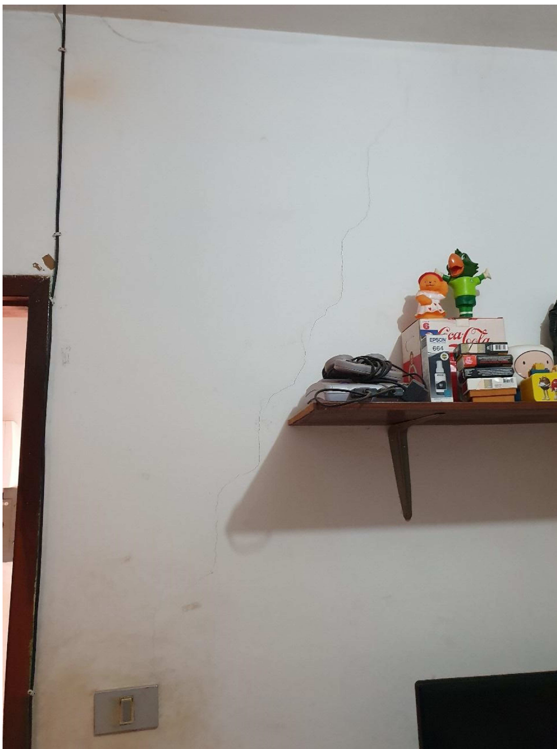
Foto 50 – Parede da porta, trincas são em 45 ° e próxima a laje também.
