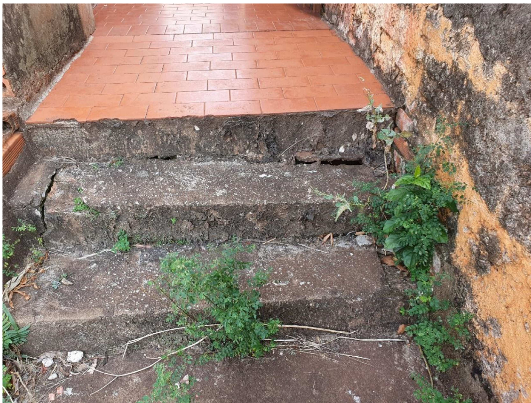
Foto 22 – Calçada que dá acesso aos fundos do imóvel está afundando.
