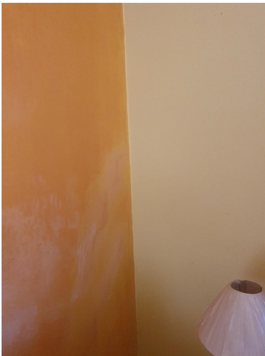
Foto 30 – Infiltração na mesma parede da foto anterior.
