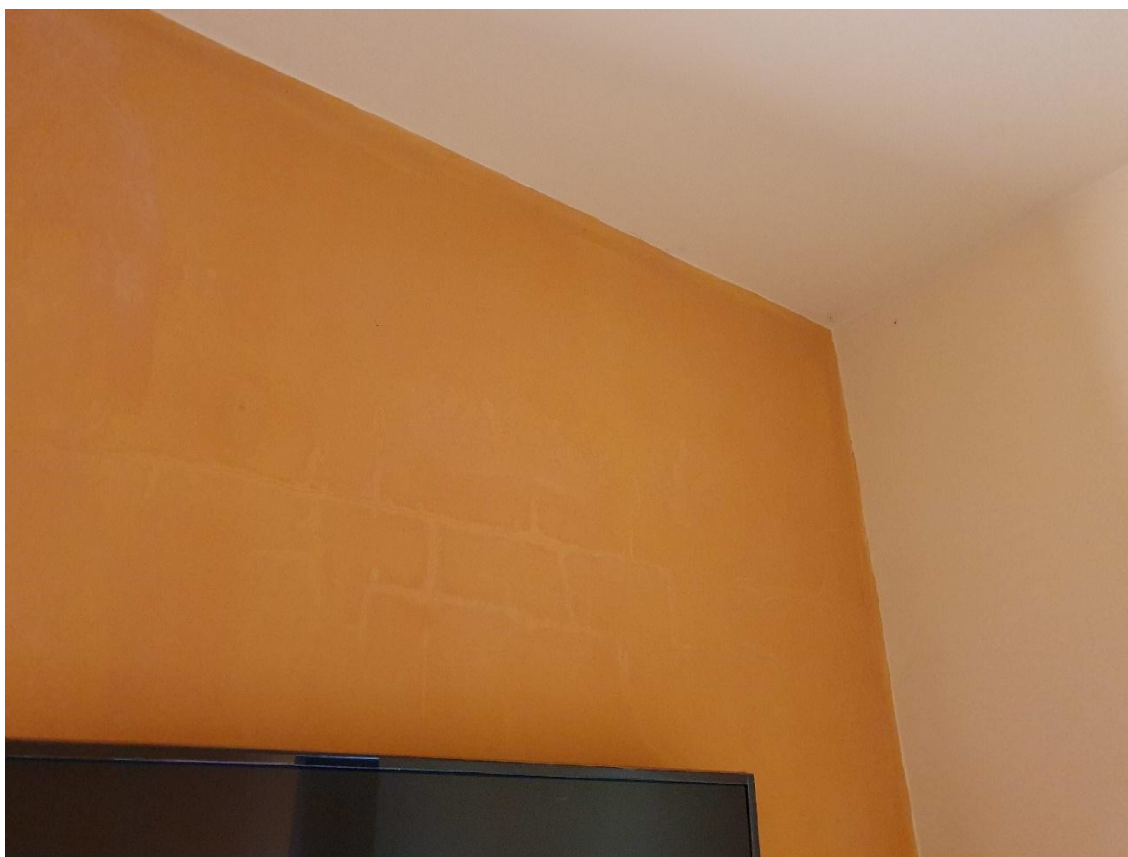
Foto 29 – Infiltração na parede, divisa com o banheiro.
