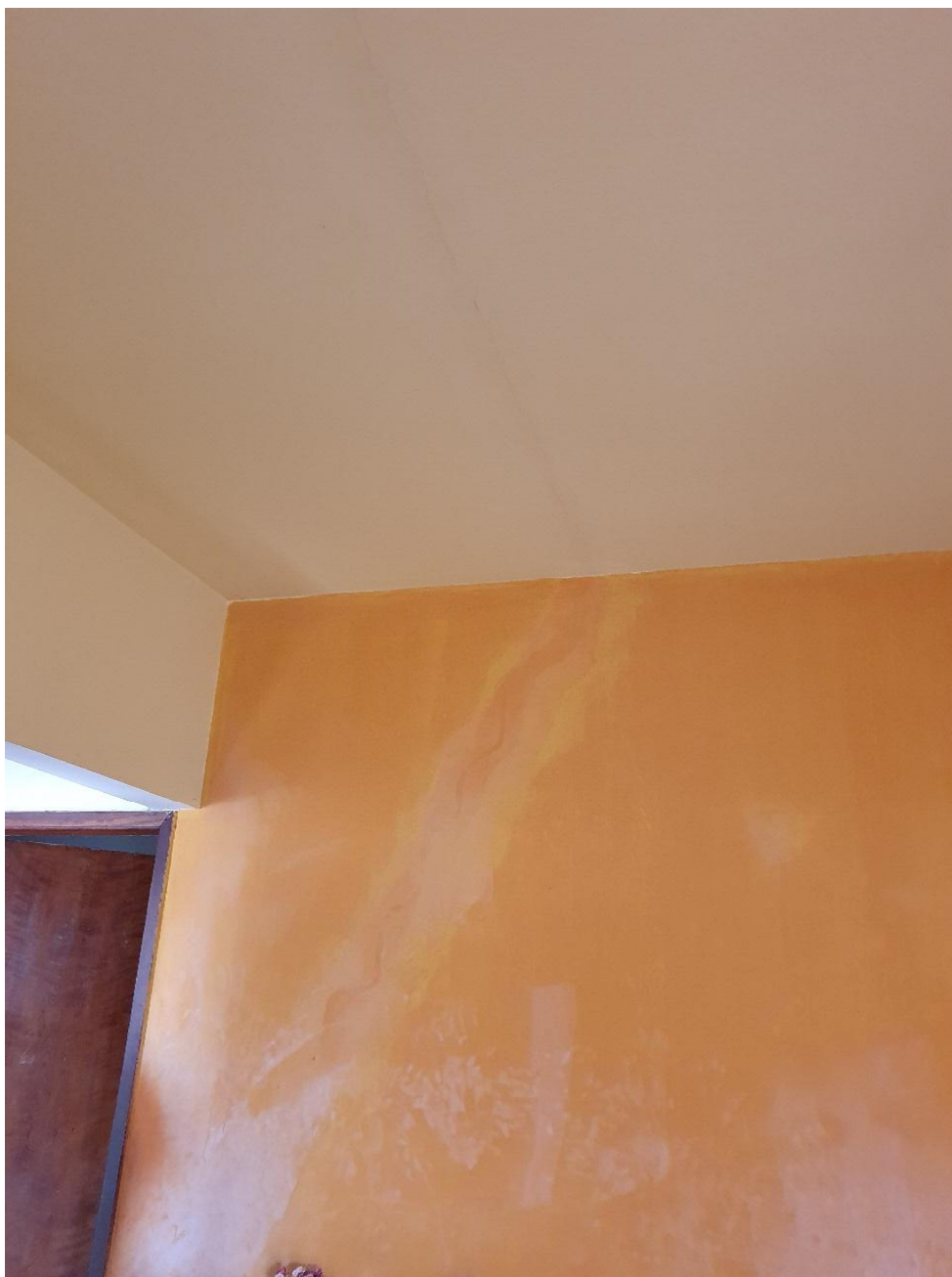
Foto 28 – Detalhes de infiltração, rachaduras na parede, divisa com o quarto I e na laje em toda a sua extensão.
