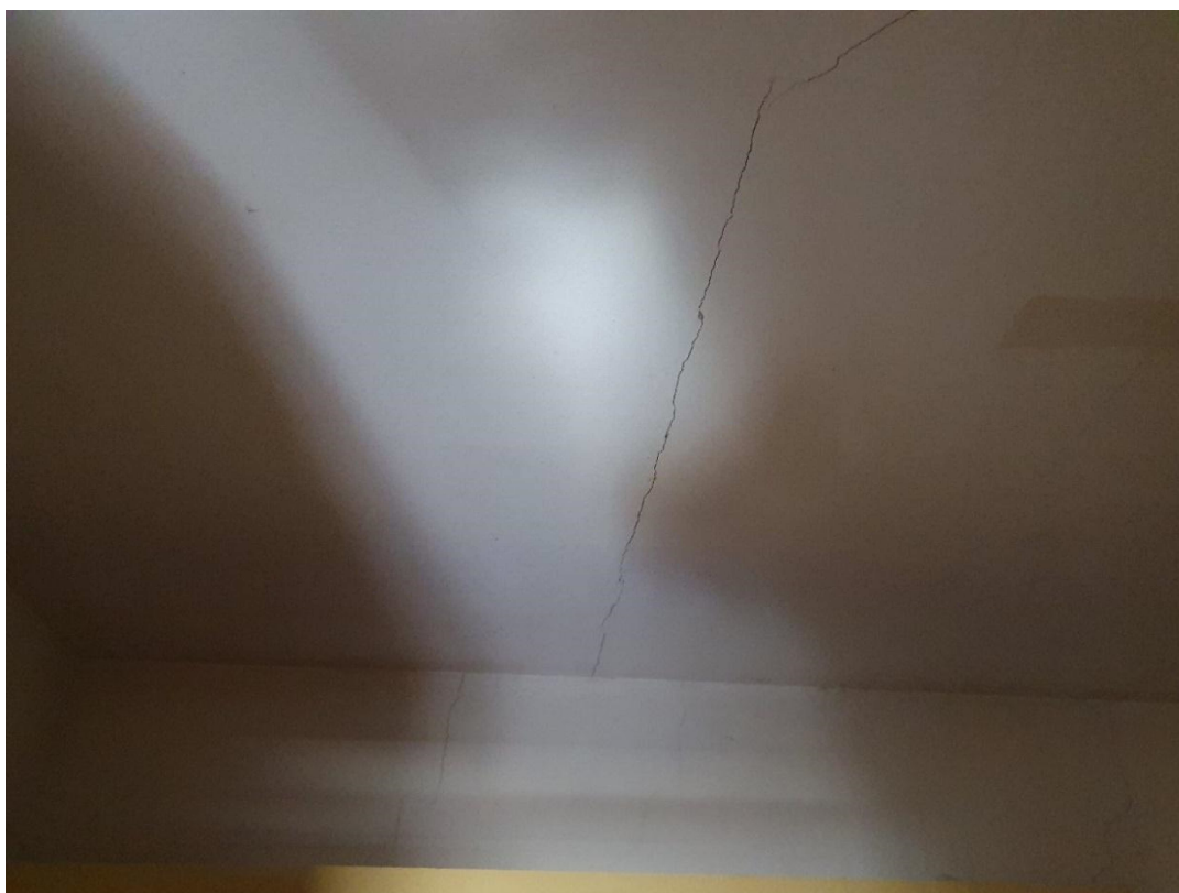
Foto 56 e 57 e 58 – Rachaduras na laje em toda a sua extensão.
