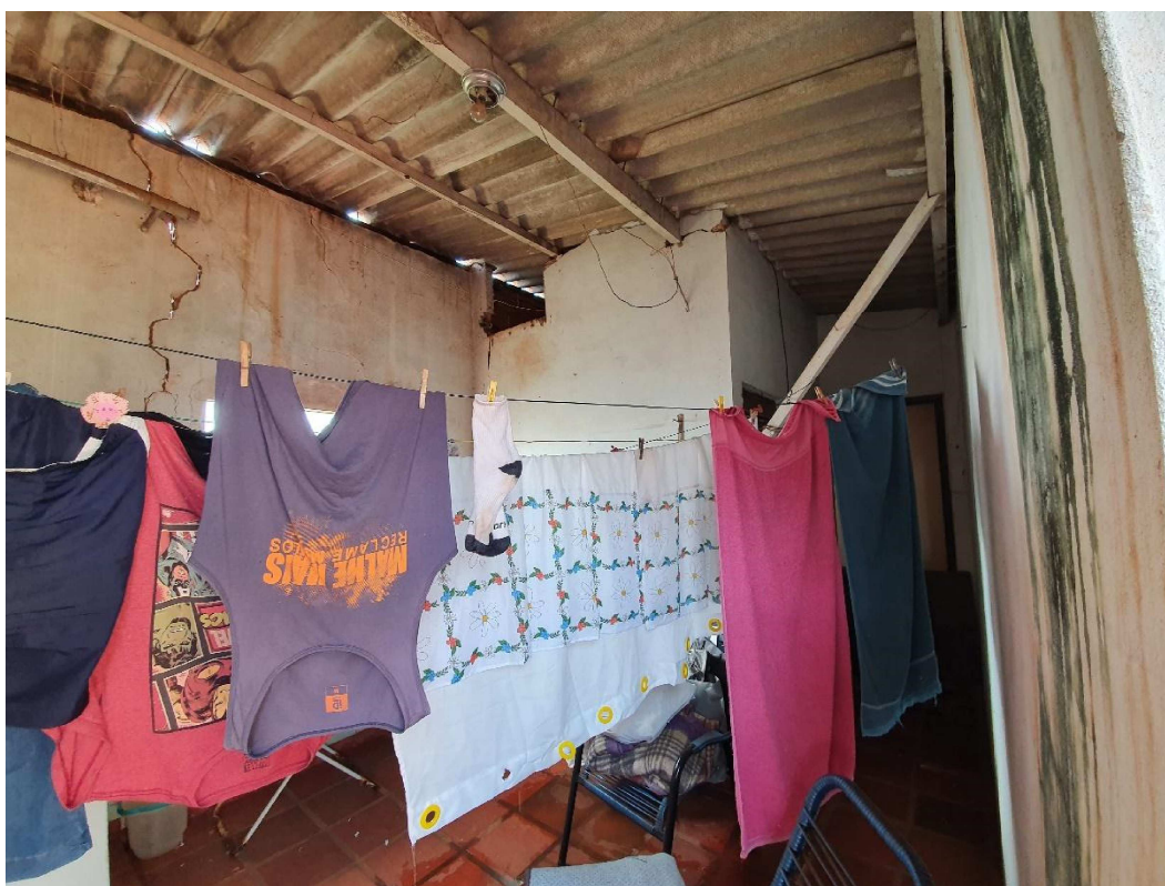
Foto 7 – Detalhe das rachaduras na lavanderia.
