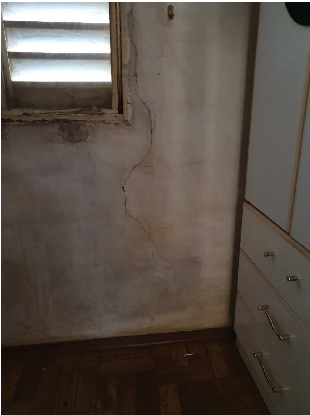
Foto 46 – Rachadura no lado direito da janela
