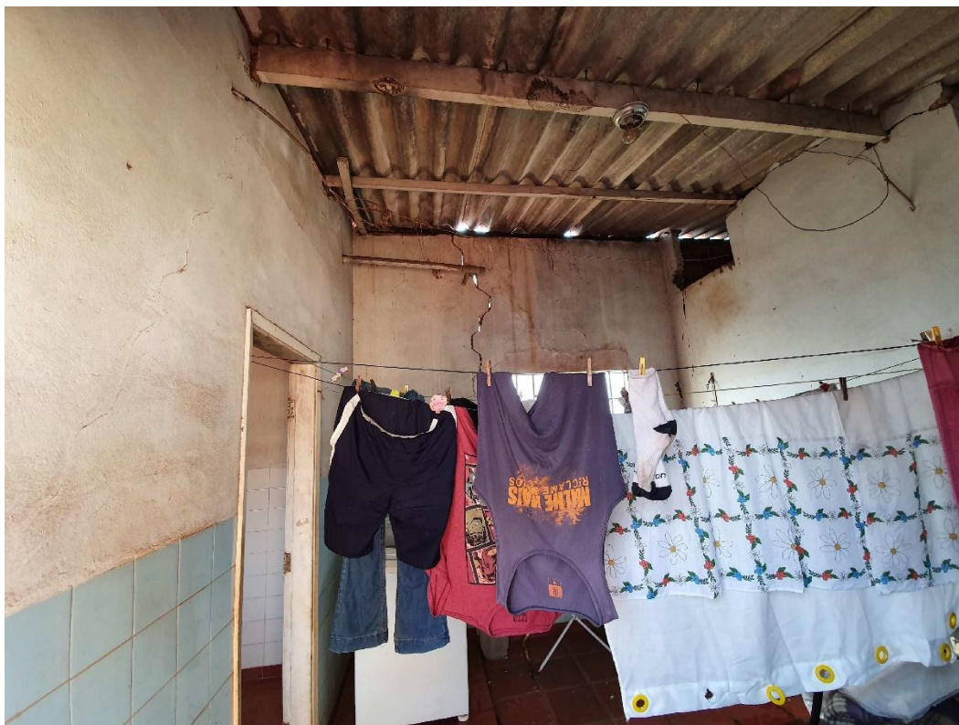
Foto 8 –Lavanderia, pode-se visualizar a rachadura com abertura da qual se visualiza o ambiente externo da casa.
