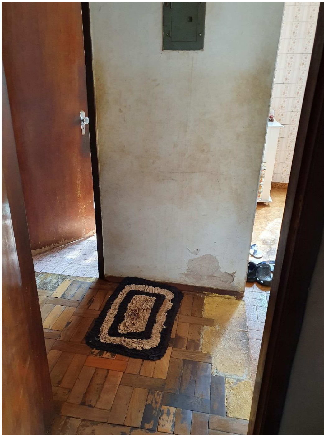
Foto 51 – Parede do corredor com várias trincas, perda de reboco e vários tacos do piso faltando e necessitando de manutenção (sinteco).
