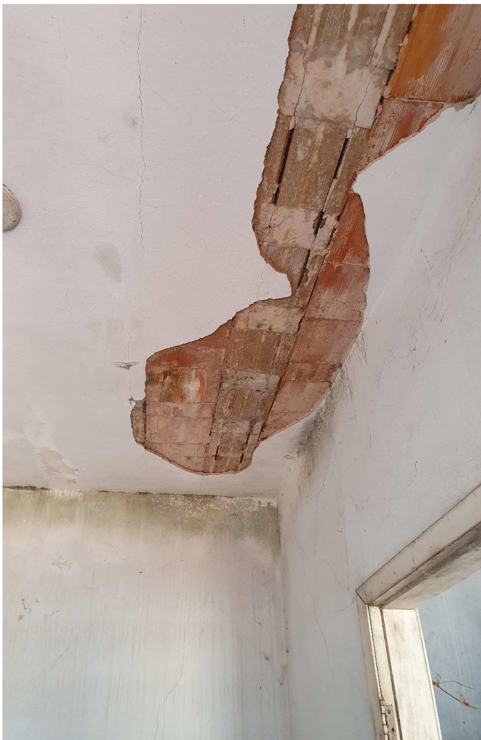
Foto 12 – Detalhe do reboco soltando da laje da cozinha e trinca de fora a fora.
