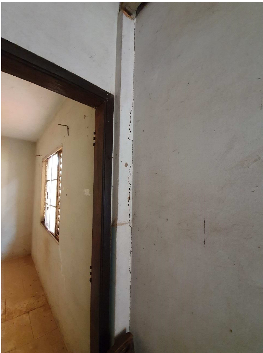
Foto 17 – Detalhes da rachadura na coluna do corredor de acesso ao quarto da edícula, junto ao batente da porta.
