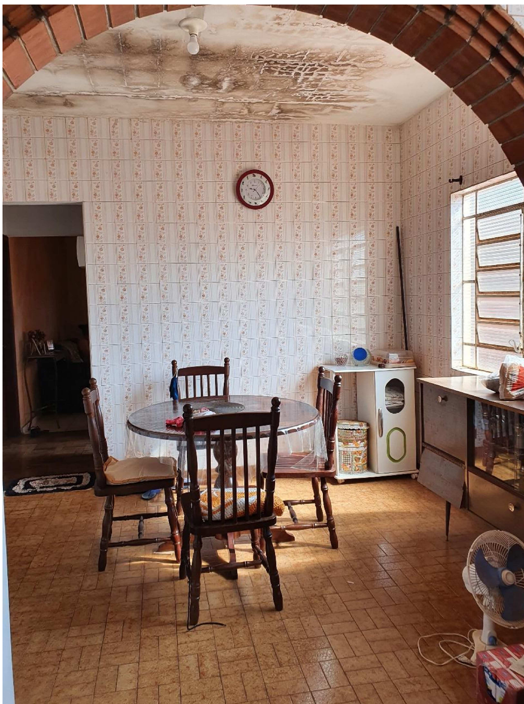
Foto 38 – Sala de Jantar, apresenta infiltração na laje.
