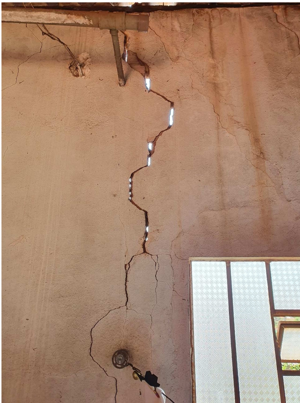
Foto 9 – Detalhe da rachadura da foto 8.
