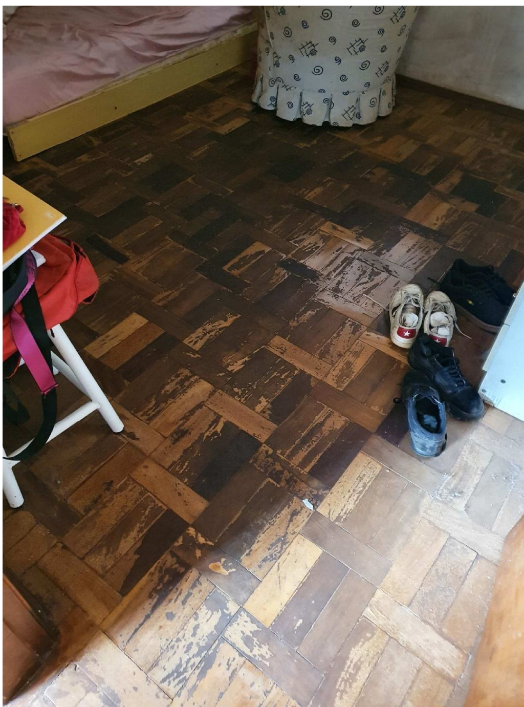
Foto 45 – Tacos do piso em péssimo estado, necessitando de manutenção.
