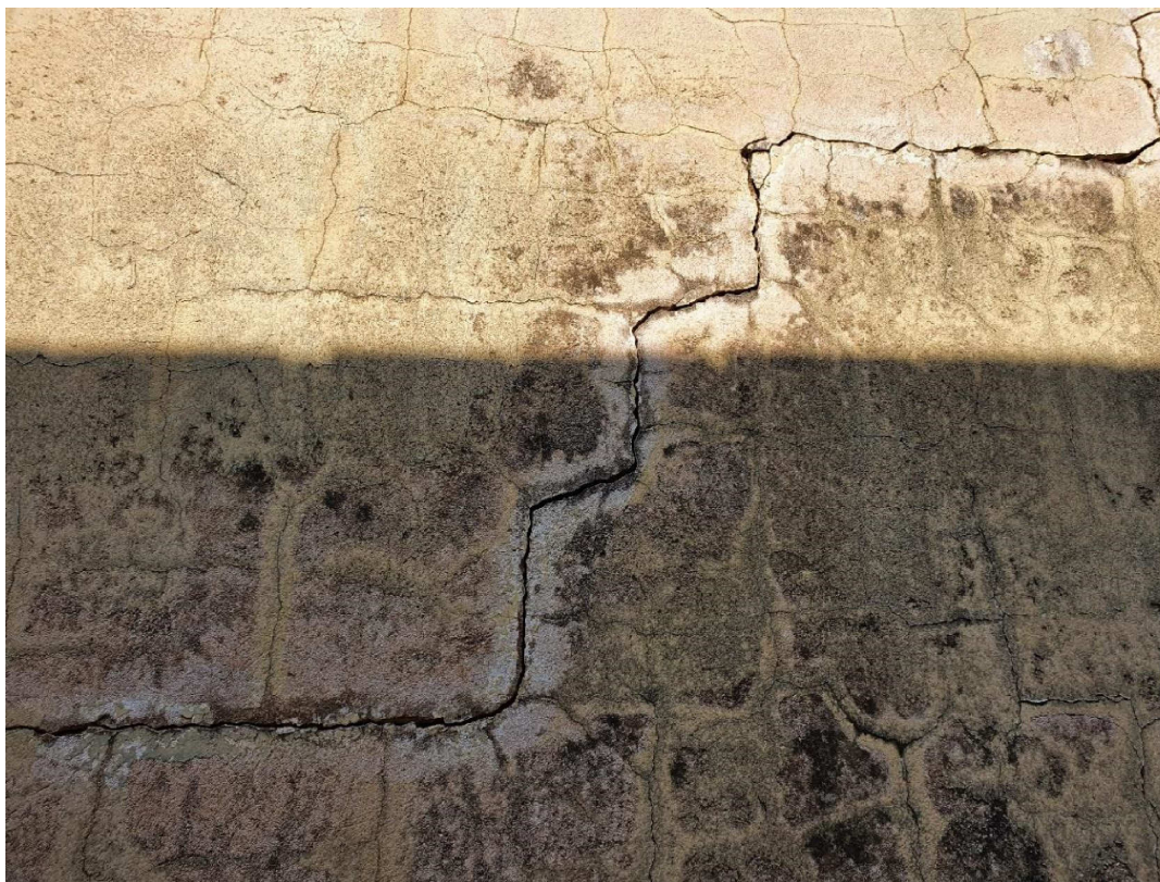
Foto 23 – Muro esquerdo pra quem fica de costas pra rua.
