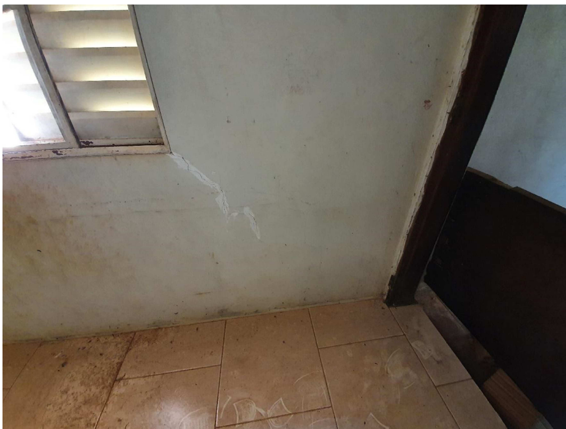
Foto 16 - Trincas em 45° no canto direito da janela do quarto.
