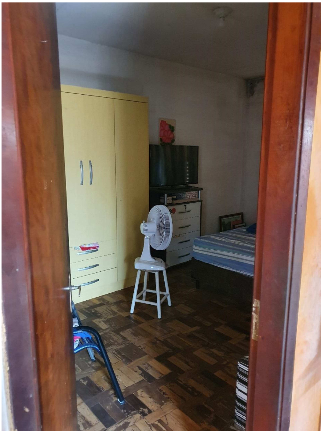
Foto 54 - Quarto I, necessitando de manutenção no piso de tacos (sinteco).
