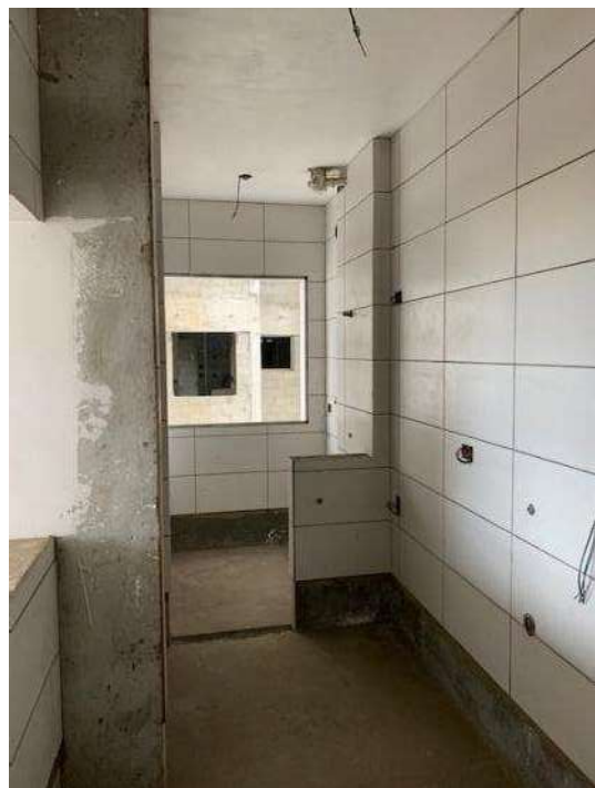
Foto 07. Vista da cozinha de um dos apartamentos da Torre 1. Vide aí que foi instalado revestimento cerâmico, executado contrapiso e passados eletrodutos e condutores da rede elétrica. Não foi instalada esquadria, e faltam detalhes de acabamento. Situação repete-se do 4º ao 12º pavimento.
