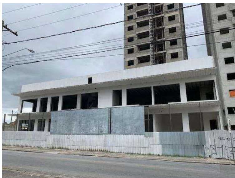
Foto 01. Vista da fachada do prédio comercial do empreendimento denominado "Condomínio Single Life Residence", situado com frente para a Avenida Gabriel Ortiz Monteiro. Vide aí que a edificação encontra-se inacabada.
