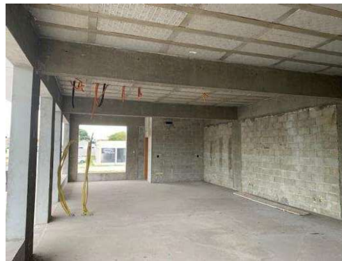
Foto 17. Vista de outra sala comercial, localizada no pavimento superior do bloco comercial. Vide aí, que faltam revestimentos, condutores da rede elétrica, e instalação de esquadrias.
