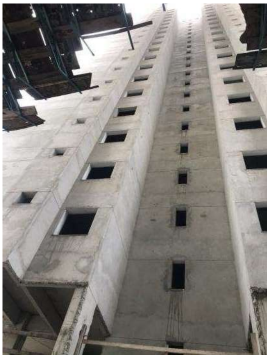
Foto 04. Vista do revestimento da fachada da Torre 1. Vide aí que encontra-se inacabado, sem pintura. Observe aí também, que não foram instaladas as esquadrias dos apartamentos.
