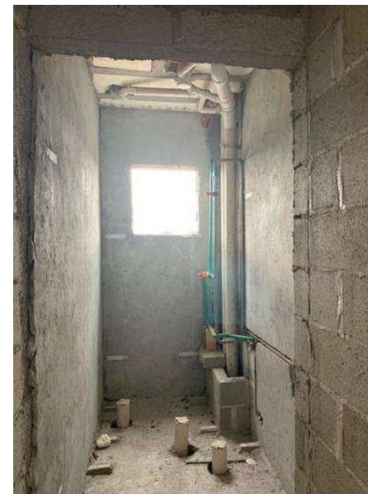
Foto 09. Vista de outro banheiro de um dos apartamentos da Torre 1. Vide aí as tubulações da rede hidrossanitária do shaft. Observe aí também, que faltam revestimento e instalação de esquadrias.
