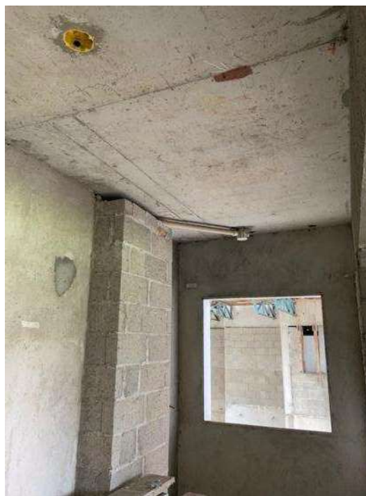
Foto 11. Vista de um dos banheiros da Torre 2. Vide aí, que Possui tubulação do sistema hidrossanitário instalada. Faltam acabamentos e instalação de esquadrias e rede elétrica. Situação se repete em todos os andares desta torre.
