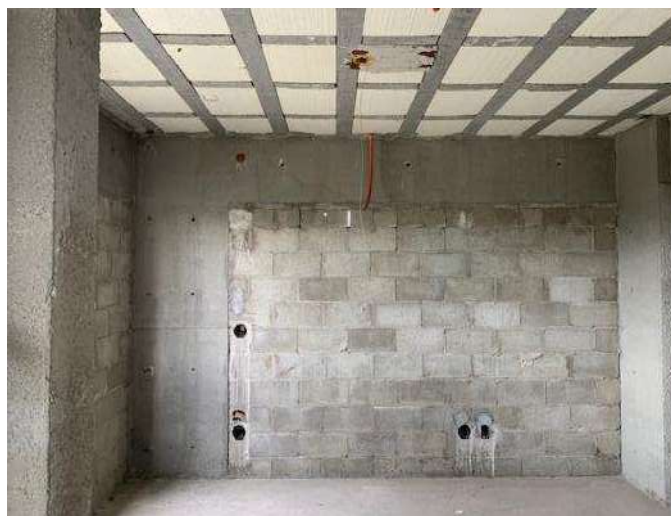
Foto 14. Vista de um dos dormitórios da Torre 2. Vide aí, que faltam acabamentos, bem como a passagem dos condutores de energia elétrica.
