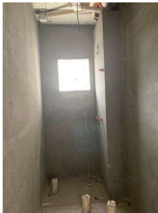
Foto 05. Vista do banheiro de um dos apartamentos da Torre 1. Vide aí que as tubulações hidráulicas foram instaladas. Não foi realizada instalação do revestimento cerâmico e esquadrias. Situação repete-se do 4º ao 12º pavimento.
