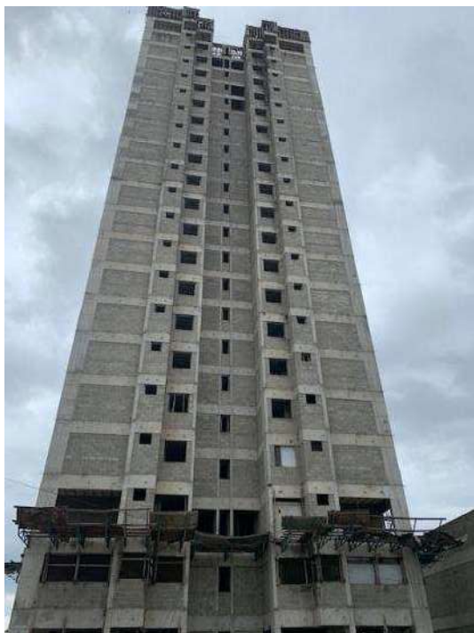
Foto 10. Vista da fachada da Torre 2. Vide aí que encontra-se inacabada, na qual faltam construir os andares 20º andar, cobertura e ático.
