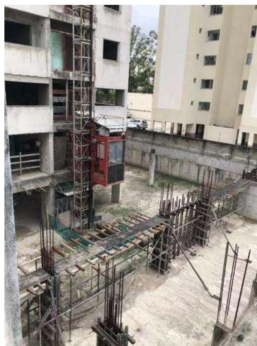
Foto 03. Vista do local em que seria construída a portaria do empreendimento em tela. Vide aí a armação de pilares, que não foram concretados.
