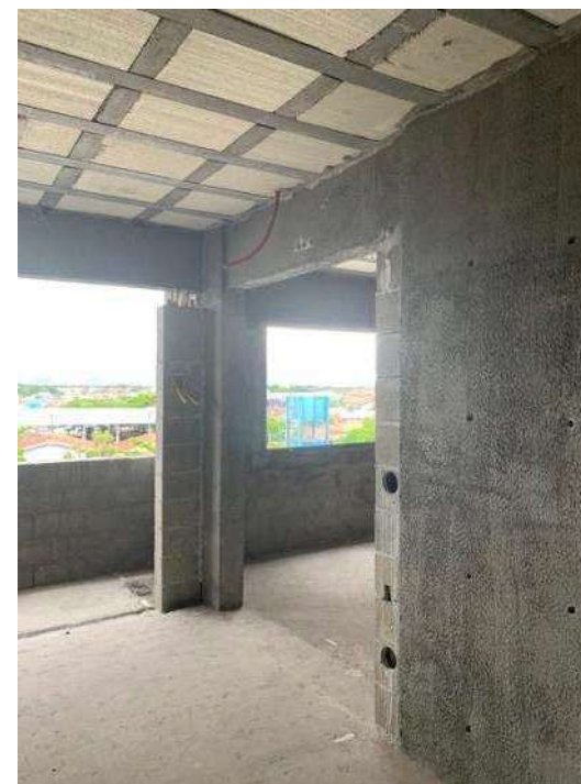
Foto 12. Vista da sala de um dos apartamentos da Torre 2. Vide aí, que faltam acabamentos e instalação de esquadrias.
