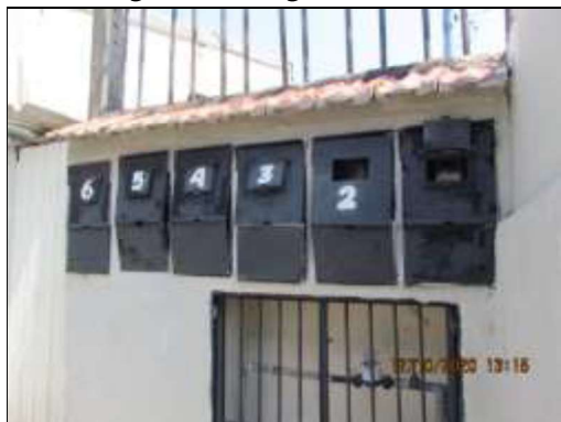
Relógio de energia das unidades
