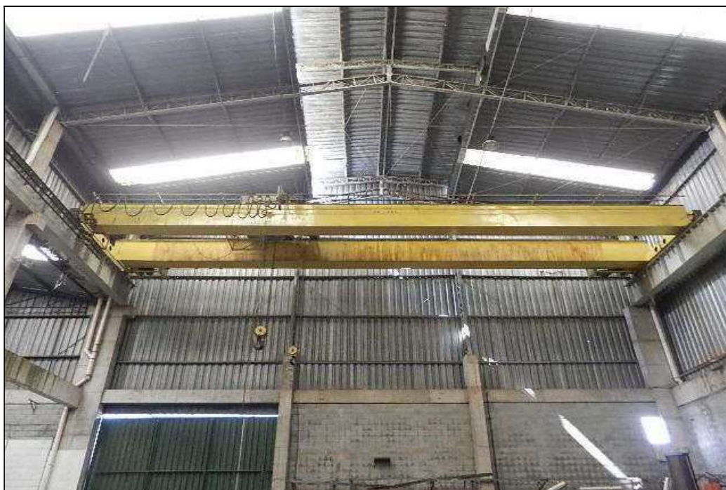
3,008 – VISTA DA PONTE ROLANTE CAP: 20 TON COM AUXILIAR DE 7 TON
