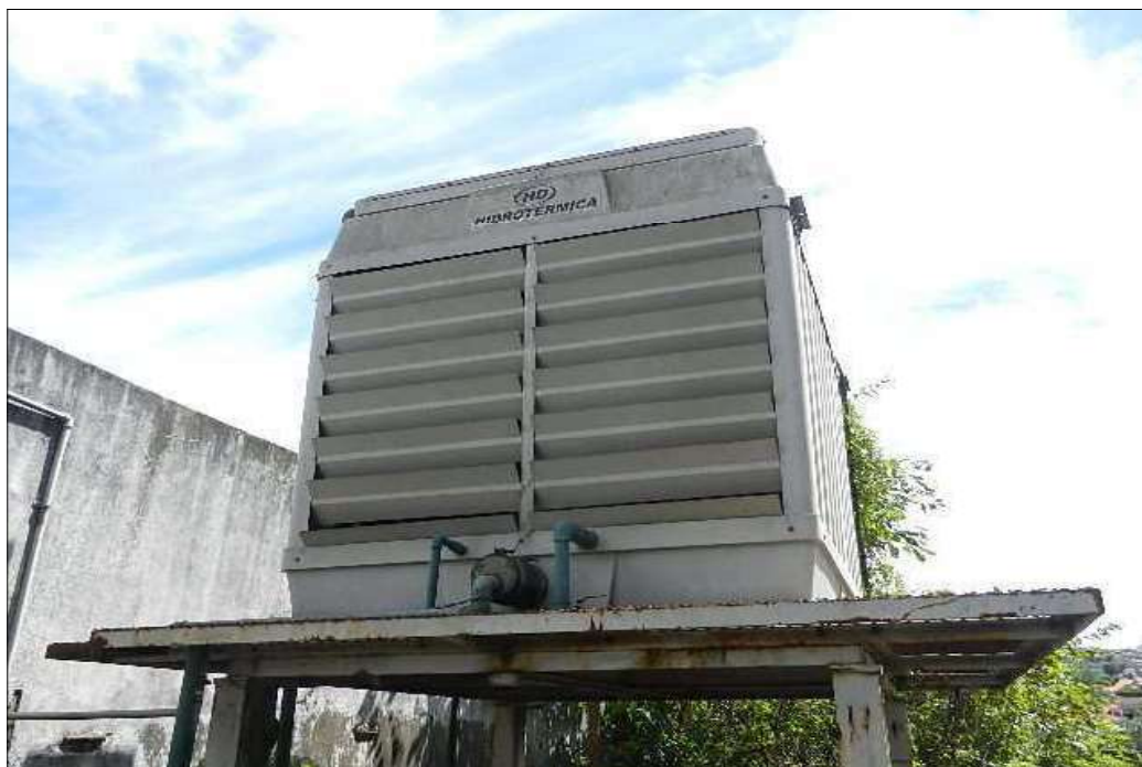
1.009 – VISTA DA TORRE DE RESFRIAMENTO MARCA: HIDROTERMICA
