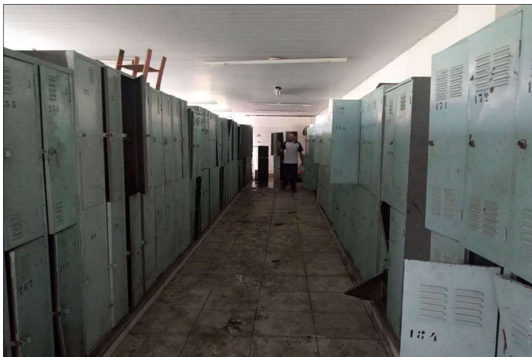
VISTA DOS ARMARIOS DIVERSOS
