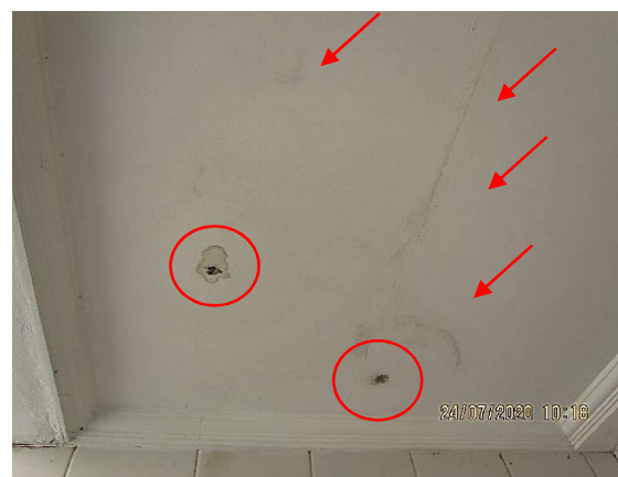
Furos no teto de gesso em depósito no quintal com manchas de infiltração
