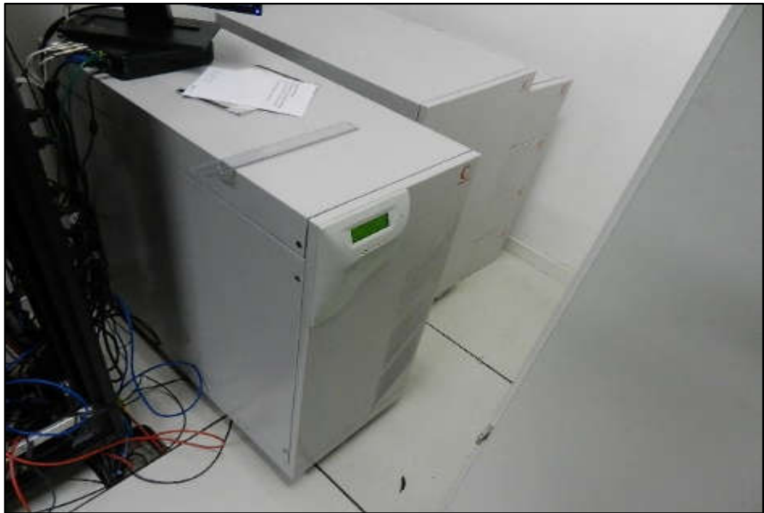
ITENS 0038/0040 - BANCO DE BATERIA 3 MÓDULOS ENGETRON GEX-DW-408, BANCO DE BATERIA 3 MÓDULOS ENGETRON GEX-DW-9S E NOBREAK ENGETRON DWTM15-E23E
