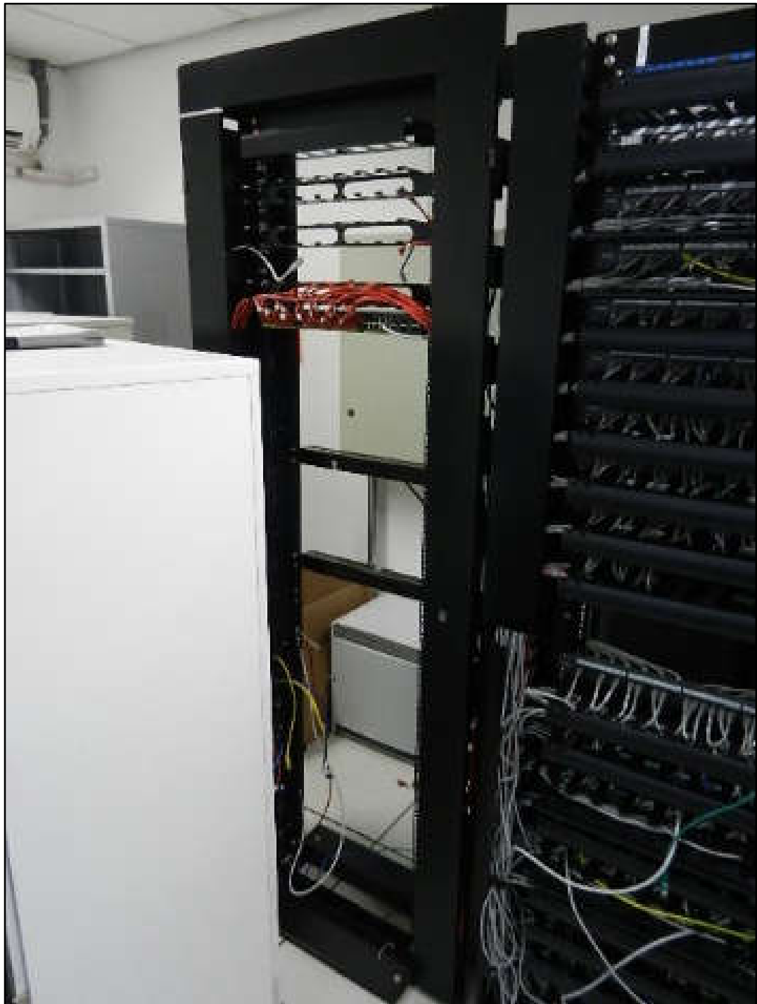
ITEM 0066 - RACK ALTO METÁLICO COM 2 FILTROS DE LINHA MEKANIKA
