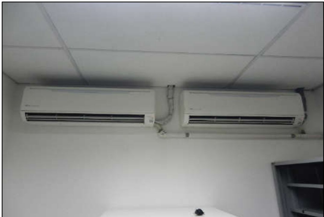
ITEM 0037 - AR CONDICIONADO SPLIT FUJITSU INVERTER ASBA30LFC
