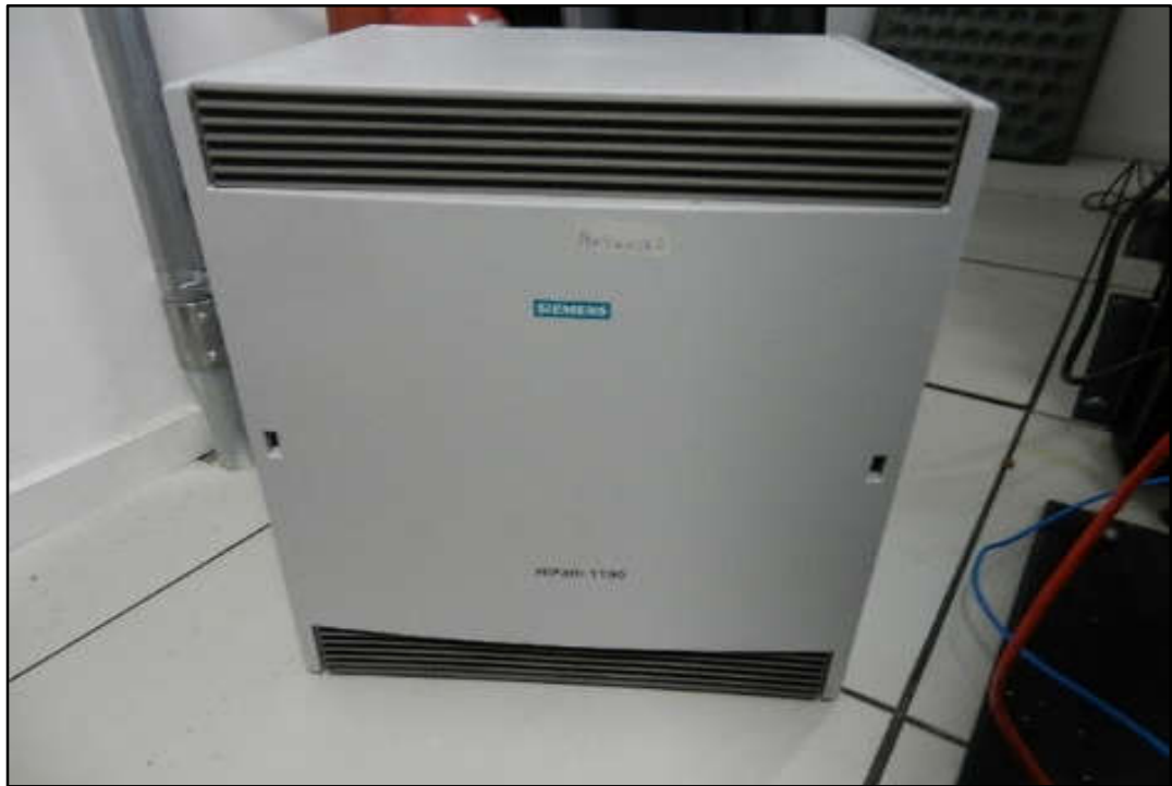
ITEM 0075 – PABX HIPATH SIEMENS 1190
