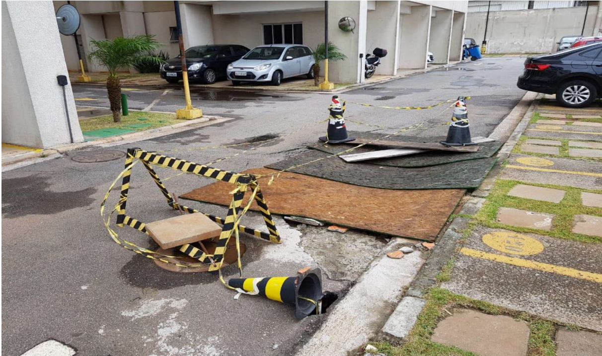
Foto 57 – Via de acesso ao estacionamento térreo apresentando solapamento
