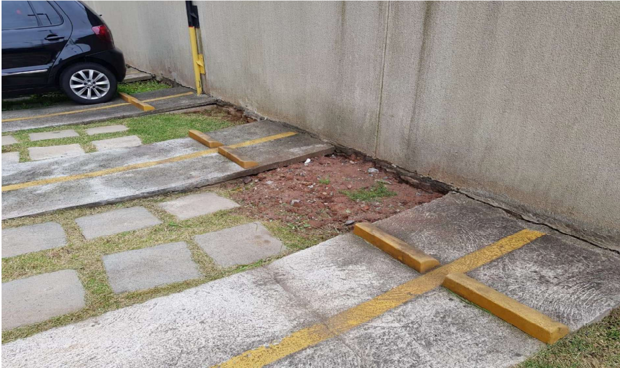
Foto 53 – Vagas de estacionamento de veículos – anomalias (solapamento)
