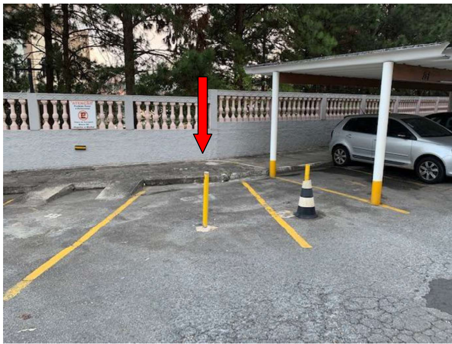
FOTO N. 08 : Vaga de garagem pertencente a unidade avalianda que não possui cobertura.
