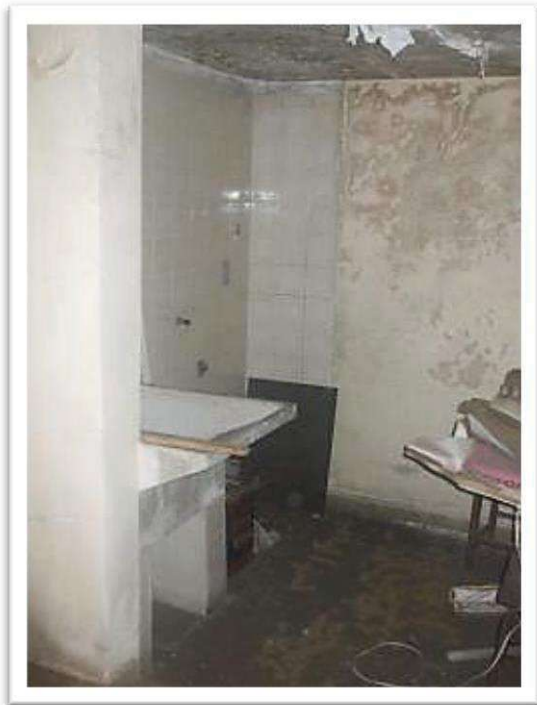
Foto 8: Vista da área de serviço no andar superior. Nota-se ao fundo pontos de umidade e bolor.
