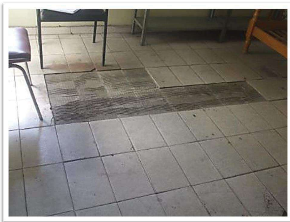
Foto 18: Vista parcial do piso solto no cômodo da frente no andar superior.
