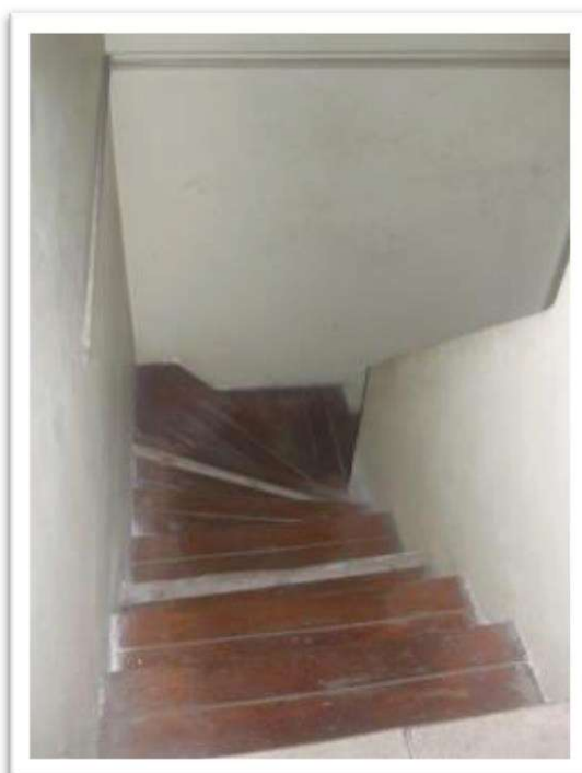
Foto 4: Vista da escada interna para acesso ao andar superior. O piso de madeira apresenta cupim e está solto em algumas partes.
