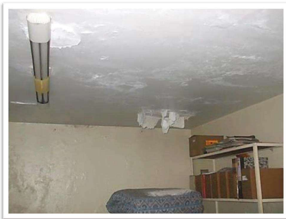
Foto 22: Nota-se que as paredes e laje possuem infiltrações.
