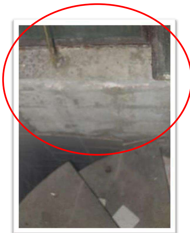
Foto 18: Outro trecho da parede na região da escada caracol onde parte do azulejo caiu.
