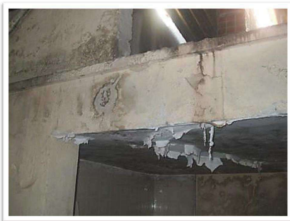
Foto 21: Vista da infiltração de água na estrutura nos fundos no andar superior.
