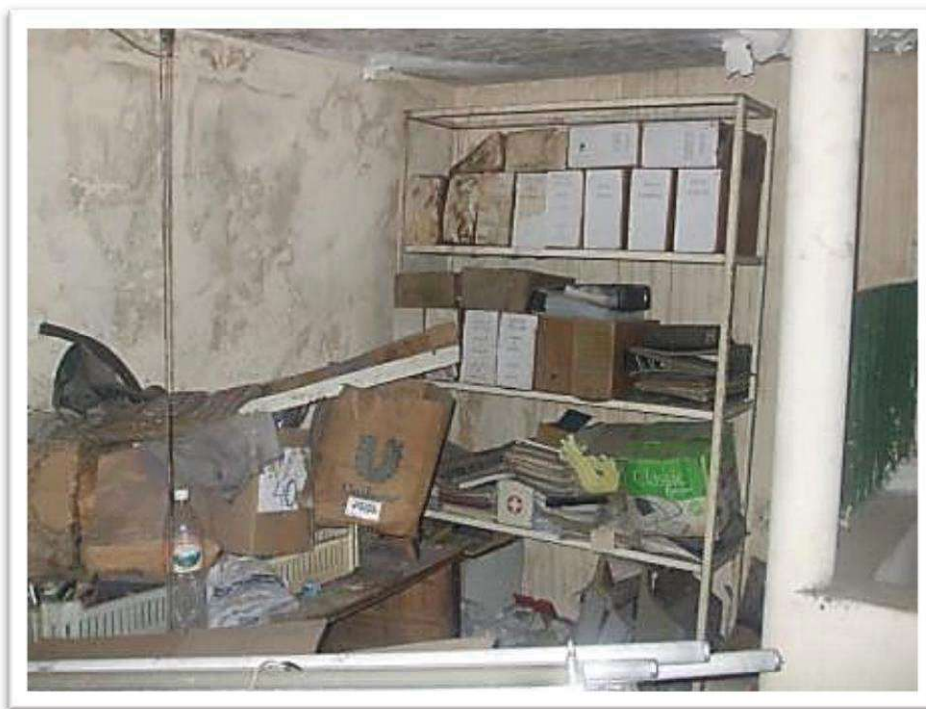
Foto 9: Vista parcial do cômodo no andar superior nos fundos. Nota-se aos fundos pontos de umidade e bolor.
