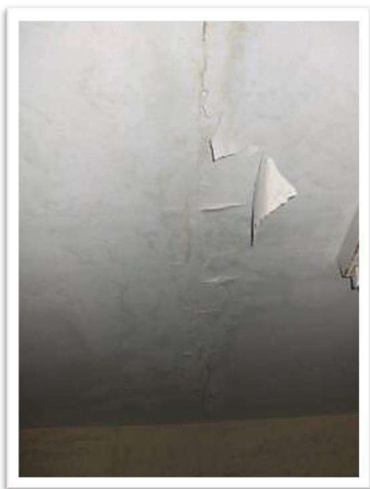
Foto 20: Vista da trinca na laje do cômodo superior nos fundos.
