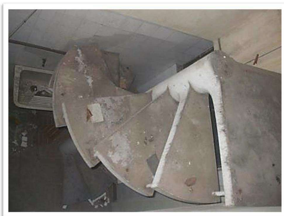
Foto 16: Vista do tanque sob a escada caracol que liga os andares térreo e superior nos fundos.
