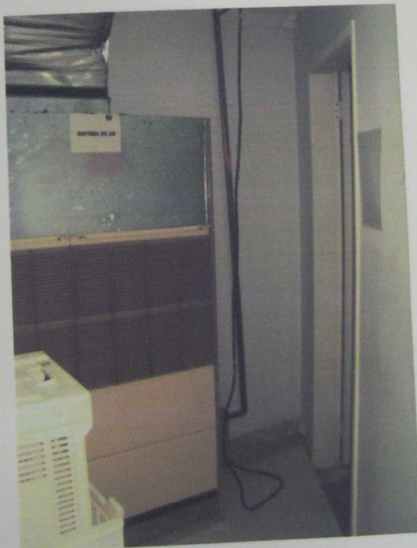
VISTA DA SALA ONDE ESTÁ INSTALADA A ESTAÇÃO DE EFLUENTES.
