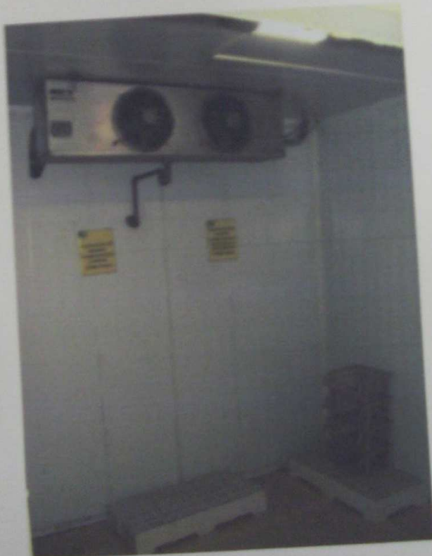
VISTA DA CÂMARA FRIA.
