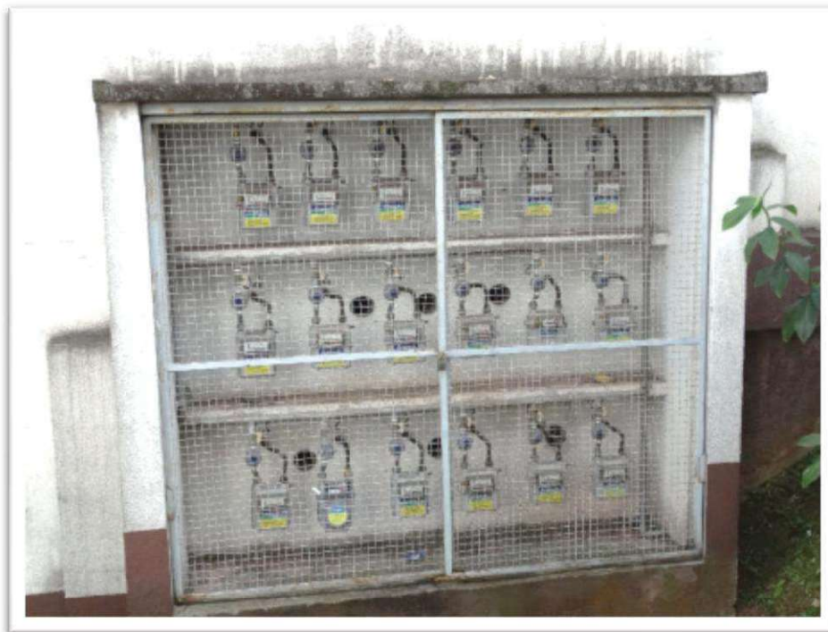
Foto nº 40 - Vista dos medidores de entrada de energia elétrica no Edifício Parpan, cujo apartamento de nº 13 é objeto da presente vistoria.
