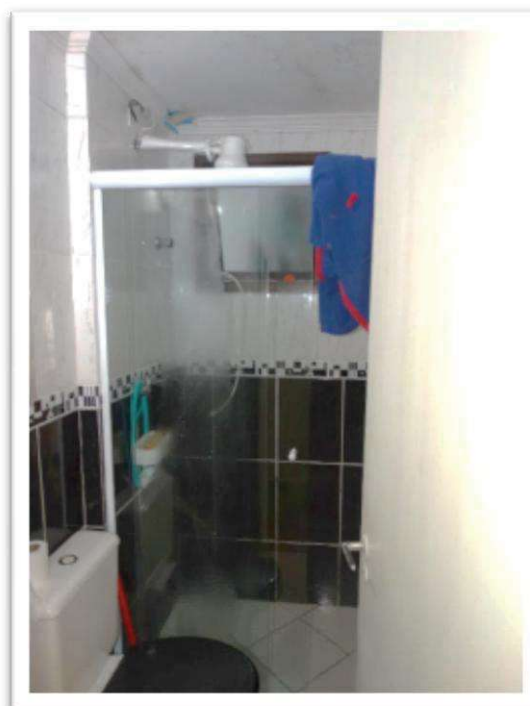
Foto nº 23 - Vista parcial interna do apartamento nº 13 do Edifício Parpan – Banheiro Social.
