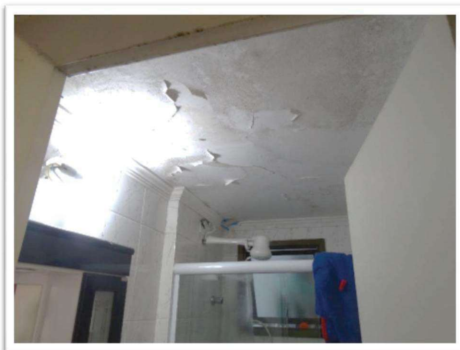
Foto nº 24 - Outra vista parcial do Banheiro Social. Em destaque as falhas no revestimento do teto.
