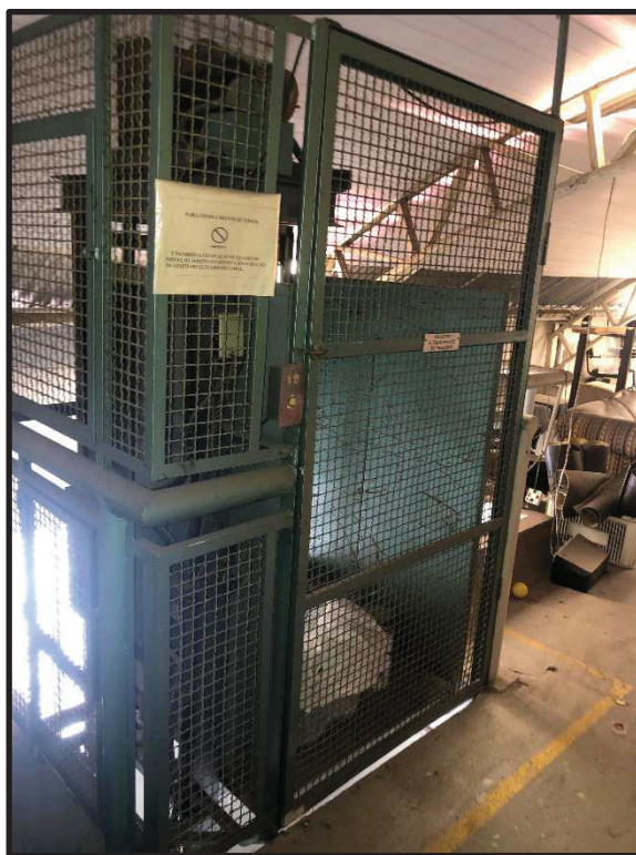
Foto 27 – 2º Pavimento – Elevador de carga
