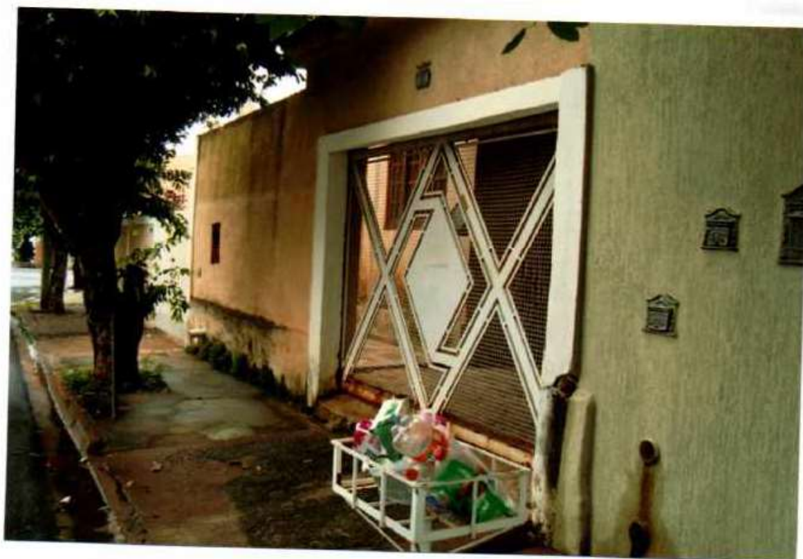
Vista parcial do muro da frente do imóvel e portão de acesso à garagem para um só veículo.
