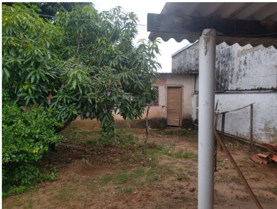
FOTO 03 – Mostrando o quintal e no fundo a edícula em péssimo estado de conservação.
