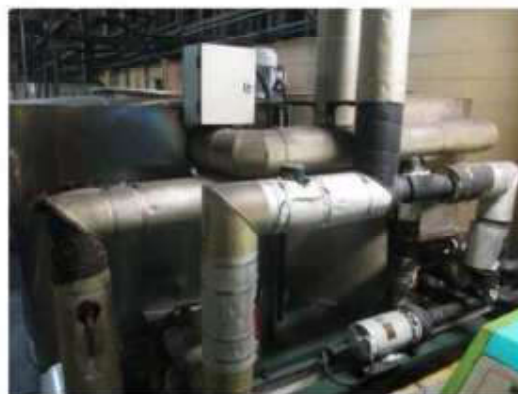
Vista geral da unidade de resfriamento.
