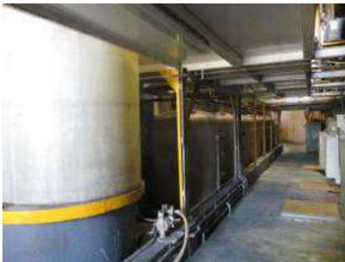
Vista da Estação de Tratamento de Efluentes (ETE)
