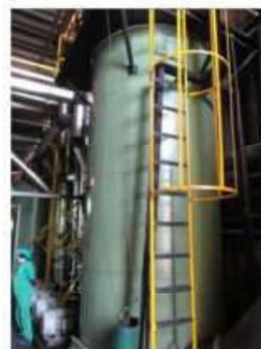
Vista do aquecedor de fluido térmico.
