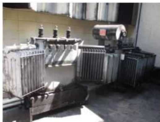
Vista do transformador trifásico.
