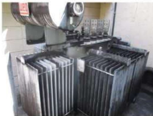
Vista do transformador trifásico.
