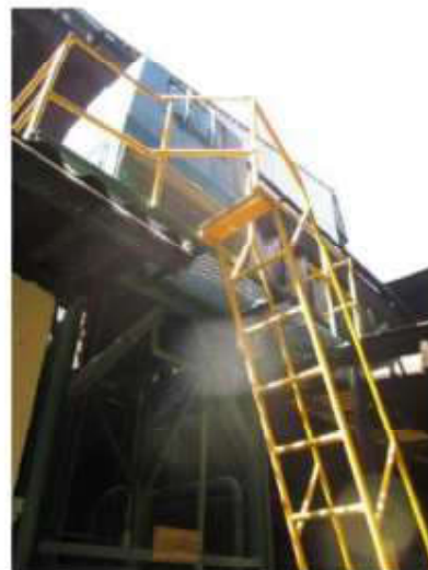
Vista da unidade de refrigeração 2.
