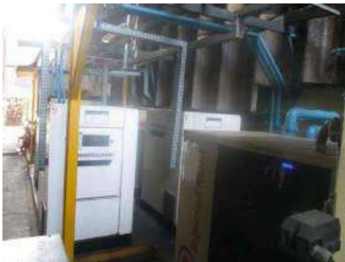
Vista da Área dos Compressores
