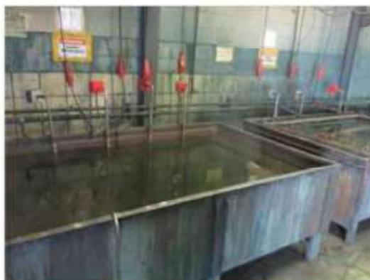
Vista do tanque metálico.
