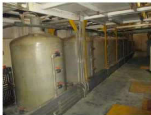
Vista dos tanques metálicos 3000 L.
