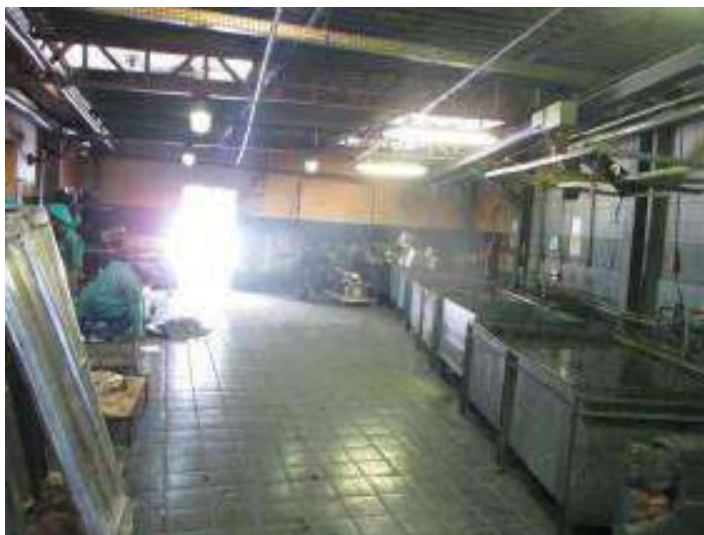
Vista geral do Setor de Galvanoplastia.
