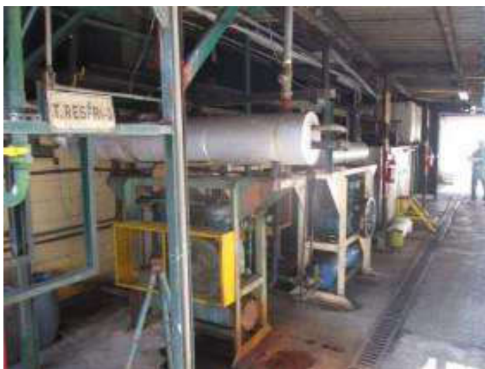
Vista da Área de Refrigeração
