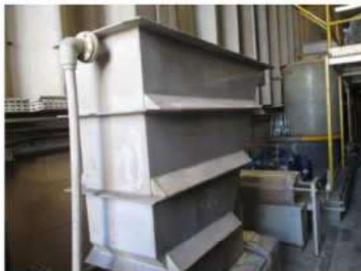
Vista do tanque metálico de adensamento, fabricação própria.
