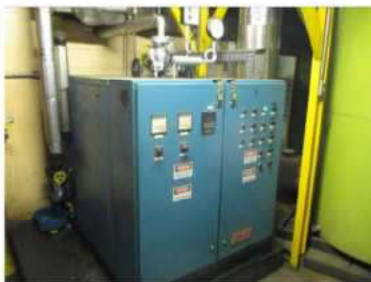
Vista da caldeira elétrica a vapor.
