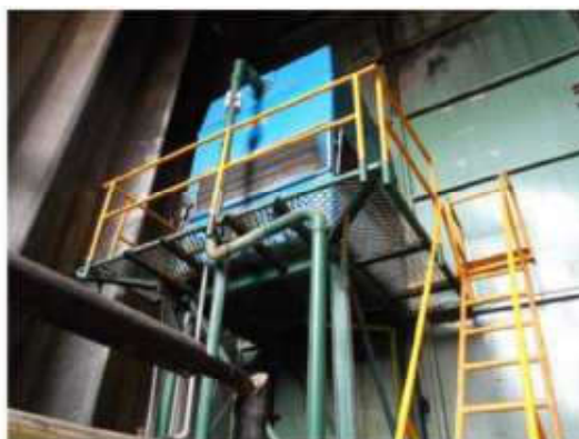
Vista da unidade de refrigeração 3.
