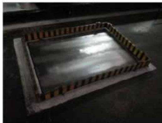
Vista da balança de piso.
