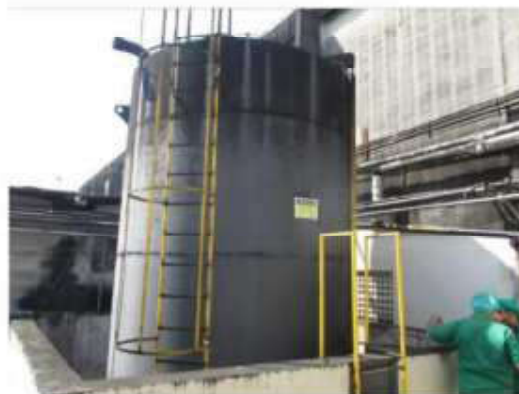
Vista do tanque metálico para óleo Diesel.
