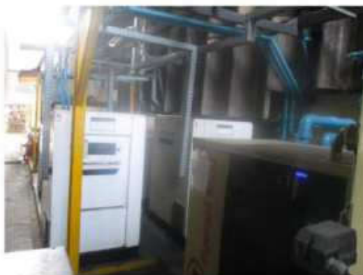
Vista geral do condensador Ingersoll.
