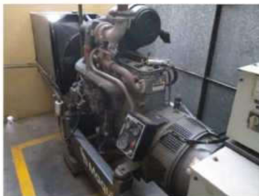
Vista do motor gerador ETE.
