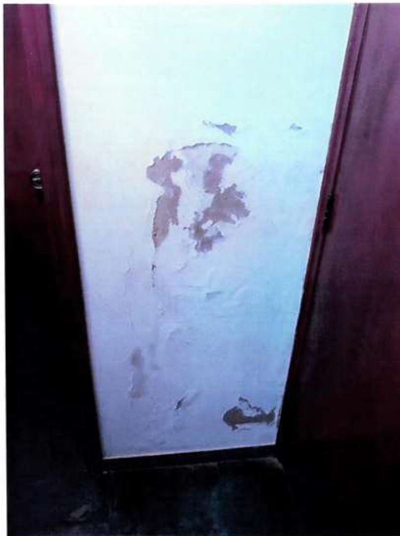
Foto 42 – Detalhe de umidade na parede (inferior)
