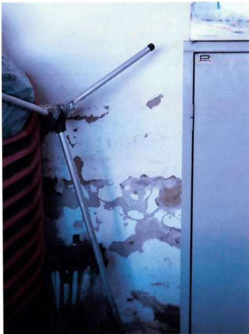
Foto 58 – Detalhe de umidade na parede (inferior)
