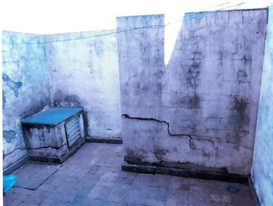
Foto 46 – Vista da área externa nos fundos, detalhe de trinca na parede (inferior)
