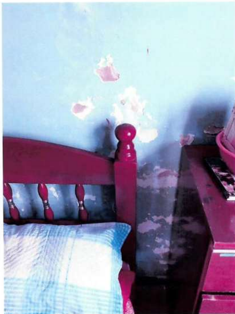
Foto 26 – Detalhe de umidade na parede do dormitório (2º superior)
