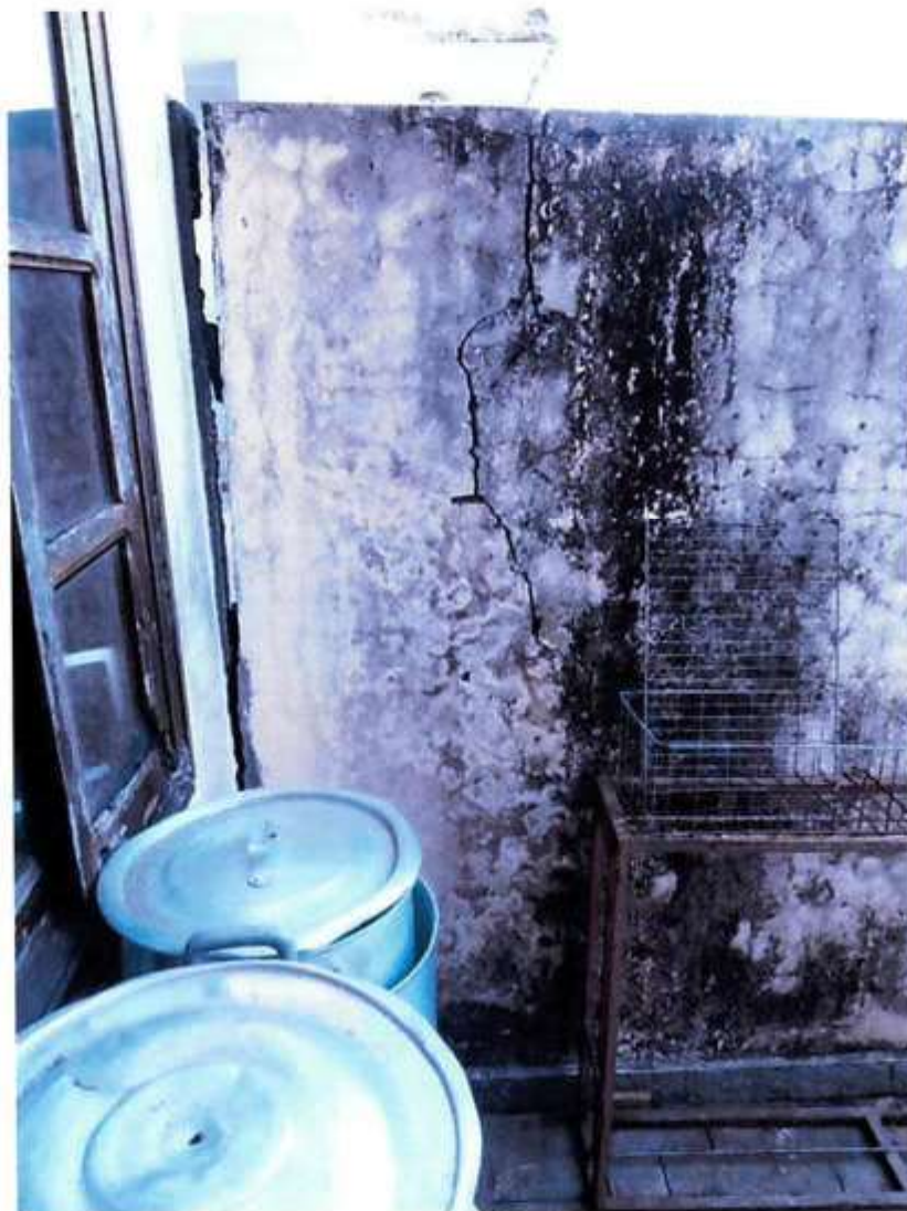
Foto 48 – Detalhe de anomalia entre a parede e o muro (inferior)
