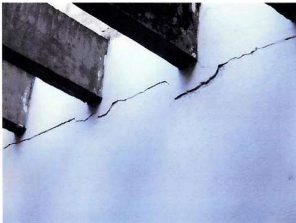
Foto 13 – Detalhe de trinca na parede do jardim de inverno (térreo)
