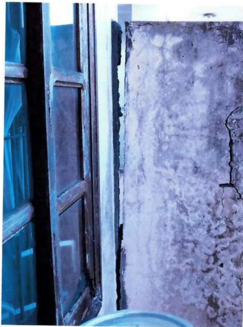
Foto 47 – Detalhe de anomalia entre a parede e o muro (inferior)
