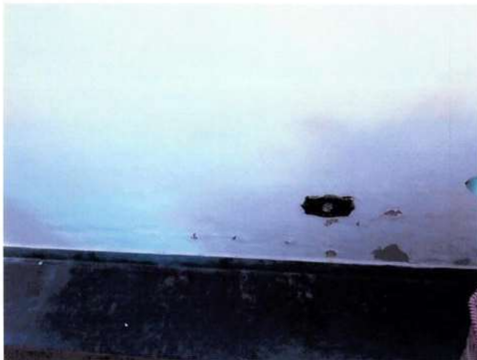
Foto 10 – Detalhe de umidade na parede da sala de jantar (térreo)
