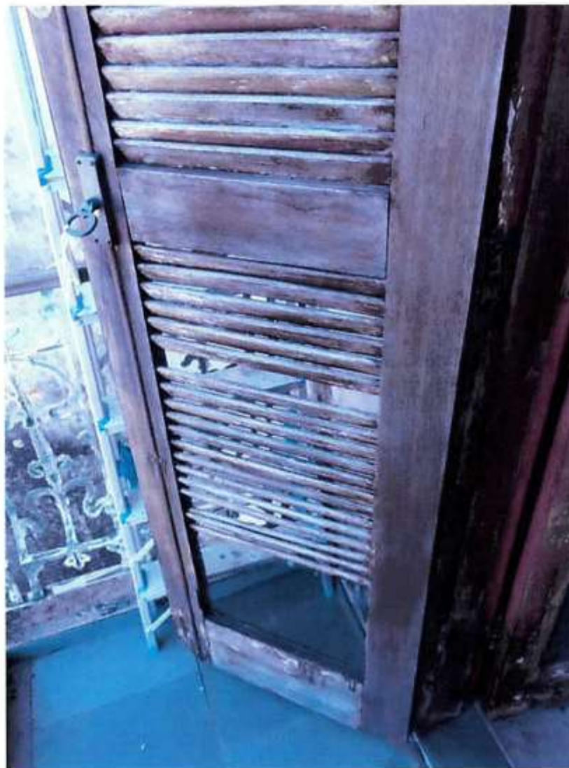
Foto 19 – Detalhe da porta em madeira da sacada danificada (1º superior)
