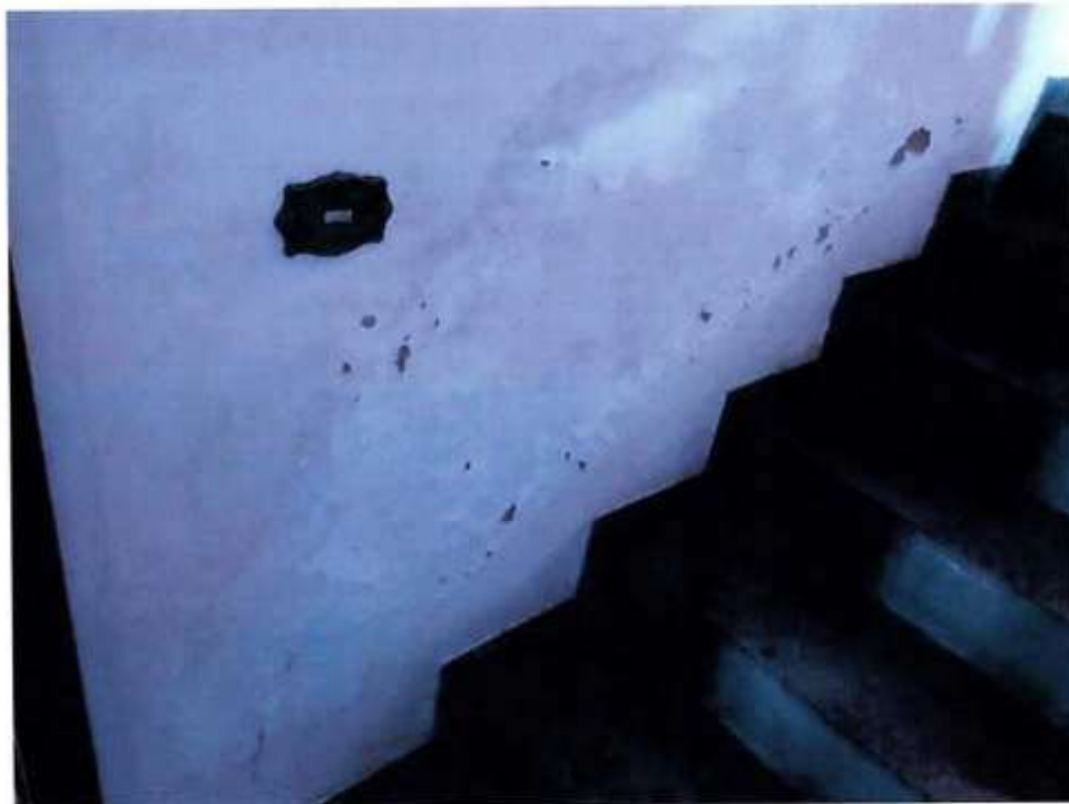
Foto 43 – Detalhe de umidade na parede (inferior)
