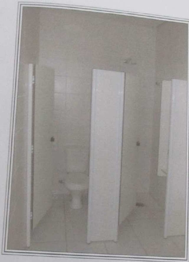
FOTO 26: Vista parcial dos banheiros da área em que se situam as saunas do Condomínio Forte do Golf.
