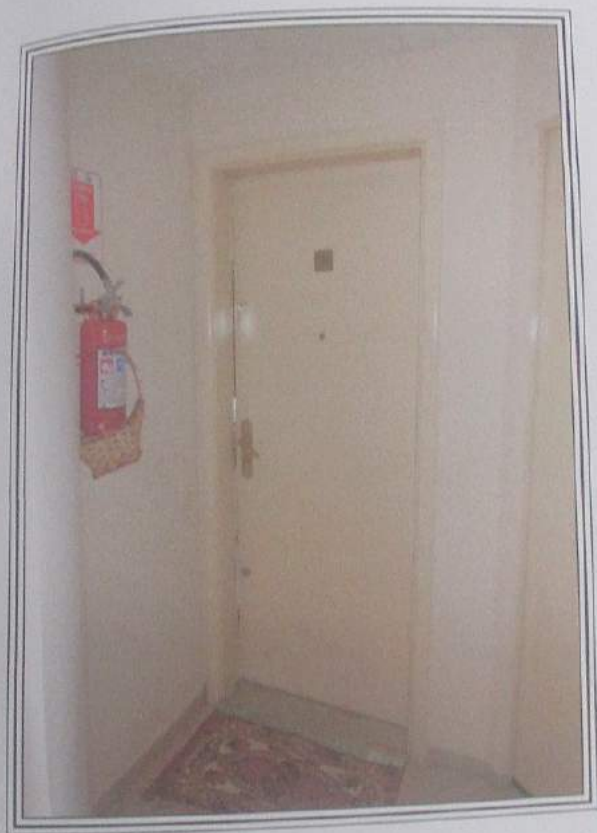
FOTO 70 : Vista parcial da porta de serviço de acesso à unidade avalianda, nº 51, situado no Edifício Spoleto, Bloco 4.
