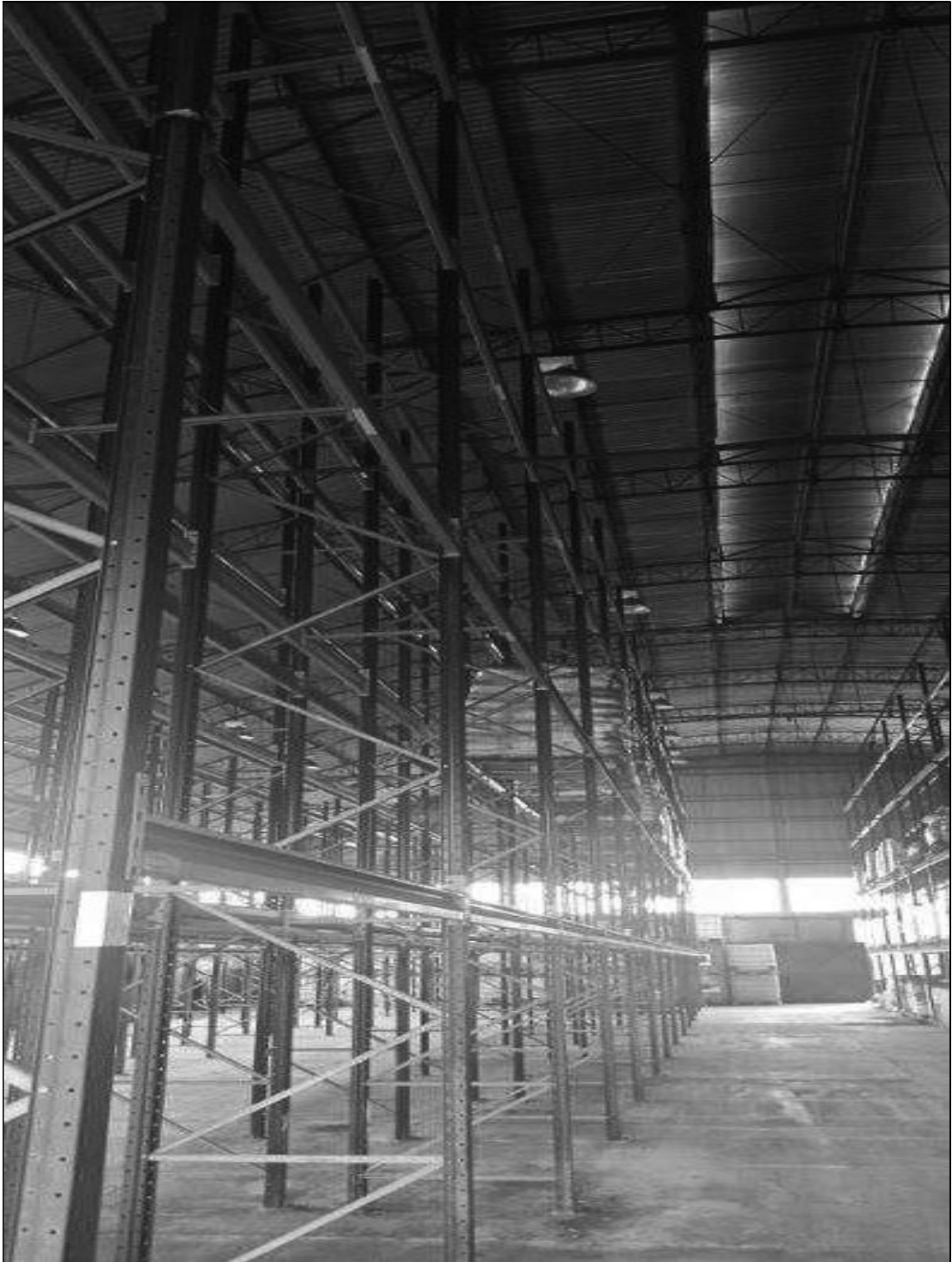
ITEM 1,014 – VISTA DA ESTANTE PORTA PALLETS, 52 PRATELEIRAS, 14 COLUNAS
