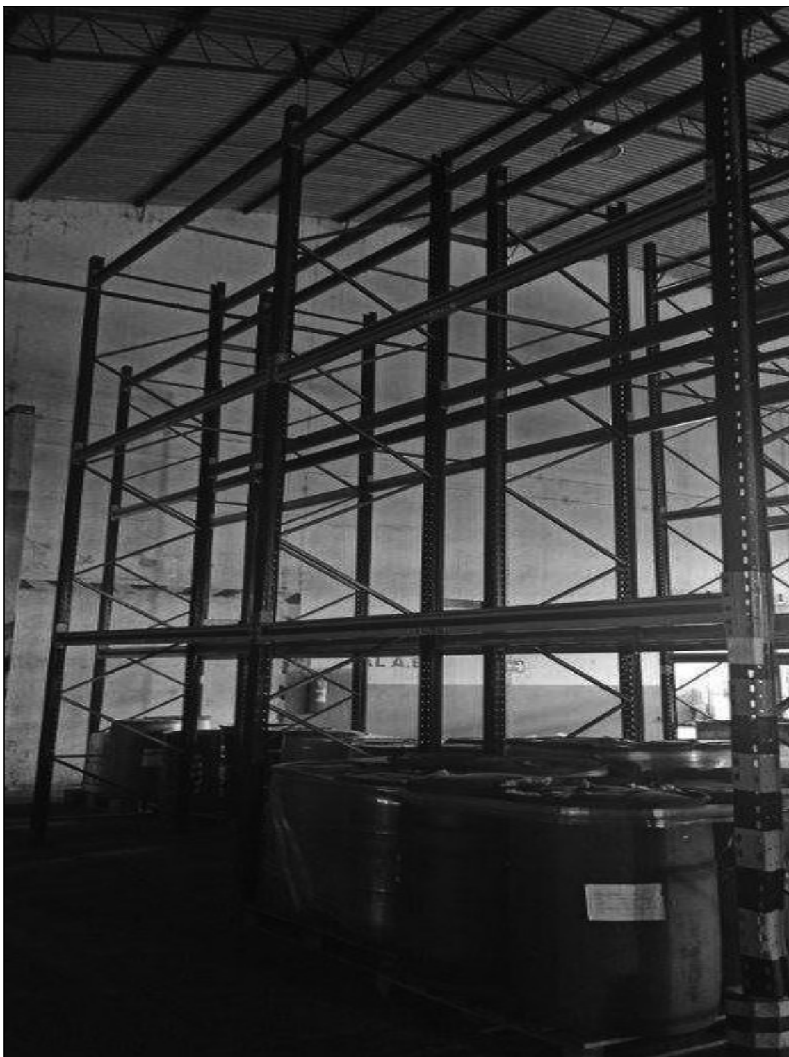
ITEM 1,019 – VISTA DA ESTANTE PORTA PALLETS, 30 PRATELEIRAS, 13 COLUNAS
