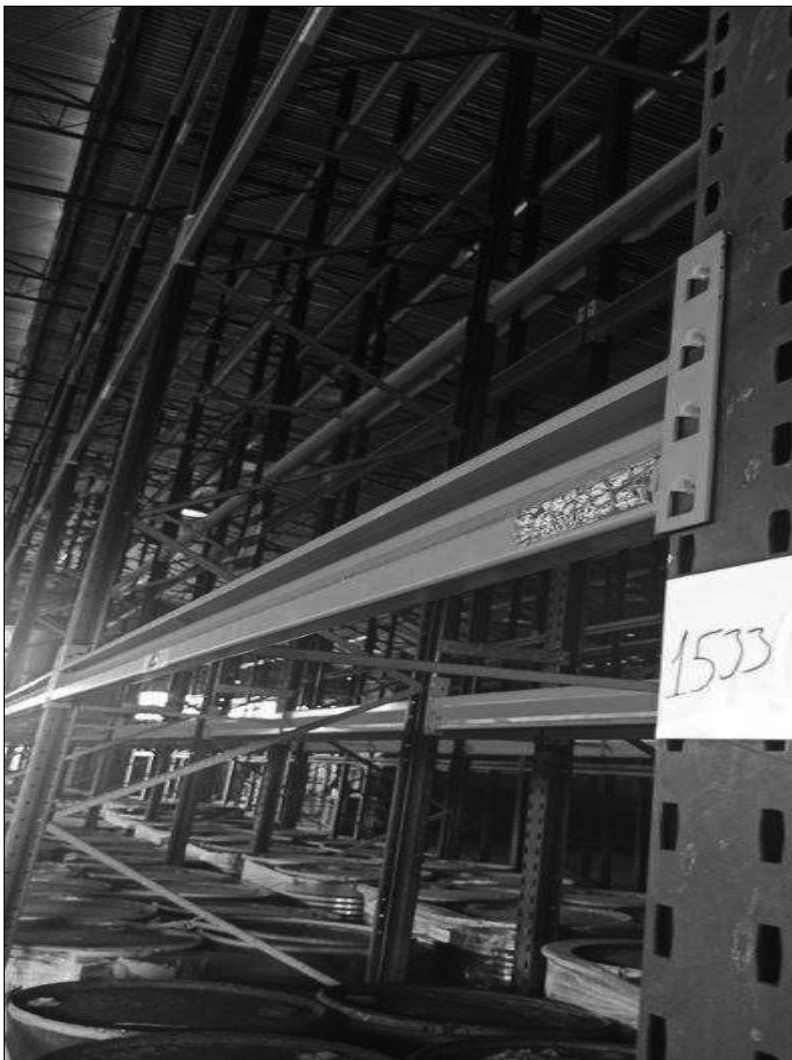
ITEM 1,016 – VISTA DA ESTANTE PORTA PALLETS, 52 PRATELEIRAS, 14 COLUNAS
