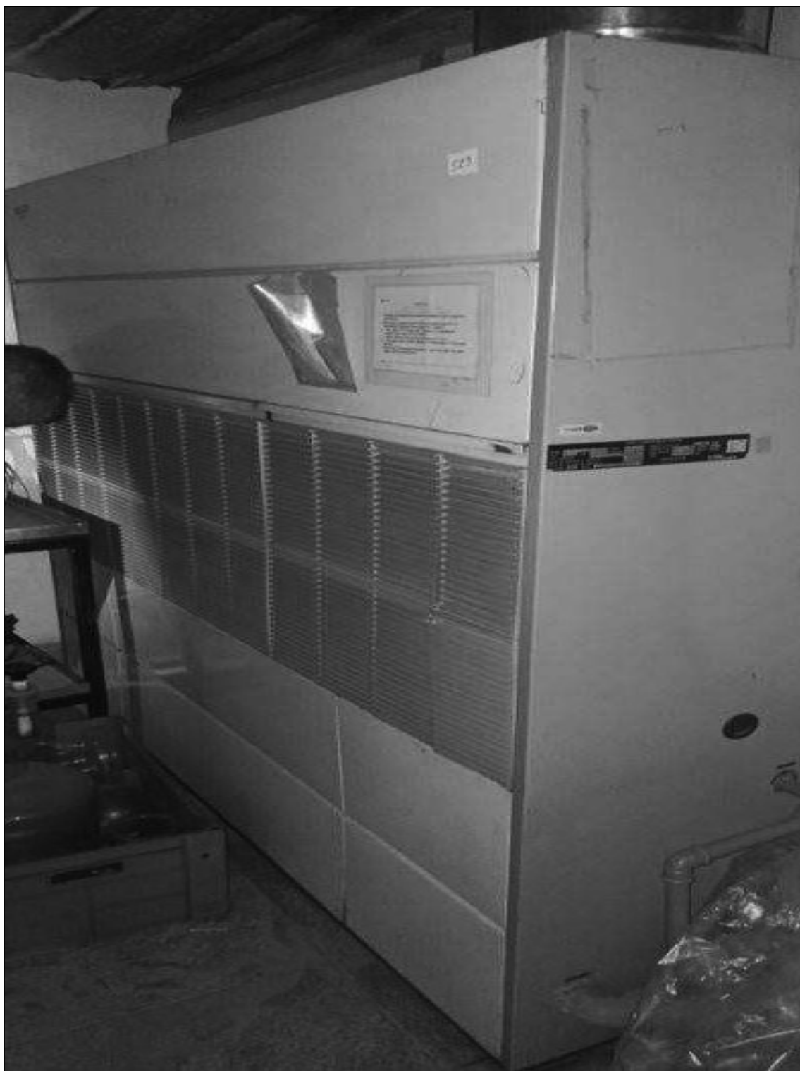
ITEM 1,167 – VISTA DA CENTRAL DE AR-CONDICIONADO, FAB. HITACHI, MOD. RP1516AV, DIM. 1860X720X1780 MM, N. SERIE 94157
