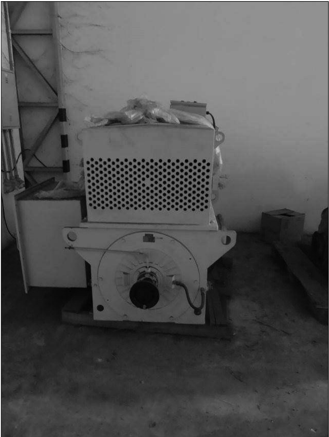
ITEM 1,043 – VISTA DO MOTOR DE INDUCAO TRIFASICO, FAB. WEG, 250 CV / 3500 RPM (EQUIPAMENTO NAO INSTALADO)
