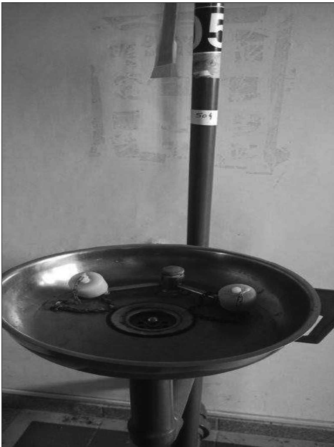
ITEM 1,156 – VISTA DO CHUVEIRO DE EMERGENCIA, COM LAVA OLHOS
