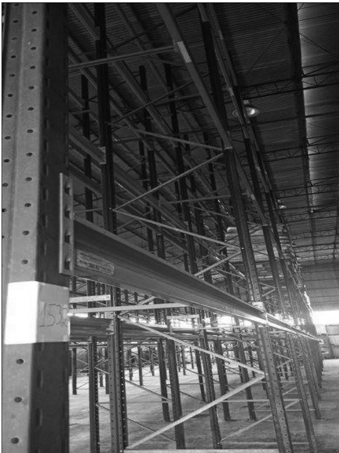
ITEM 1,015 – VISTA DA ESTANTE PORTA PALLETS, 52 PRATELEIRAS, 14 COLUNAS
