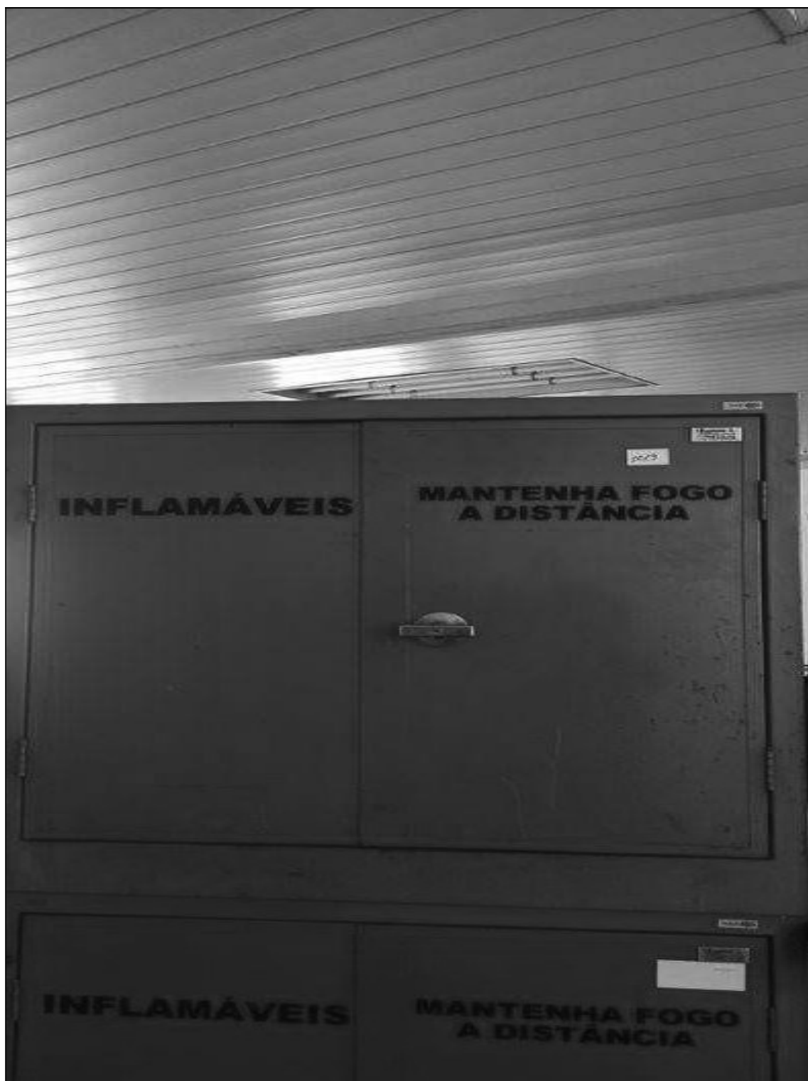
ITEM 1,180 – VISTA DO ARMARIO CORTA FOGO, EM ACO, 2 PORTAS, DIM. 1,00 X 0,50 X 1,00 M
