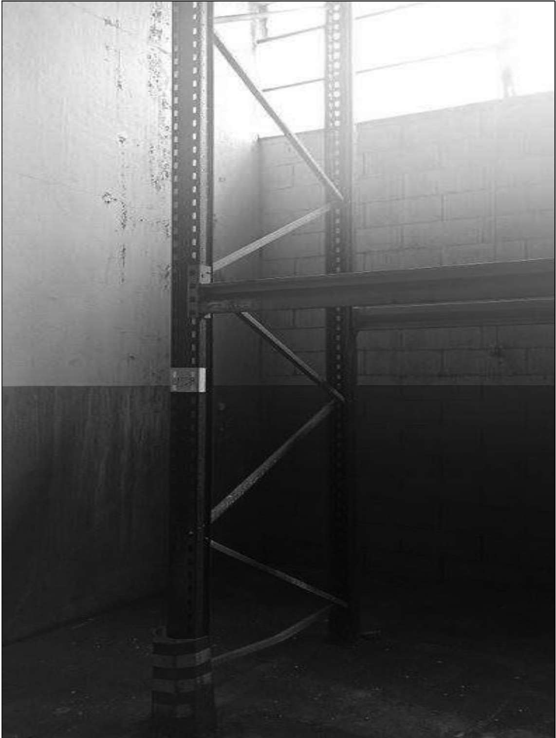
ITEM 1,011 – VISTA DA ESTANTE PORTA PALLETS, 30 PRATELEIRAS, 16 COLUNAS
