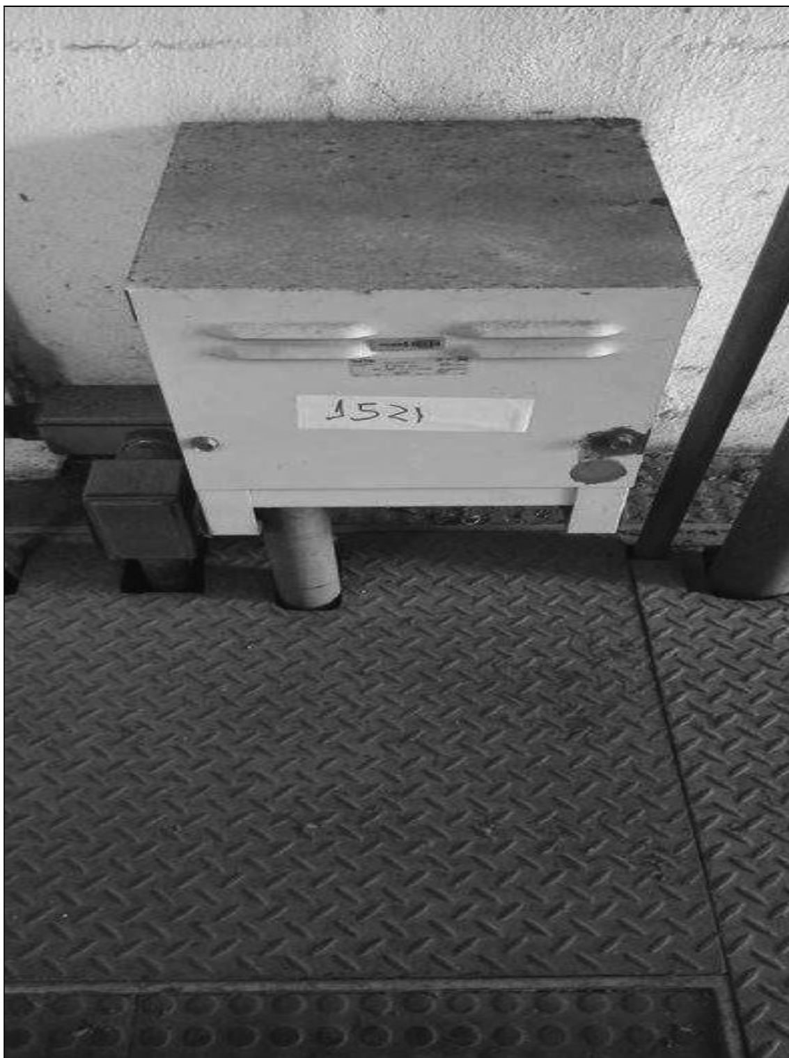
ITEM 1,009 – VISTA DO ESTABILIZADOR DE TENSAO, FAB. BYT, MOD. RL-08012, 80 AMP, 1 TH 120A
