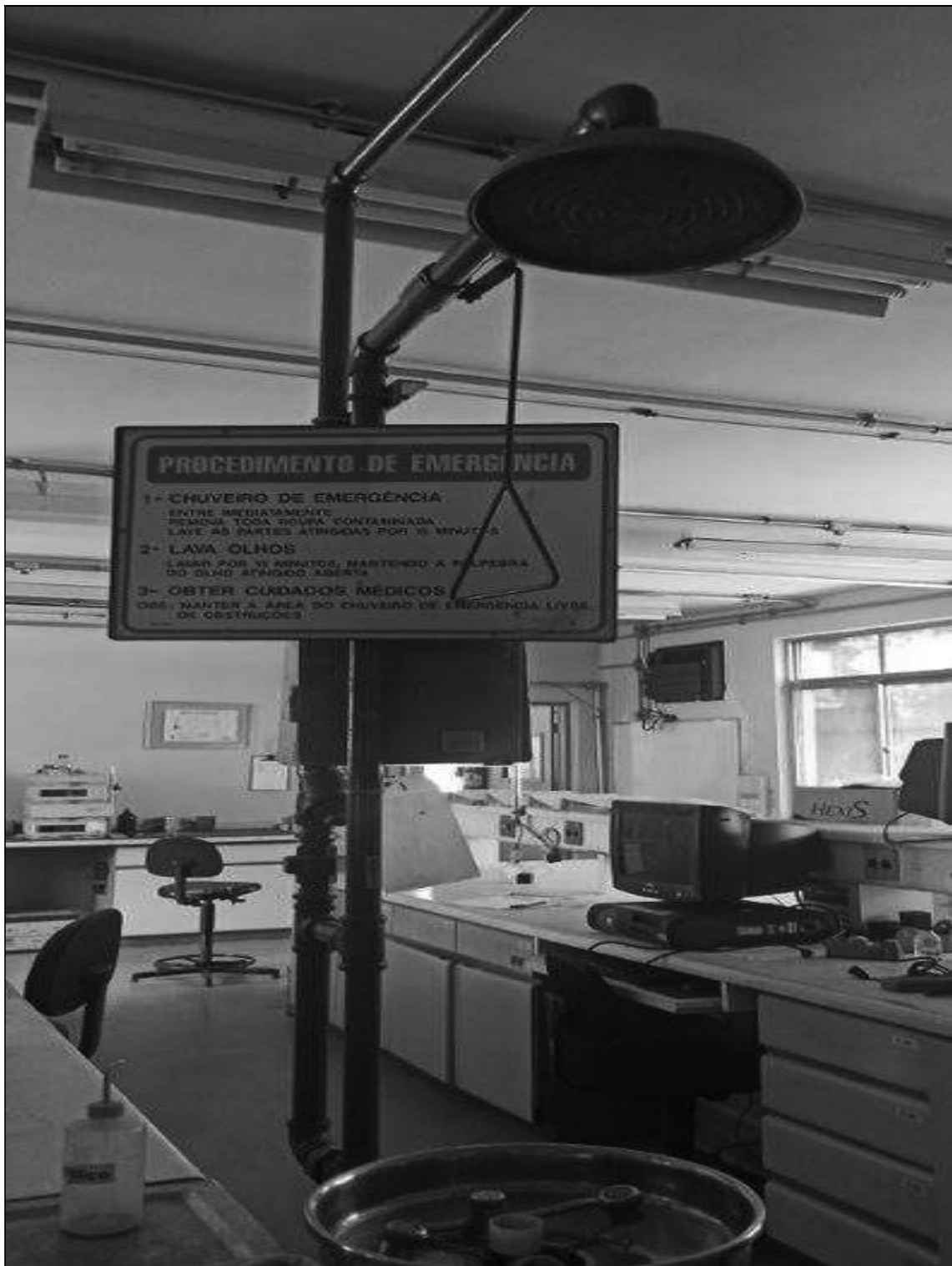
ITEM 1,130 – VISTA DO CHUVEIRO DE EMERGENCIA, COM LAVA OLHOS
