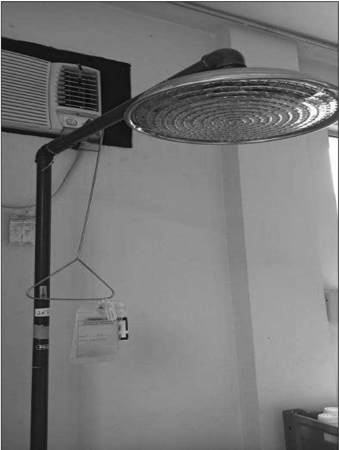
ITEM 1,057 – VISTA DO CHUVEIRO DE EMERGENCIA, COM LAVA OLHOS
