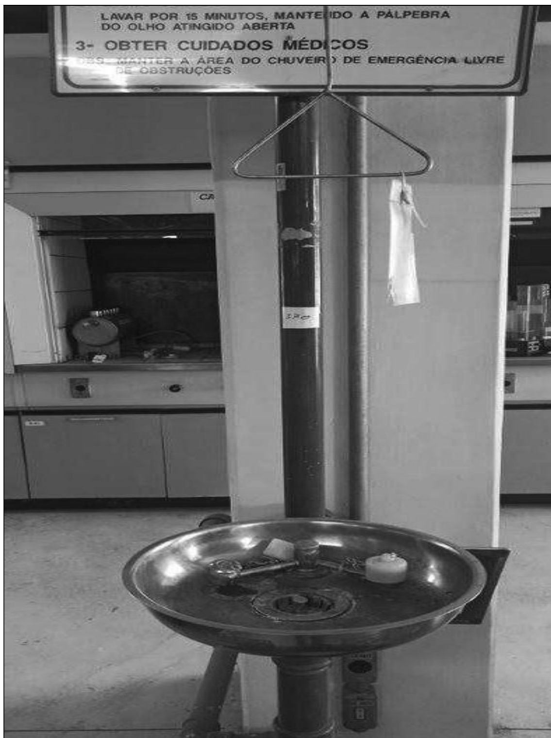
ITEM 1,112 – VISTA DO CHUVEIRO DE EMERGENCIA, COM LAVA OLHOS
