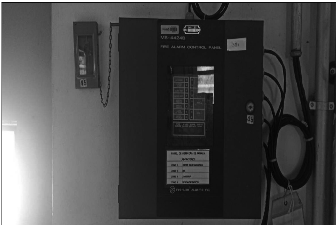
ITEM 1,120 – VISTA DO DETECTOR DE INCENDIO, FAB. FIRE WIRE ALARMS, MOD. MS 44 24 D
