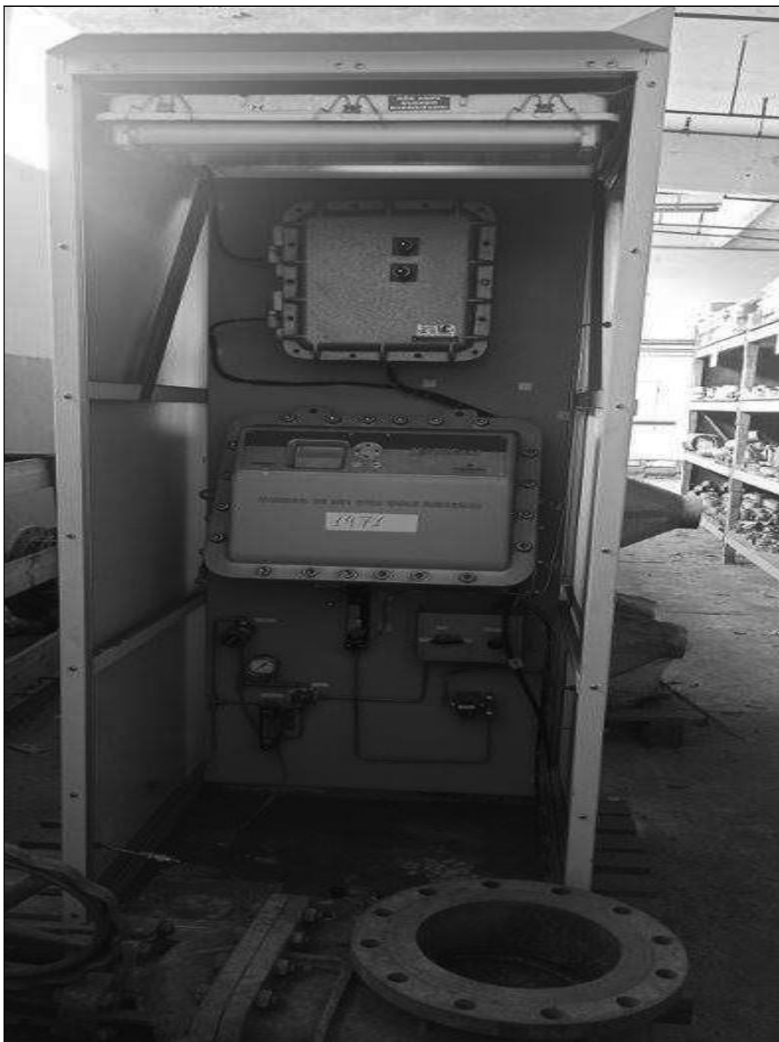
ITEM 1,032 – VISTA DO ANALIZADOR DE GASES, FAB. EMERSON, MOD. XSTREAM
