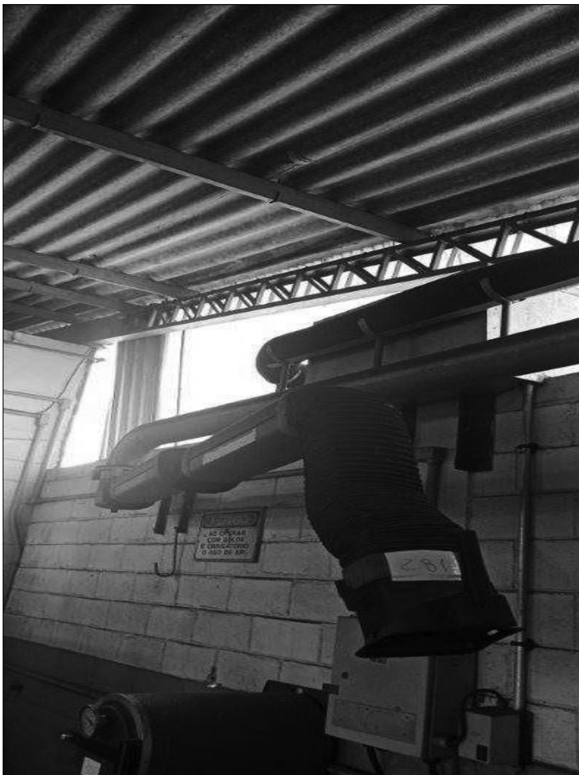
ITEM 1,084 – VISTA DO SISTEMA DE EXAUSTAO, VENTILADOR CENTRIFUGO, DIAM.250 MM, ACIONAM. MOTOR ELETRICO 1,0 CV, 1 PONTO DE ASPIRACAO
