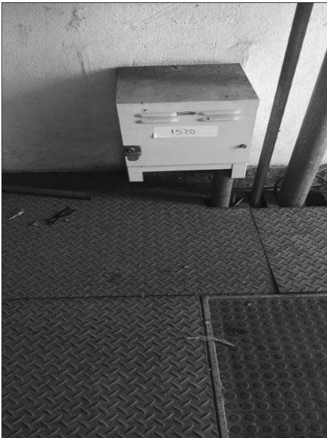
ITEM 1,008 – VISTA DO ESTABILIZADOR DE TENSAO, FAB. BYT, MOD. RL-08012, 80 AMP, 1 TH 120A
