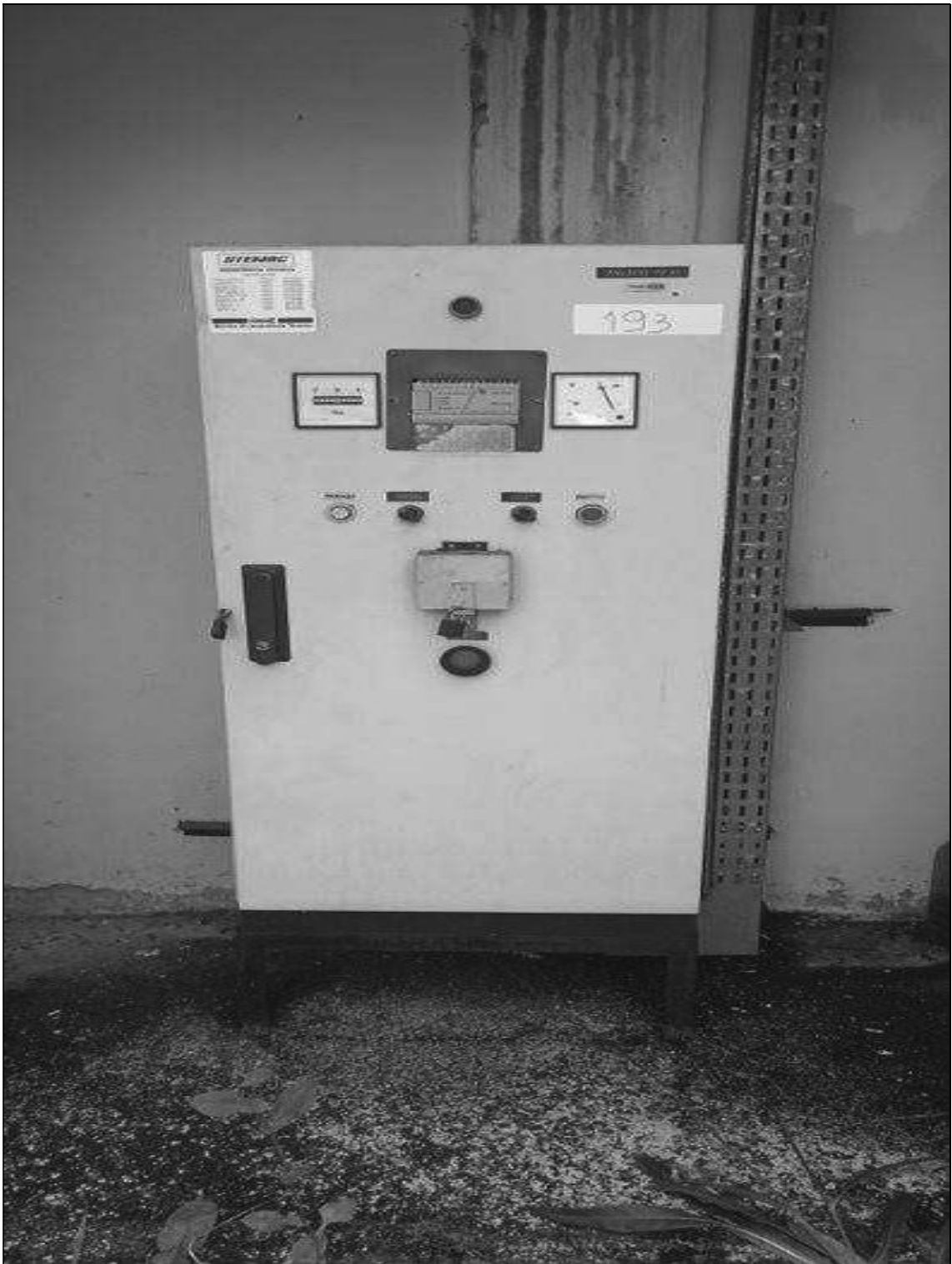
ITEM 1,049 – VISTA DO PAINEL DO GERADOR, DIM. 700X300X1300 MM
