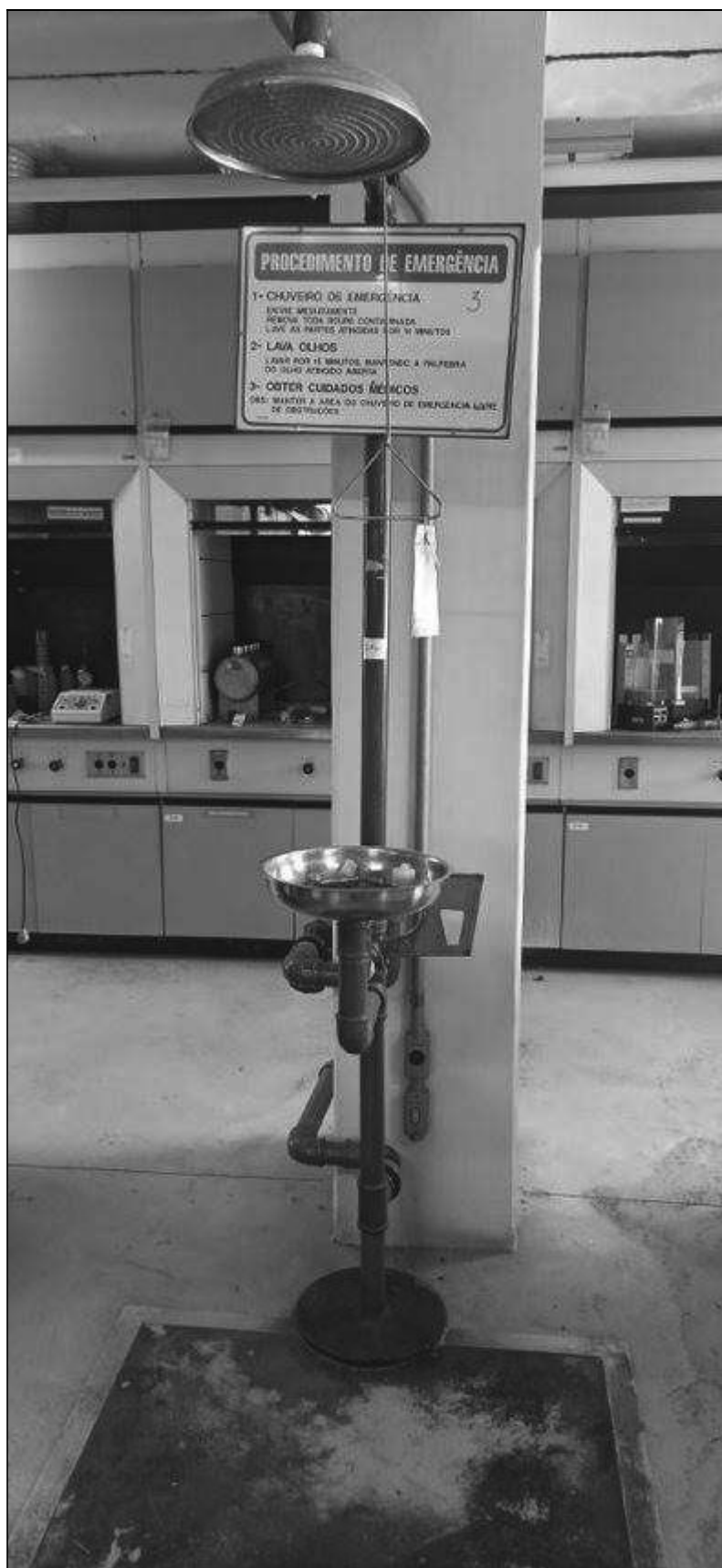
ITEM 1,112 – VISTA DO CHUVEIRO DE EMERGENCIA, COM LAVA OLHOS
