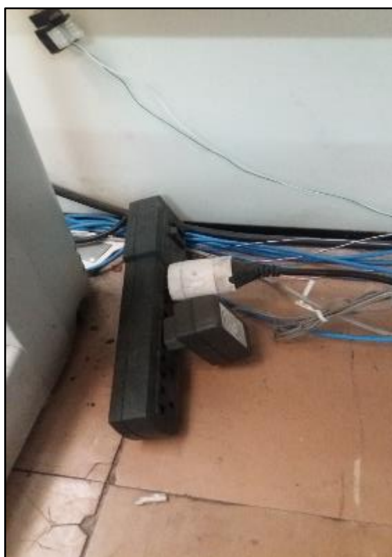
ITEM 3,173 - VISTA DO FILTRO DE LINHA
