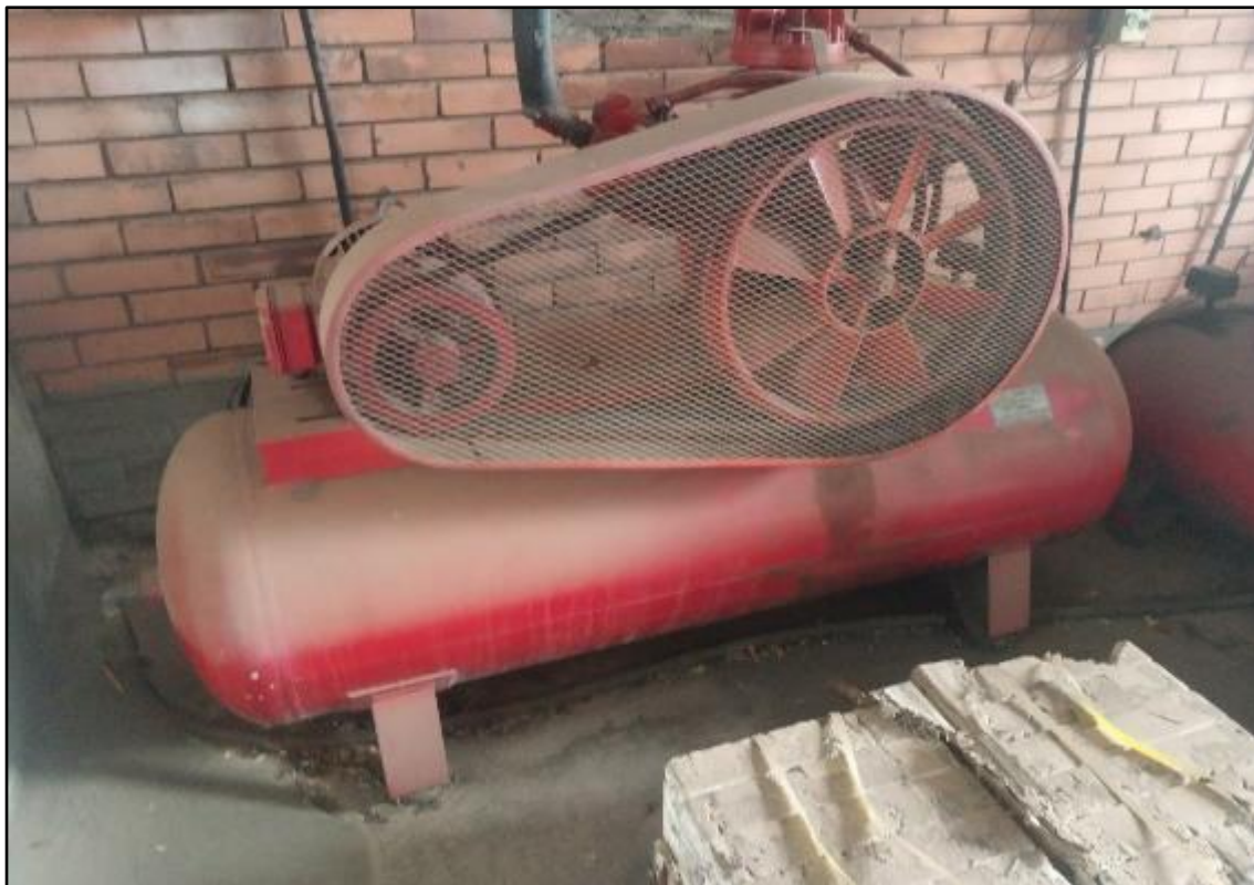
ITEM 1,036 - VISTA DO COMPRESSOR SCHULZ
