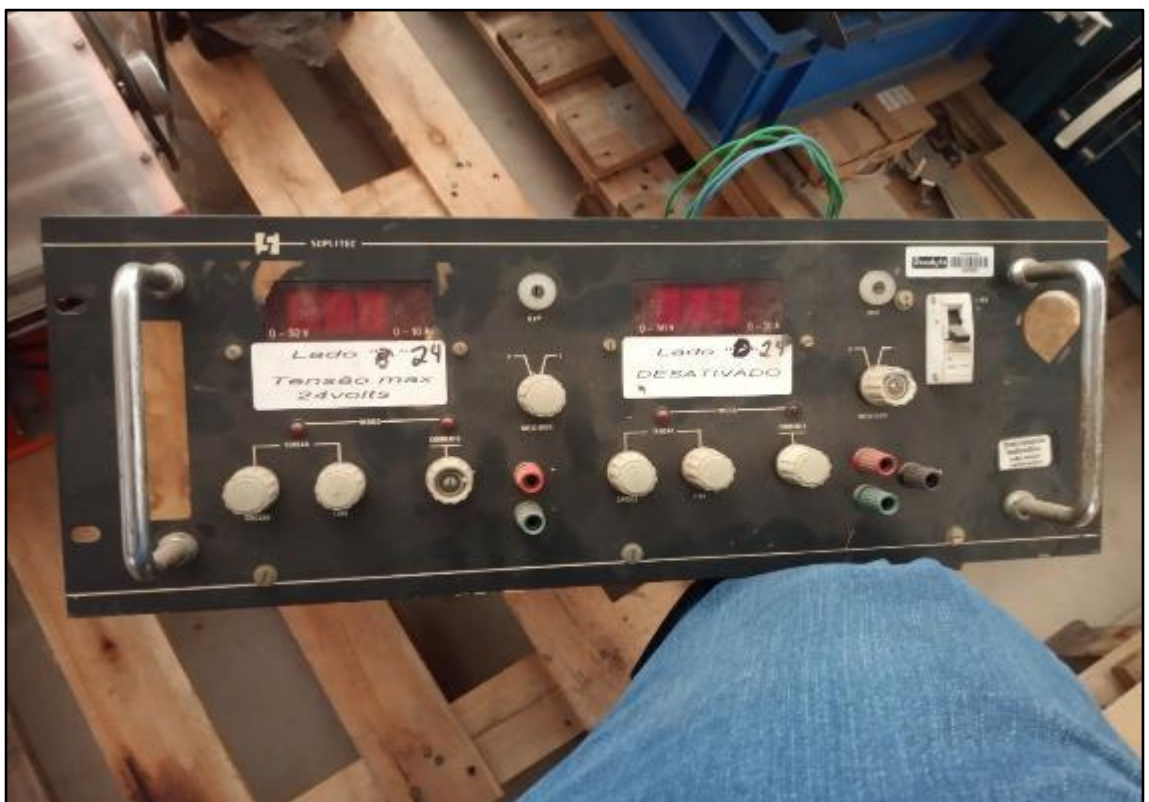
ITEM 1,027 - VISTA DA FONTE SUPLITEC
