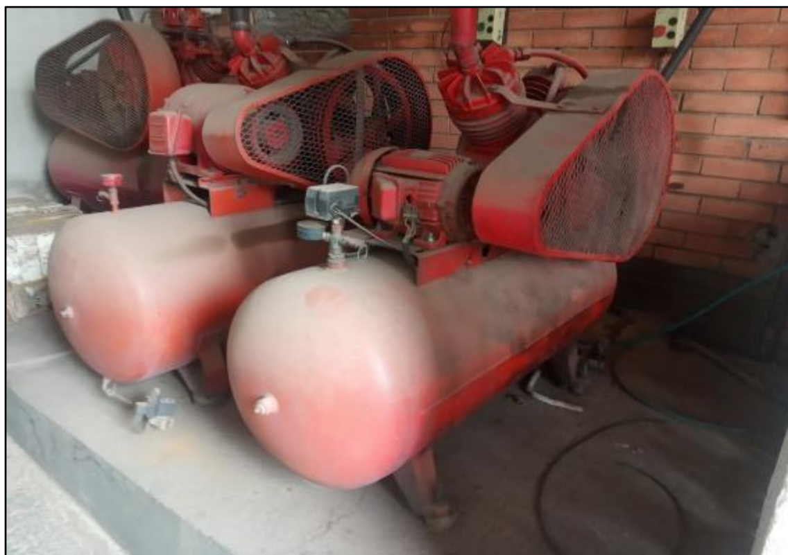
ITEM 1,038 - VISTA DO COMPRESSOR
