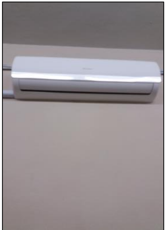
ITEM 2,131 - VISTA DO AR CONDICIONADO SPRINGER
