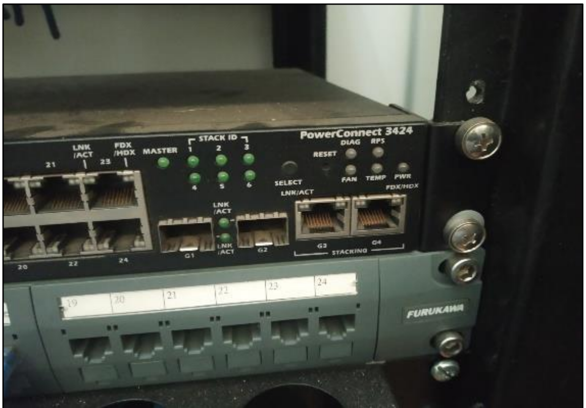
ITEM 3,041 - VISTA DO SWITCH DELL POWERCONNECT 3424
