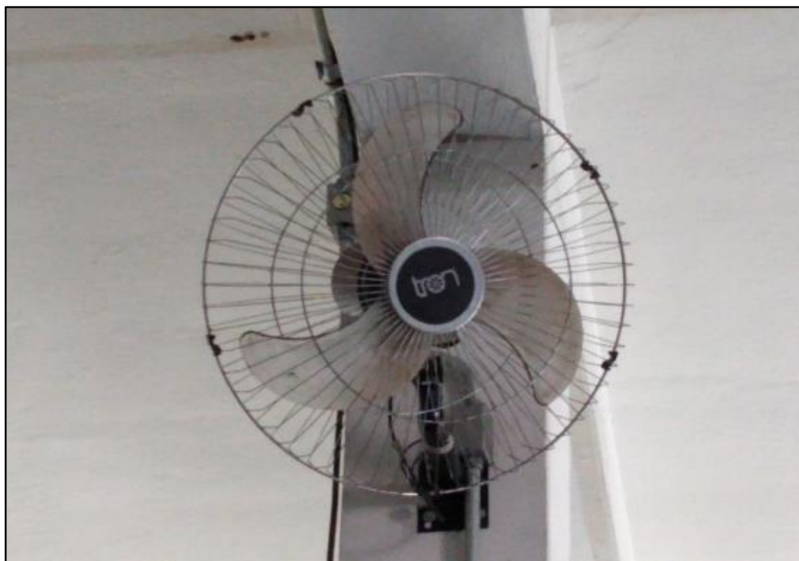
ITEM 2,128 - VISTA DO VENTILADOR DE PAREDE TRON
