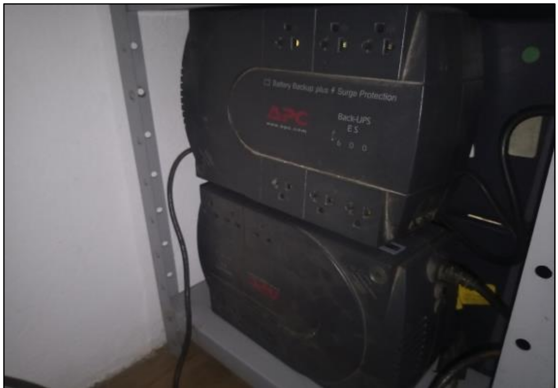
ITEM 3,018 - VISTA DO BACK UP DE BATERIA APC BACK UPS ES 600
