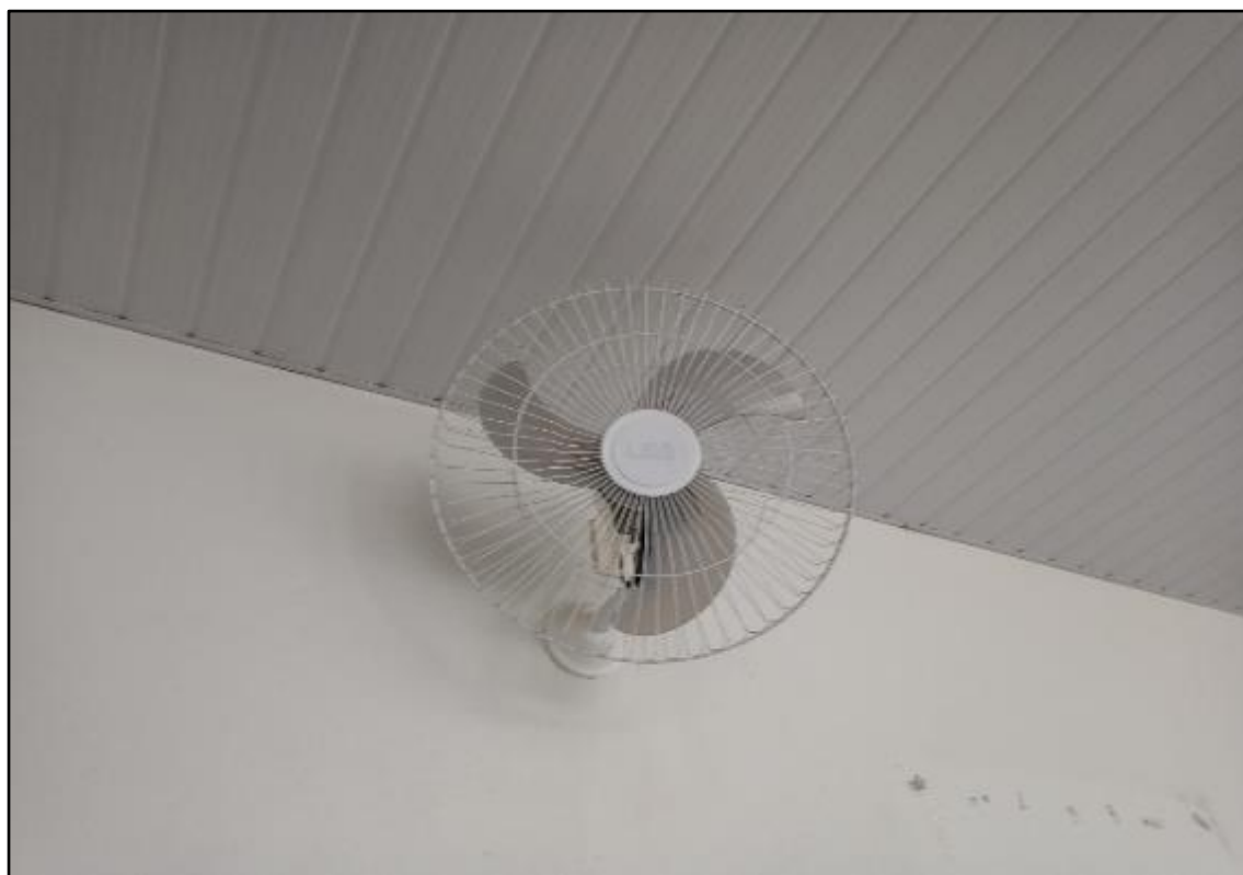
ITEM 2,008 - VISTA DO VENTILADOR DE PAREDE TRON
