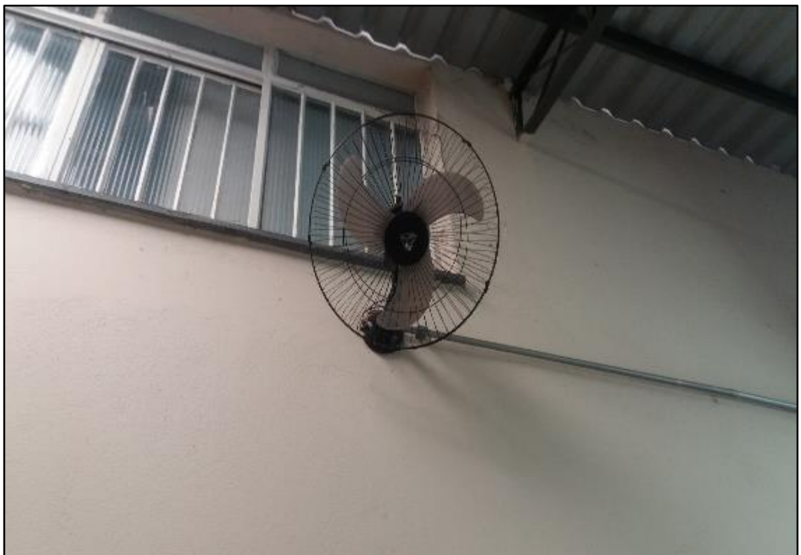
ITEM 2,177 - VISTA DO VENTILADOR DE PAREDE
