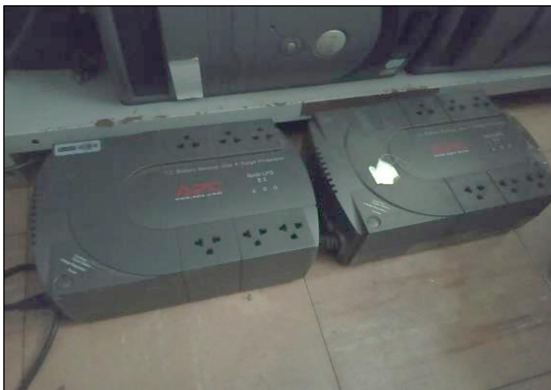
ITEM 3,004 - VISTA DO BACK UP DE BATERIA APC BACK UPS ES 600
