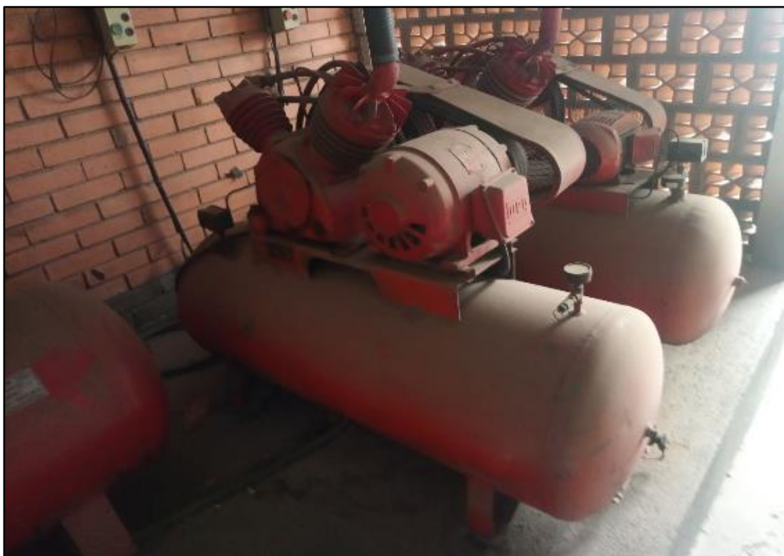
ITEM 1,037 - VISTA DO COMPRESSOR SCHULZ MSV-25/250
