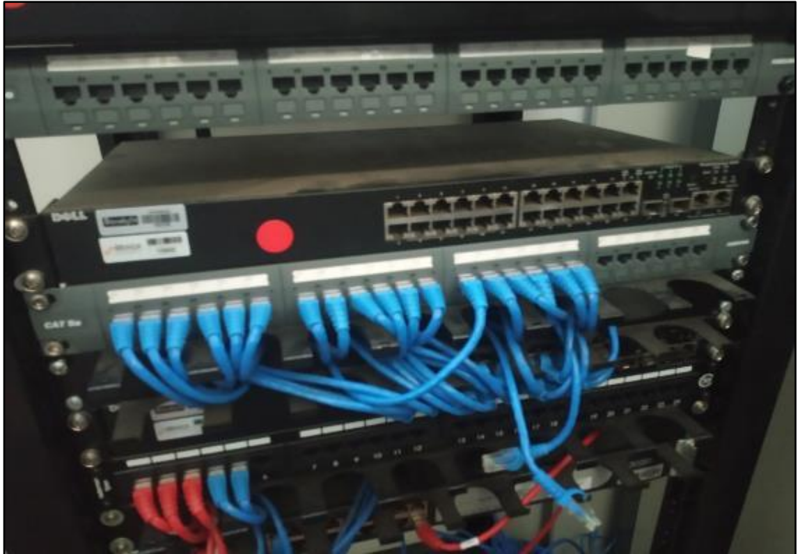
ITEM 3,040 - VISTA DO SWITCH DELL POWERCONNECT 3424
