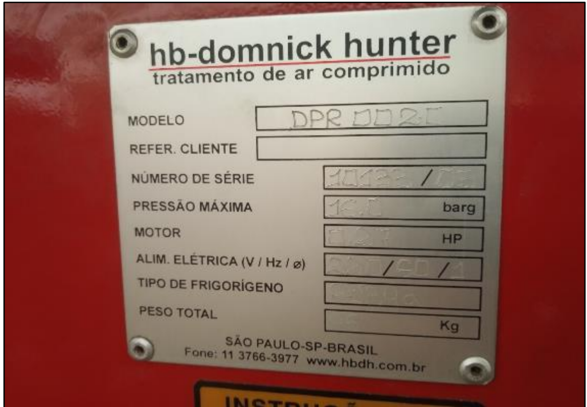
ITEM 1,025 - VISTA DA PLACA DE IDENTIFICAÇÃO DO TRATAMENTO DE AR COMPRIMIDO HB DOMNICK HUNTER DPR 0020 SÉRIE: 101333/05
