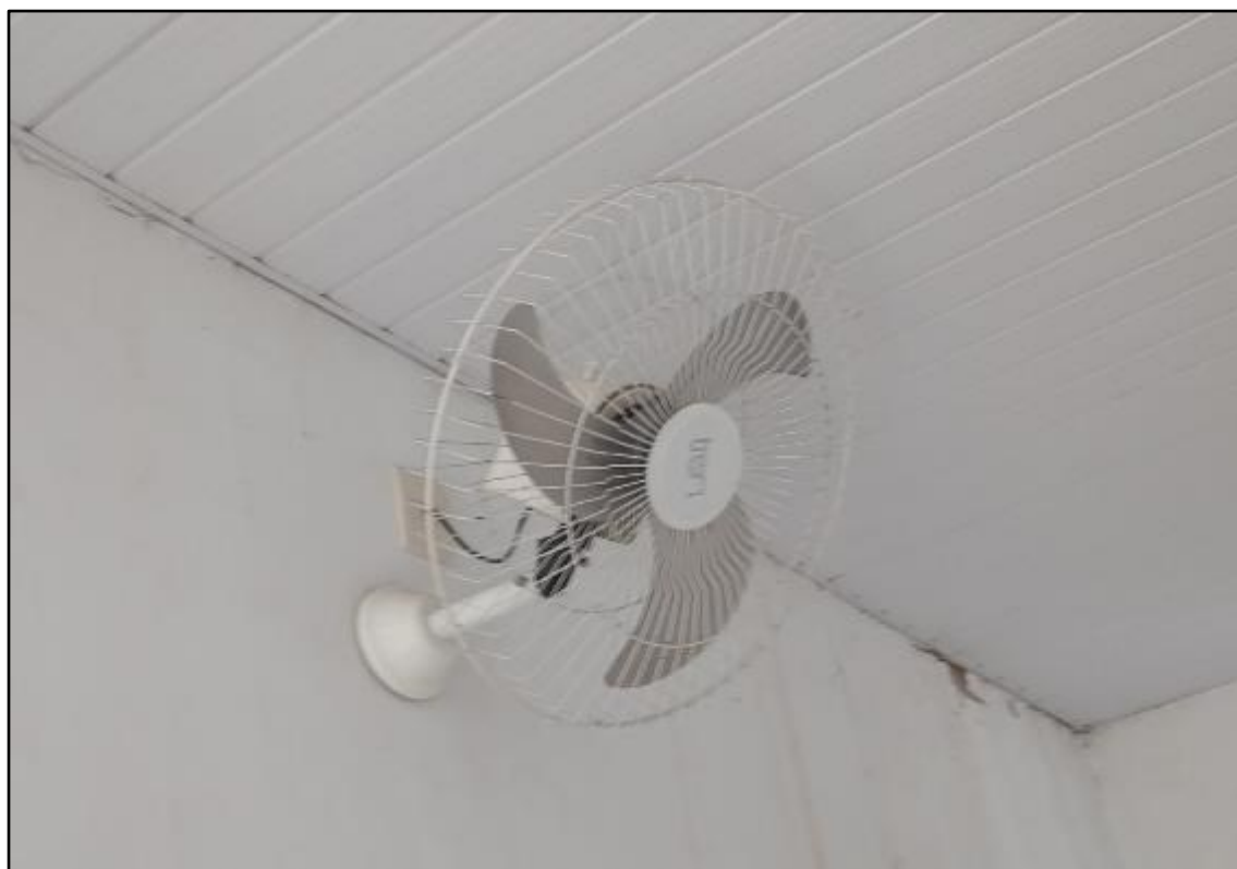
ITEM 2,006 - VISTA DO VENTILADOR DE PAREDE TRON
