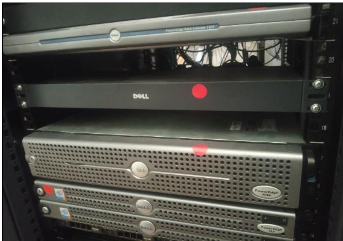
ITEM 3,063 - VISTA DO SWITCH KVM DELL 71PXP
