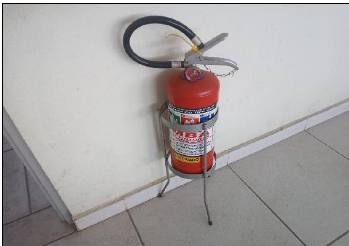
ITEM 5,006 - VISTA DO EXTINTOR
