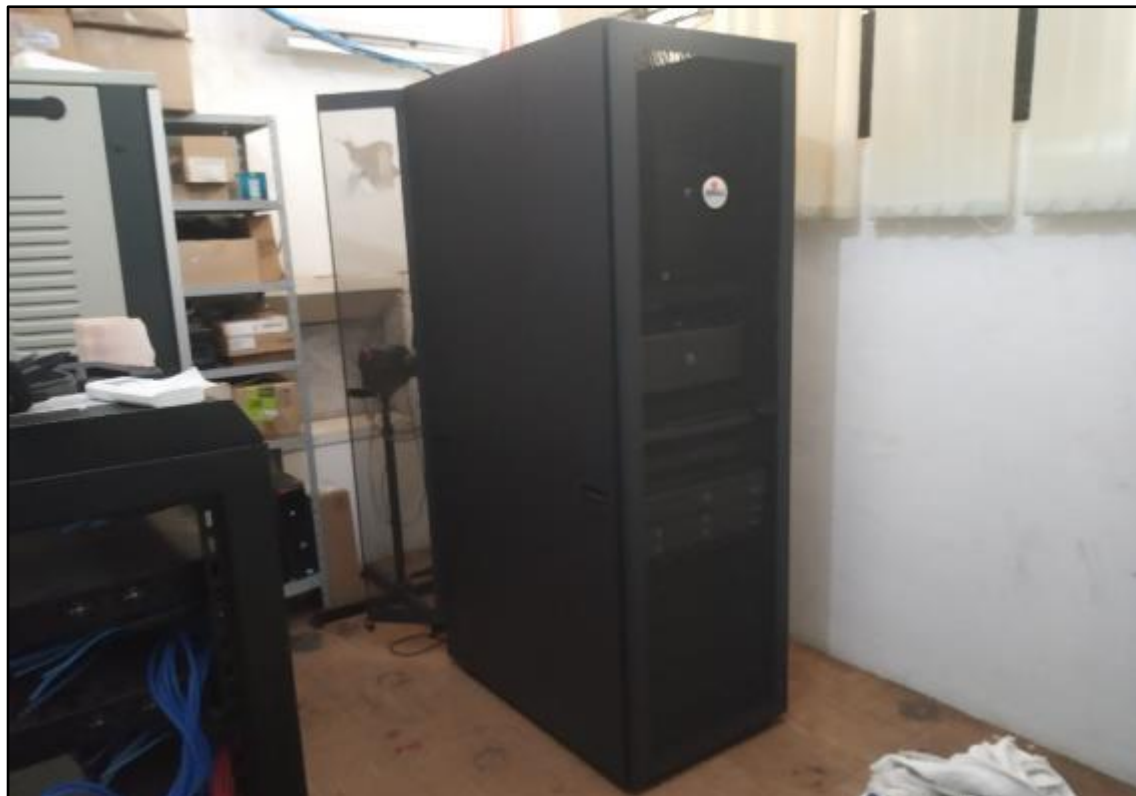
ITEM 3,052 - VISTA DO RACK ALTO DELL
