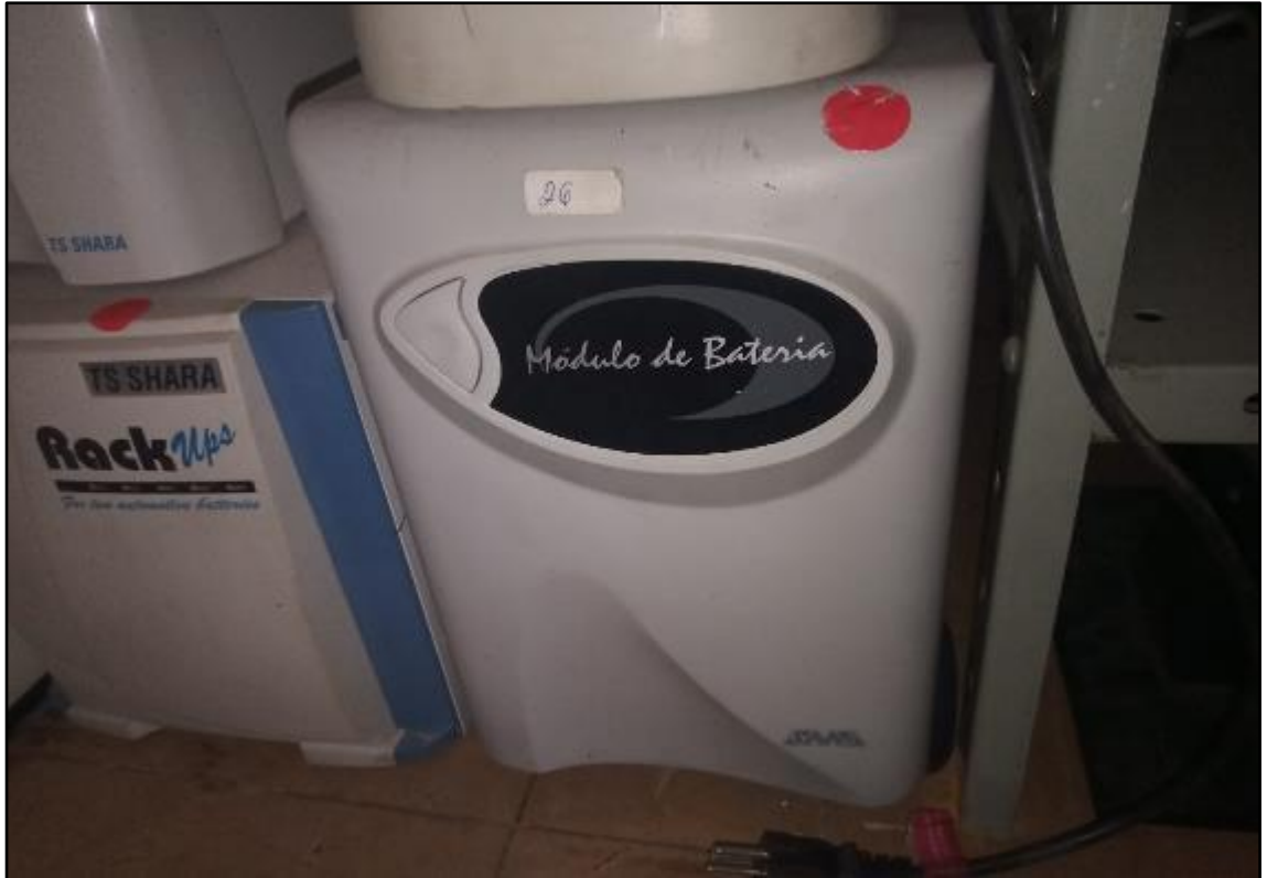
ITEM 3,015 - VISTA DO MÓDULO DE BATERIA SMS SÉRIE: 621950001598
