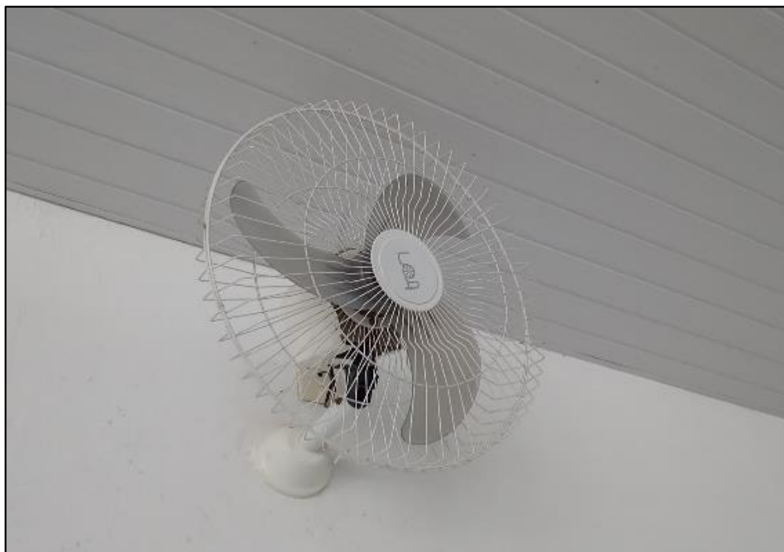
ITEM 2,007 - VISTA DO VENTILADOR DE PAREDE TRON
