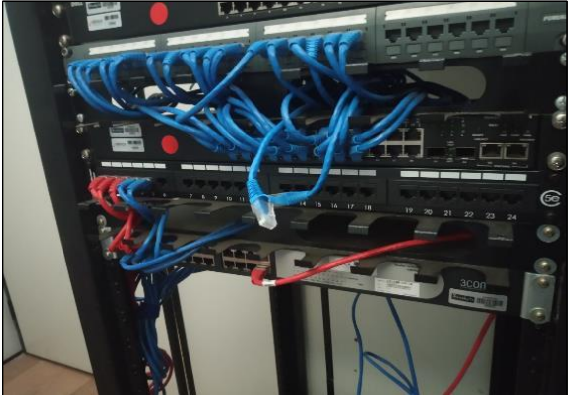
ITEM 3,041 - VISTA DO SWITCH DELL POWERCONNECT 3424
