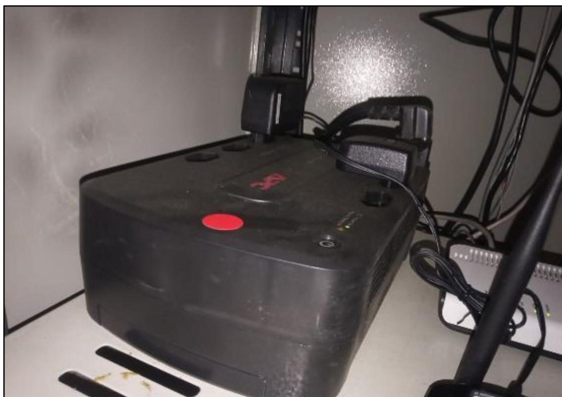
ITEM 3,049 - VISTA DO BACK UP DE BATERIA APC BACK UPS ES 600
