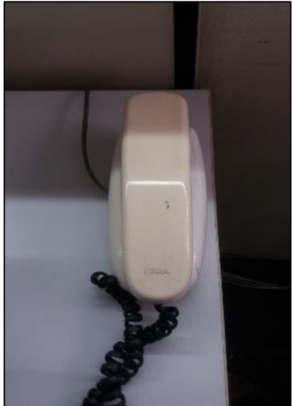
ITEM 2,136 - VISTA DO INTERFONE HDL
