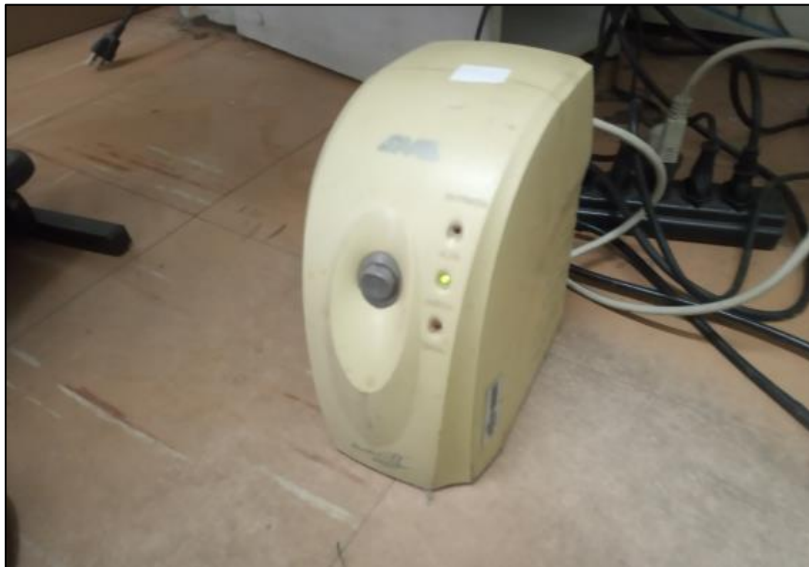
ITEM 3,126 - VISTA DO ESTABILIZADOR SMS REVOLUTION 2
