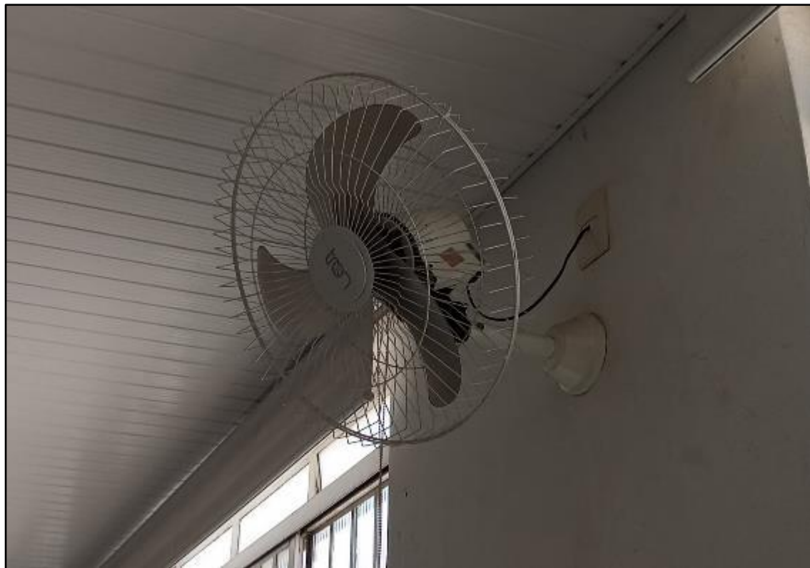
ITEM 2,005 - VISTA DO VENTILADOR DE PAREDE TRON
