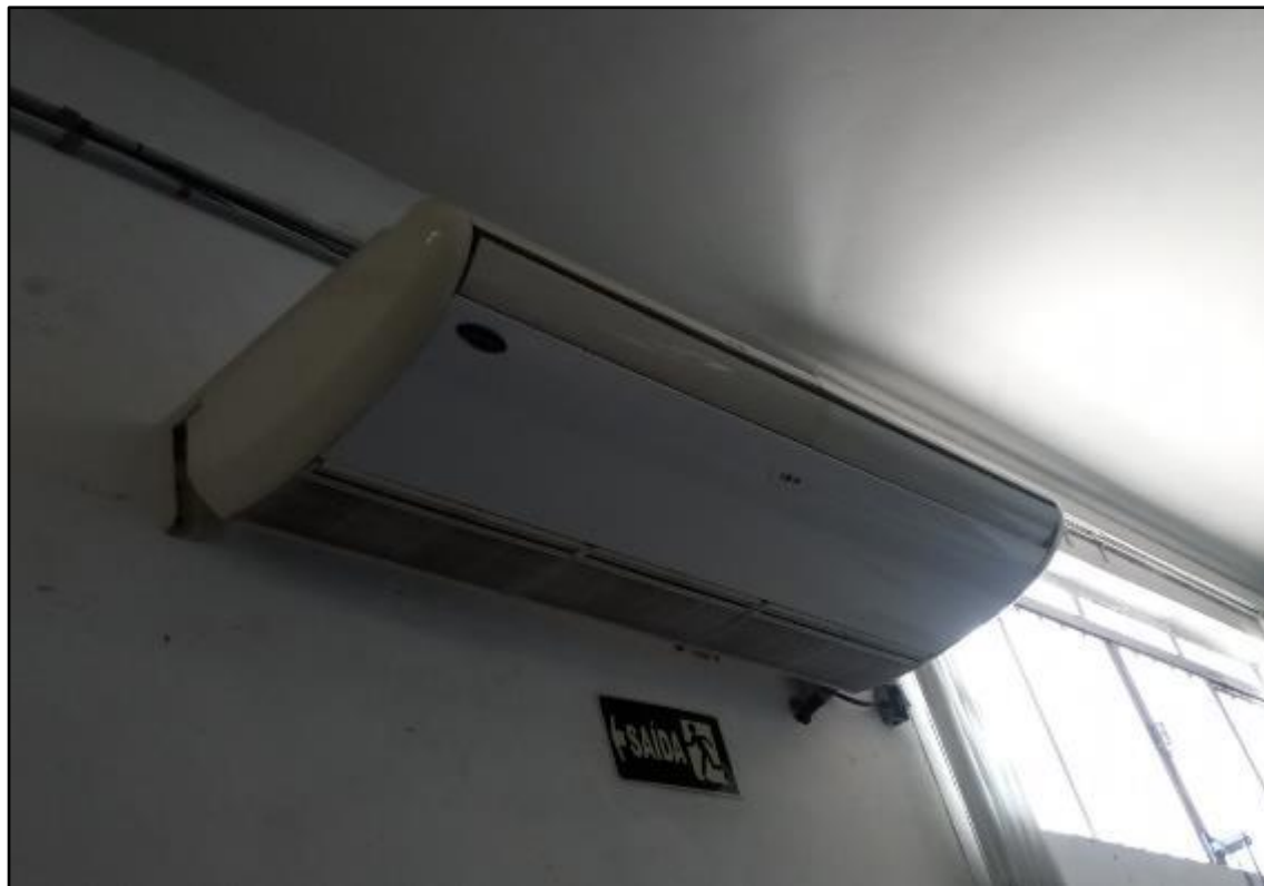
ITEM 2,051 - VISTA DO AR CONDICIONADO CARRIER
