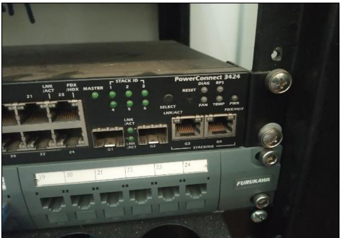
ITEM 3,040 - VISTA DO SWITCH DELL POWERCONNECT 3424
