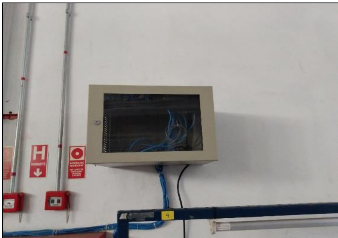
ITEM 3,164 - VISTA DO RACK DE PAREDE
