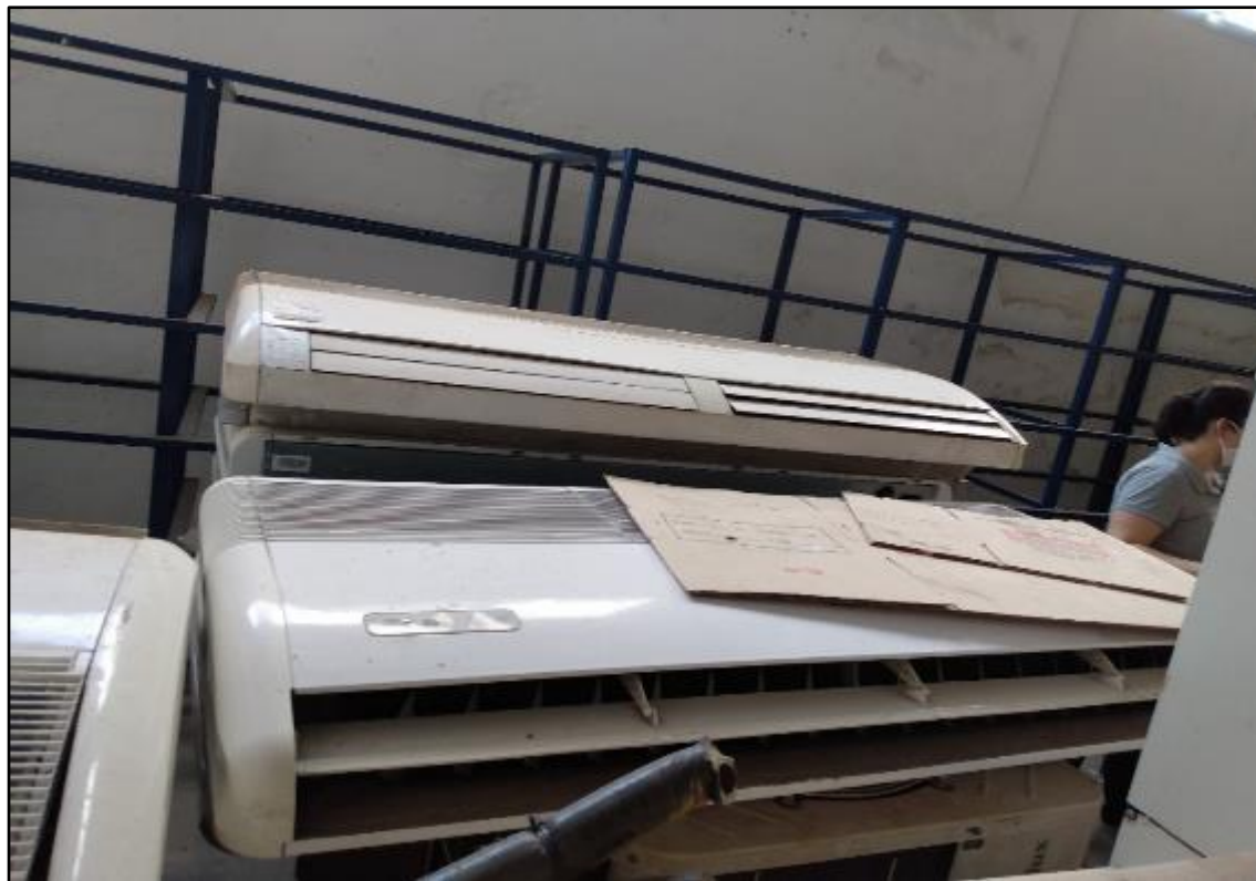
ITEM 2,114 - VISTA DO AR CONDICIONADO
