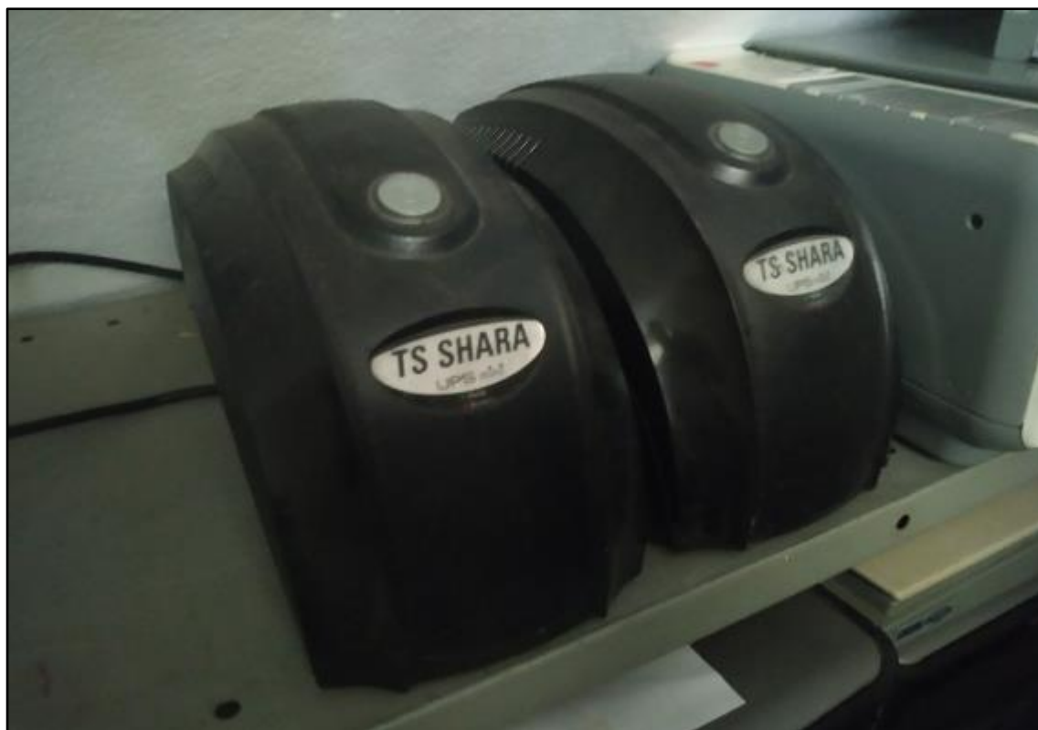
ITEM 3,003 - VISTA DO NOBREAK TS SHARA UPS MINI
