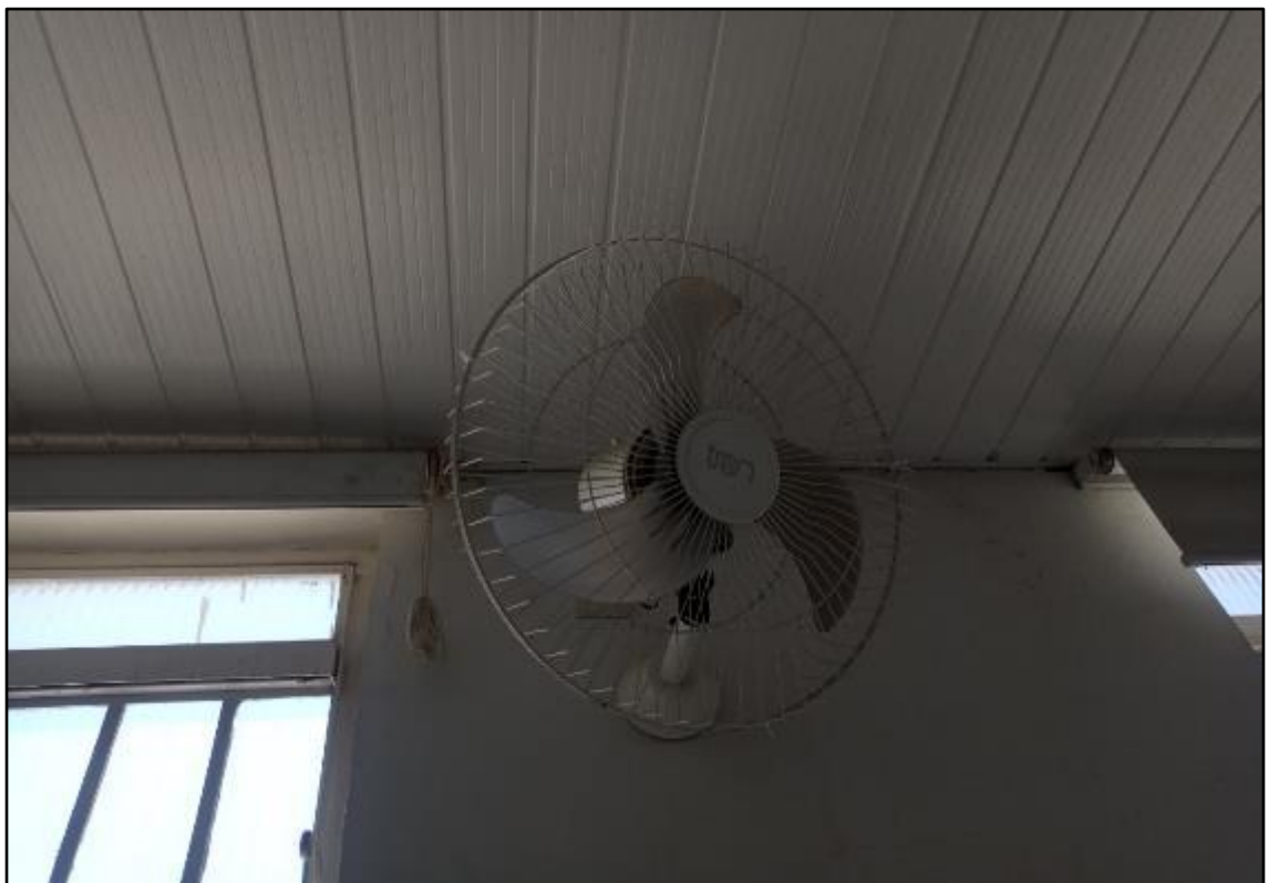
ITEM 2,004 - VISTA DO VENTILADOR DE PAREDE TRON
