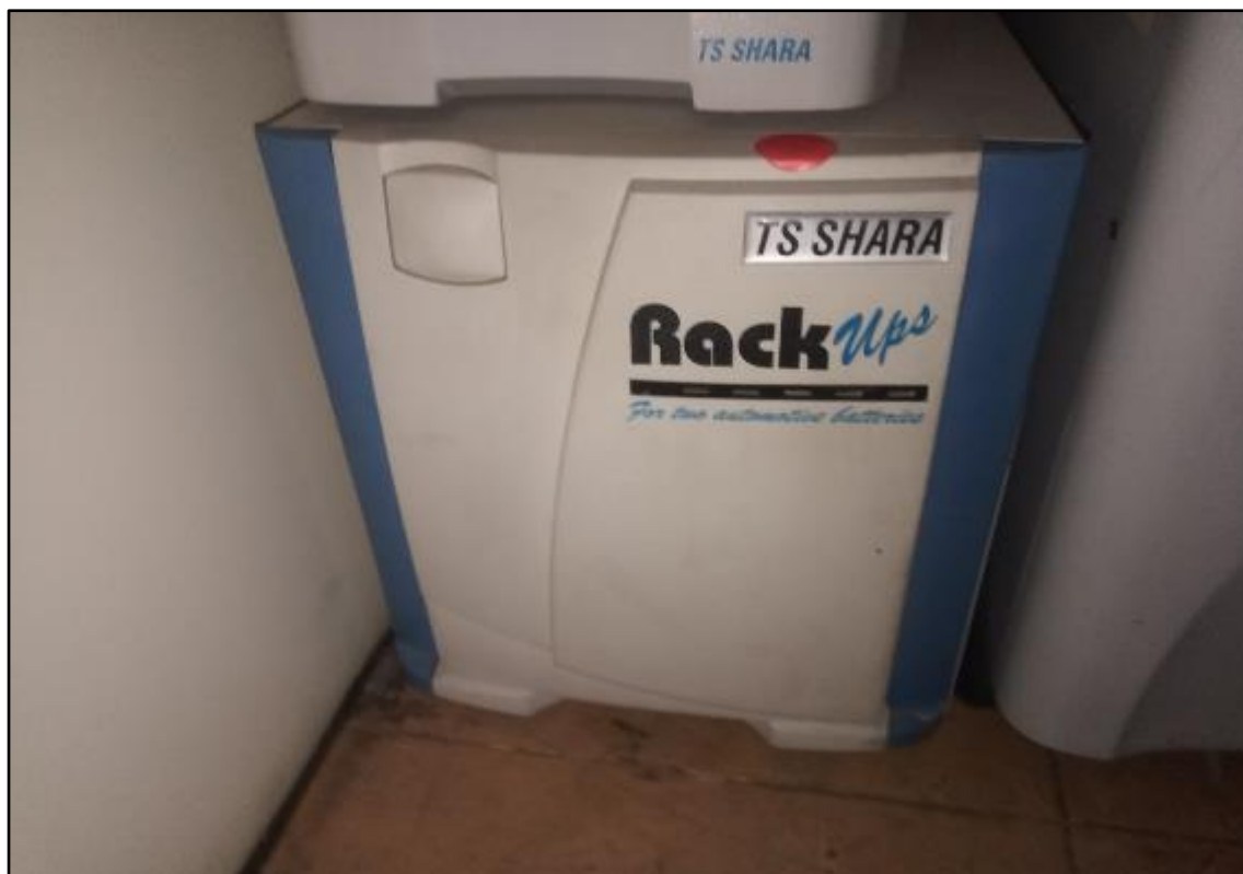
ITEM 3,016 - VISTA DO MÓDULO DE BATERIA TS SHARA RACK UPS
