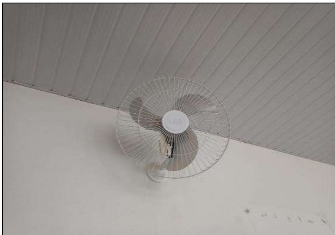
ITEM 2,008 - VISTA DO VENTILADOR DE PAREDE TRON
