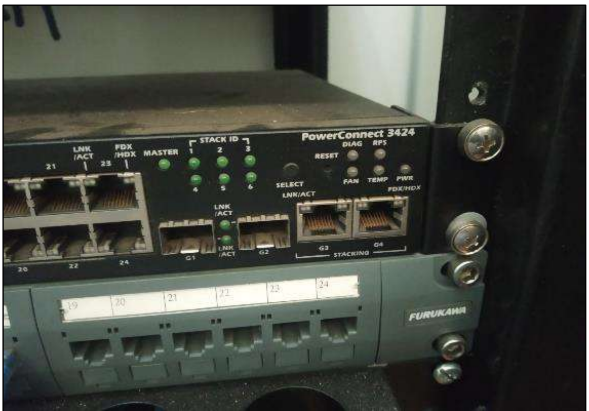
ITEM 3,041 - VISTA DO SWITCH DELL POWERCONNECT 3424
