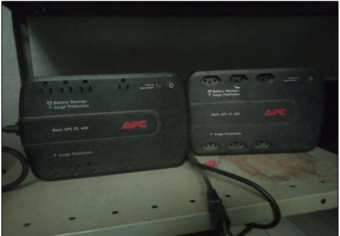
ITEM 3,005 - VISTA DO BACK UP DE BATERIA APC BACK UPS ES 600
