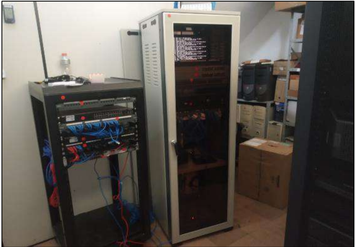
ITEM 3,043 - VISTA DO RACK ALTO
