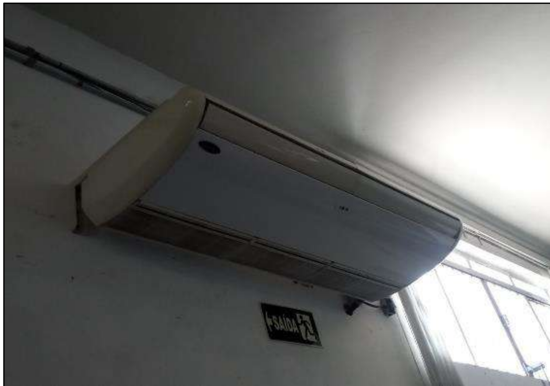
ITEM 2,051 - VISTA DO AR CONDICIONADO CARRIER
