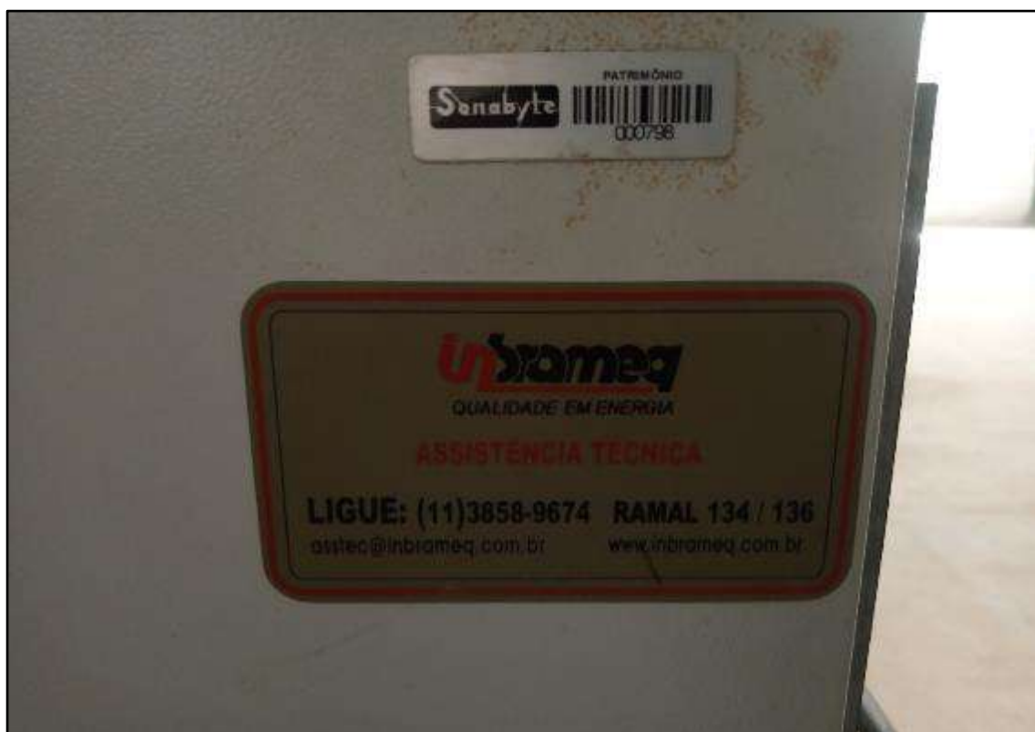
ITEM 1,024 - VISTA DA PLACA DE IDENTIFICAÇÃO DO ESTABILIZADOR INBRAMEQ
