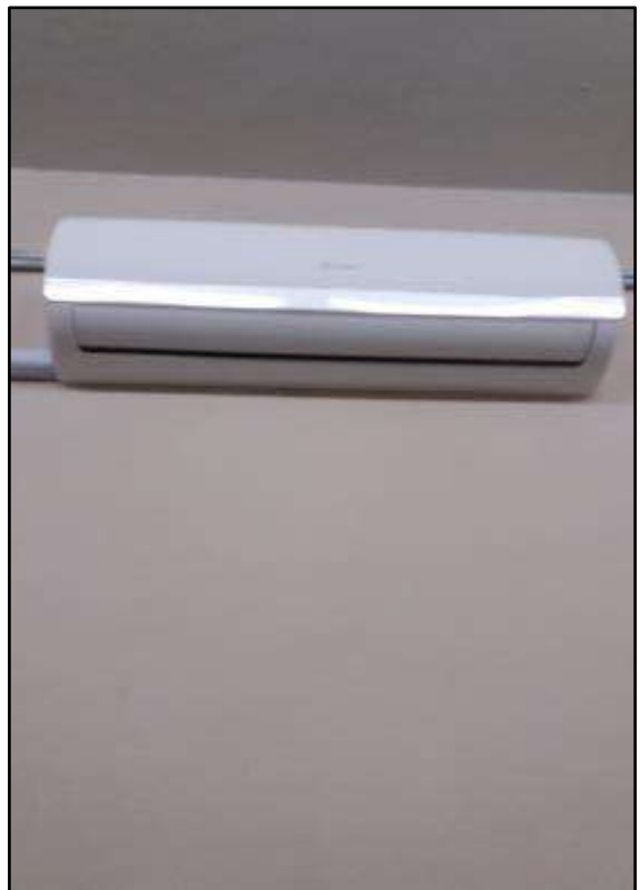
ITEM 2,131 - VISTA DO AR CONDICIONADO SPRINGER
