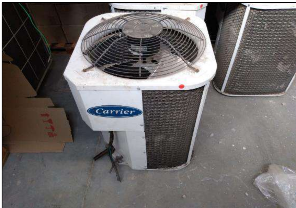
ITEM 2,114 - VISTA DO AR CONDICIONADO
