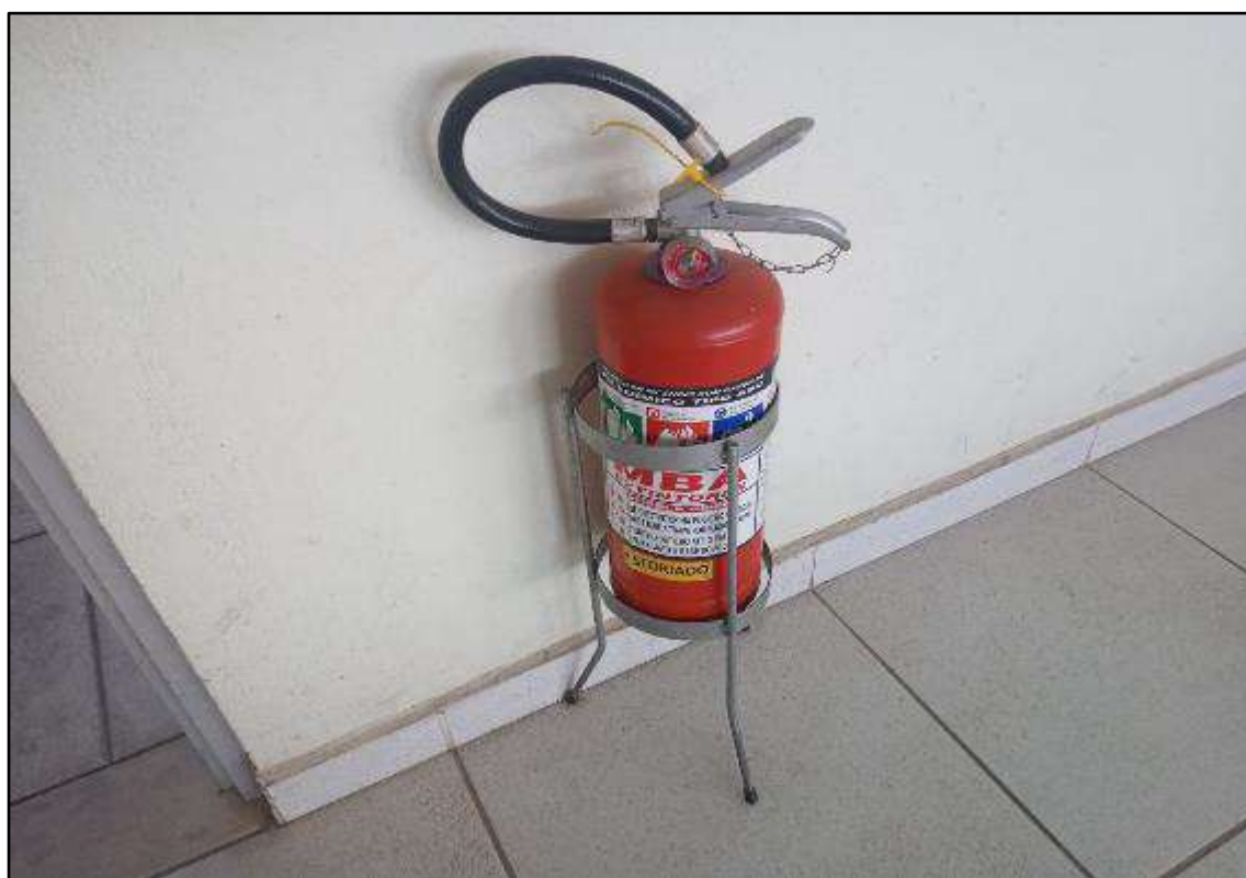
ITEM 5,006 - VISTA DO EXTINTOR
