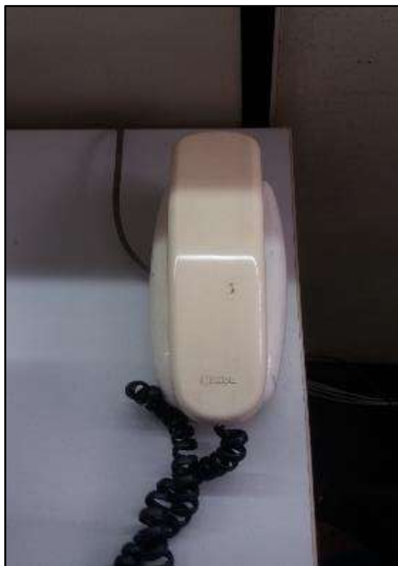
ITEM 2,136 - VISTA DO INTERFONE HDL
