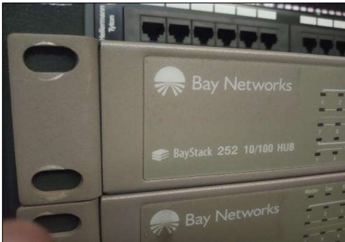
ITEM 3,046 - VISTA DA PLACA DE IDENTIFICAÇÃO DO SWITCH 24 PORTAS BAY NETWORKS BAYSTACK 252 10/100
