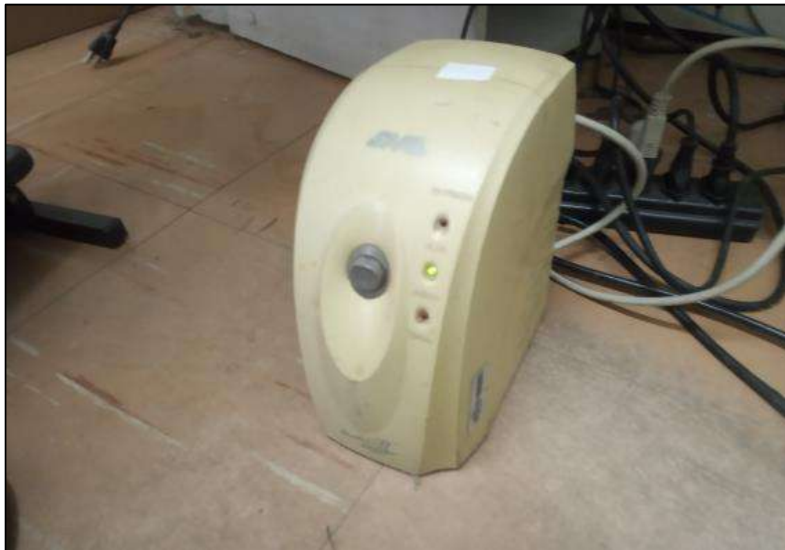
ITEM 3,126 - VISTA DO ESTABILIZADOR SMS REVOLUTION 2
