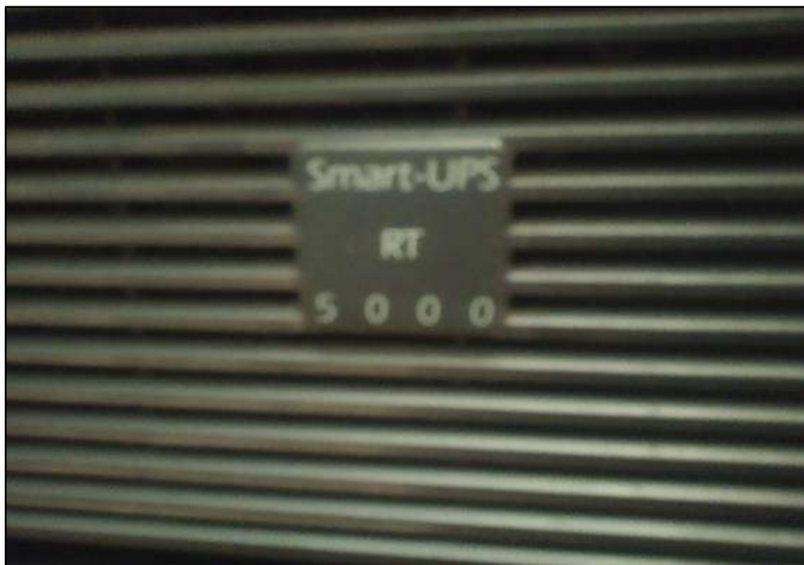
ITEM 3,061 - VISTA DA PLACA DE IDENTIFICAÇÃO DO NOBREAK APC SMART UPS RT 5000
