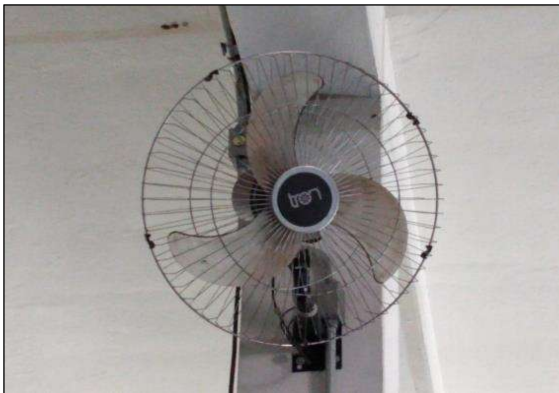
ITEM 2,128 - VISTA DO VENTILADOR DE PAREDE TRON
