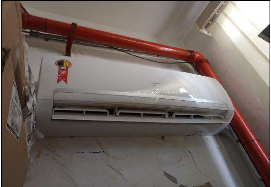
ITEM 2,044 - VISTA DO AR CONDICIONADO 18000 BTUS SPRINGER MIDEA 42M8CA18M5 SÉRIE: 2319B15440992
