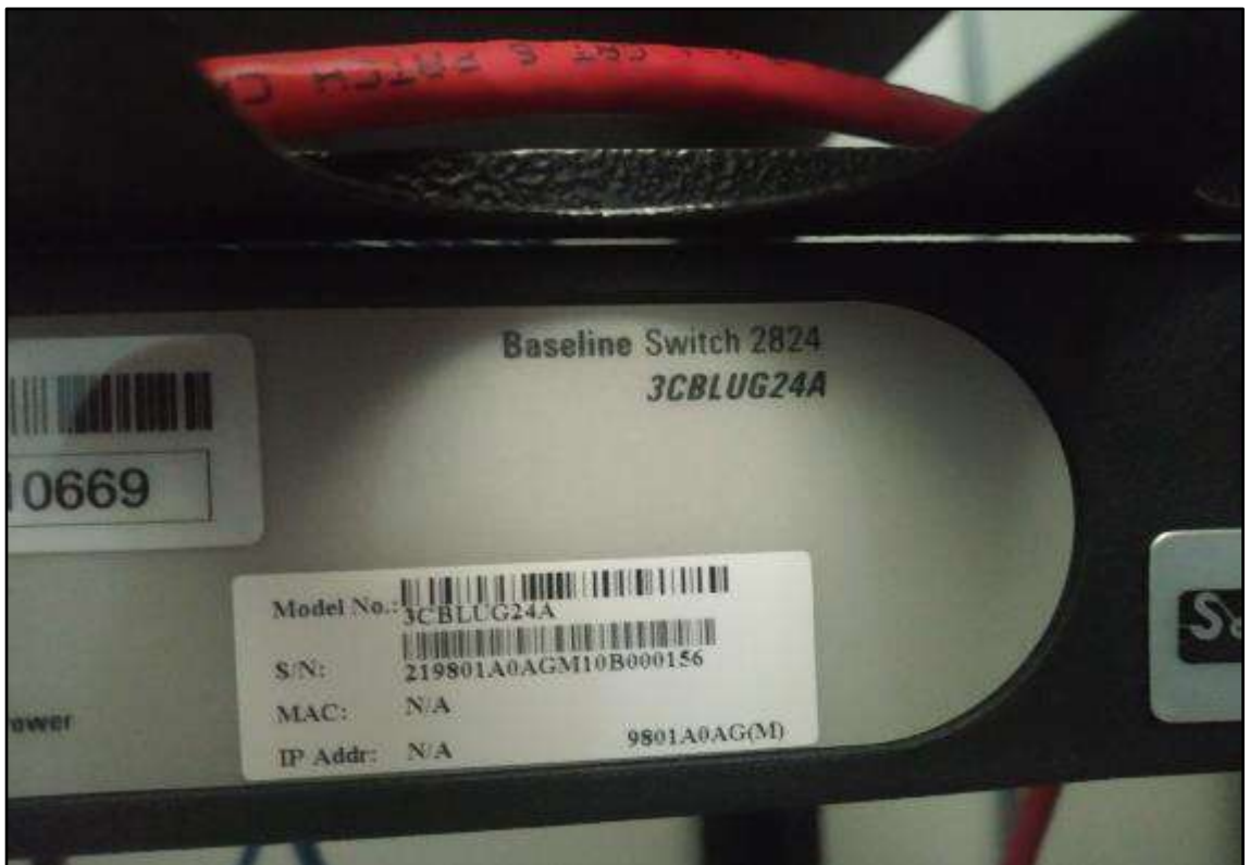
ITEM 3,042 - VISTA DA PLACA DE IDENTIFICAÇÃO DO SWITCH 3COM BASELINE SWITCH 2824 3CBLUG244 SÉRIE: 219801AGM10B000156
