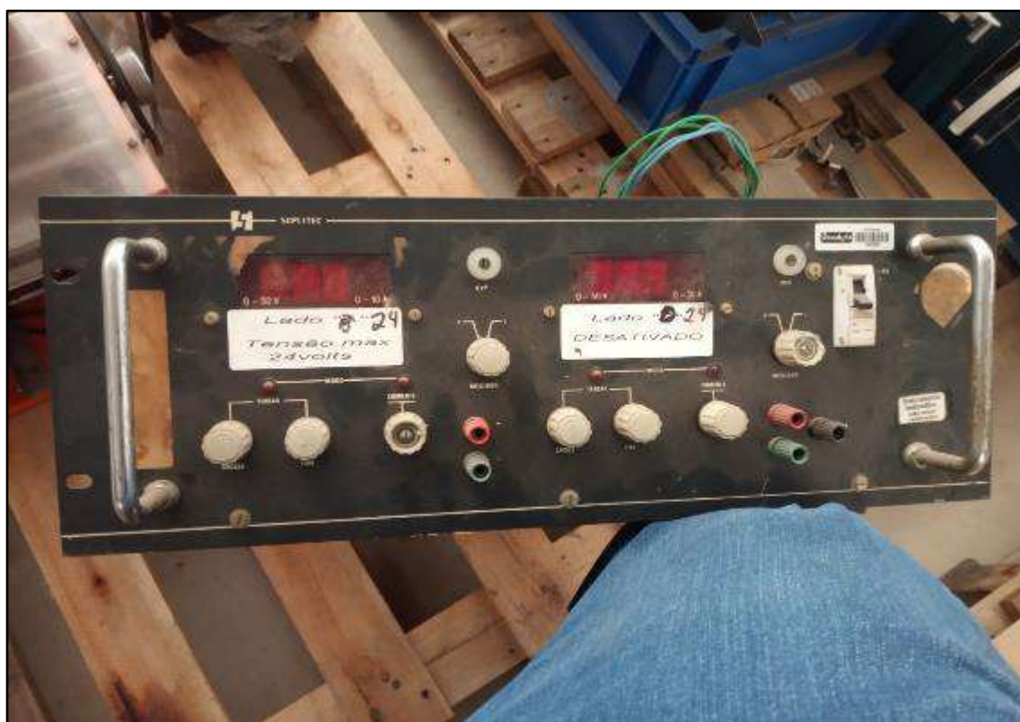
ITEM 1,027 - VISTA DA FONTE SUPLITEC
