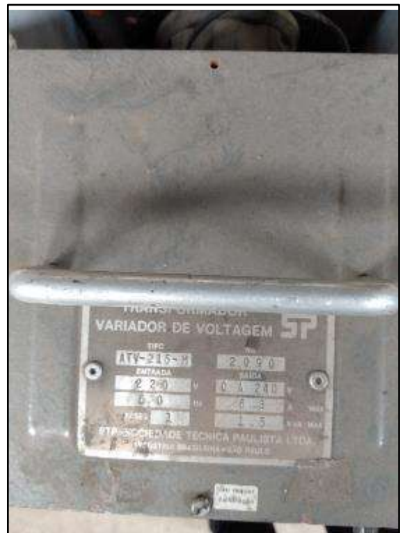
ITEM 1,060 - VISTA DO TRANSFORMADOR VARIADOR DE VOLTAGEM SP ATV-215-M SÉRIE: 2090
