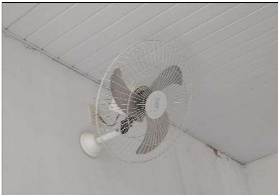
ITEM 2,006 - VISTA DO VENTILADOR DE PAREDE TRON
