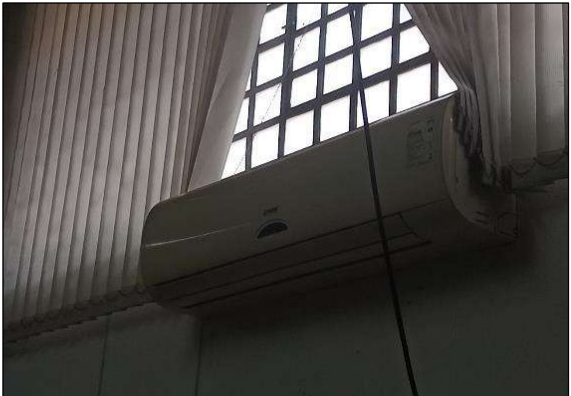
ITEM 2,054 - VISTA DO AR CONDICIONADO 24000 BTUS YORK JJEA24FS-ADA
