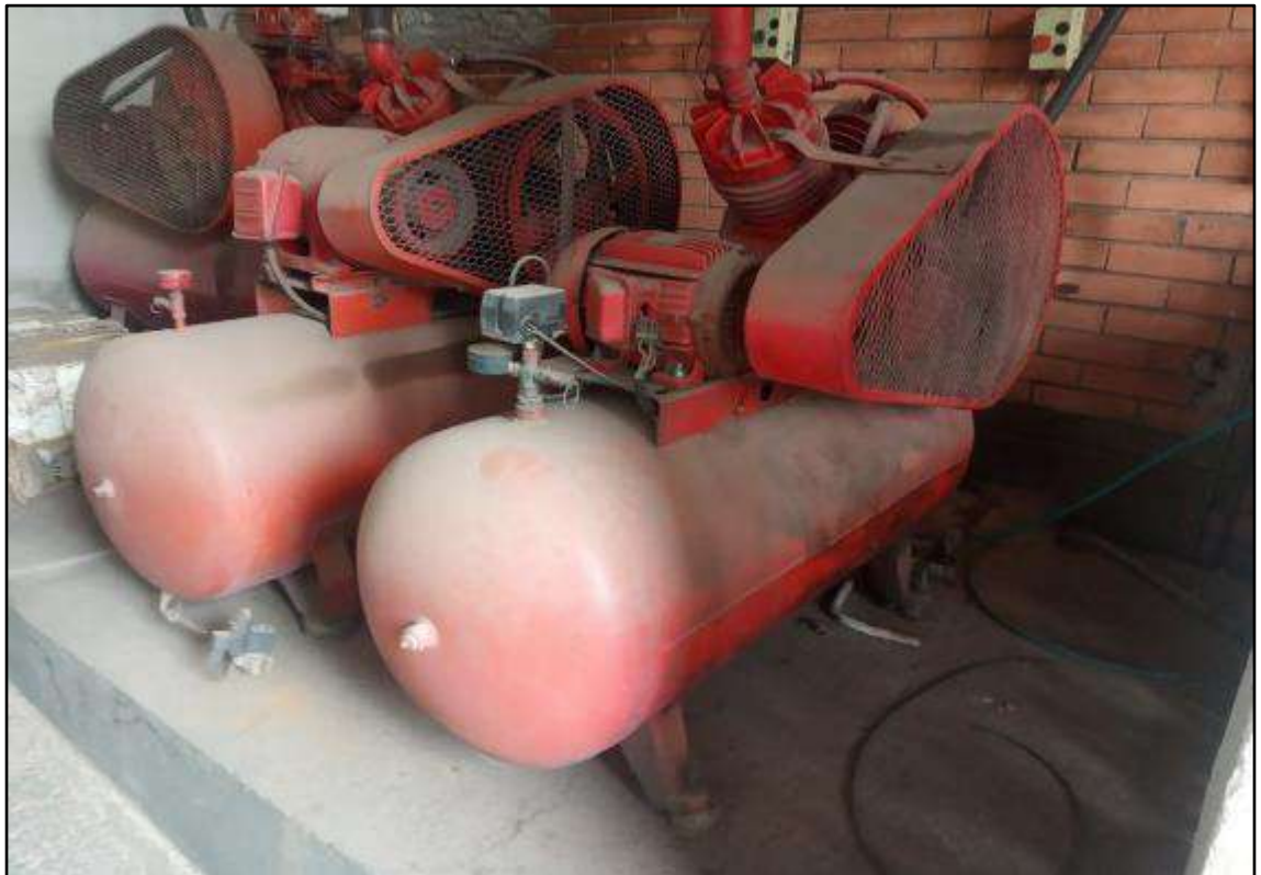
ITEM 1,038 - VISTA DO COMPRESSOR
