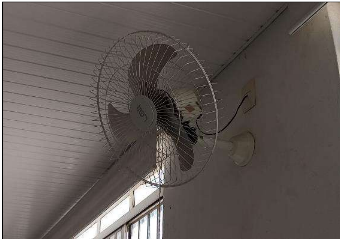
ITEM 2,005 - VISTA DO VENTILADOR DE PAREDE TRON
