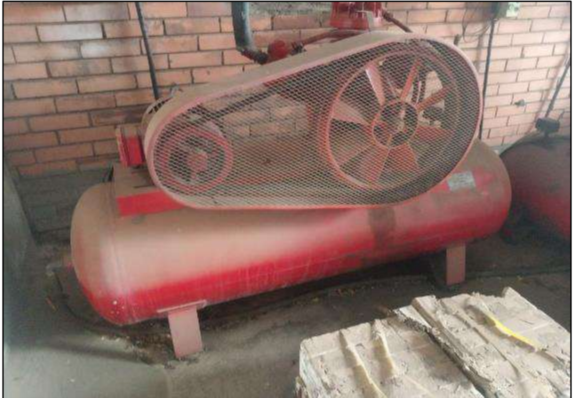
ITEM 1,036 - VISTA DO COMPRESSOR SCHULZ
