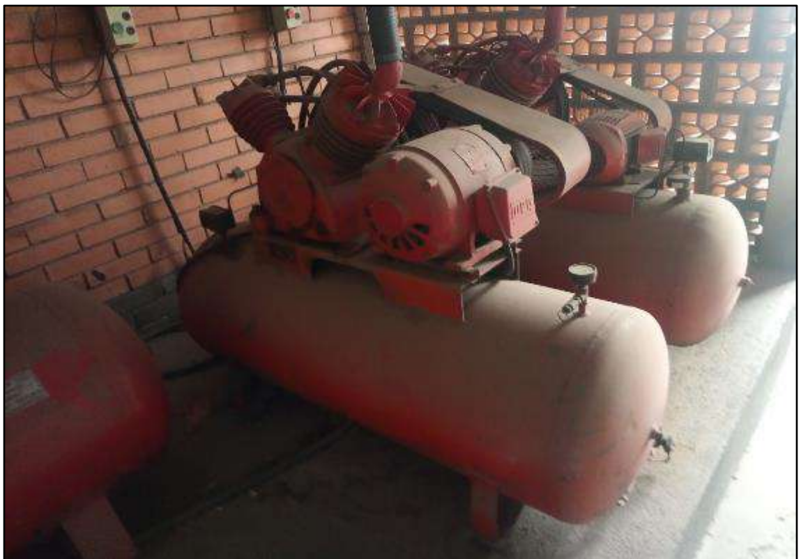
ITEM 1,037 - VISTA DO COMPRESSOR SCHULZ MSV-25/250
