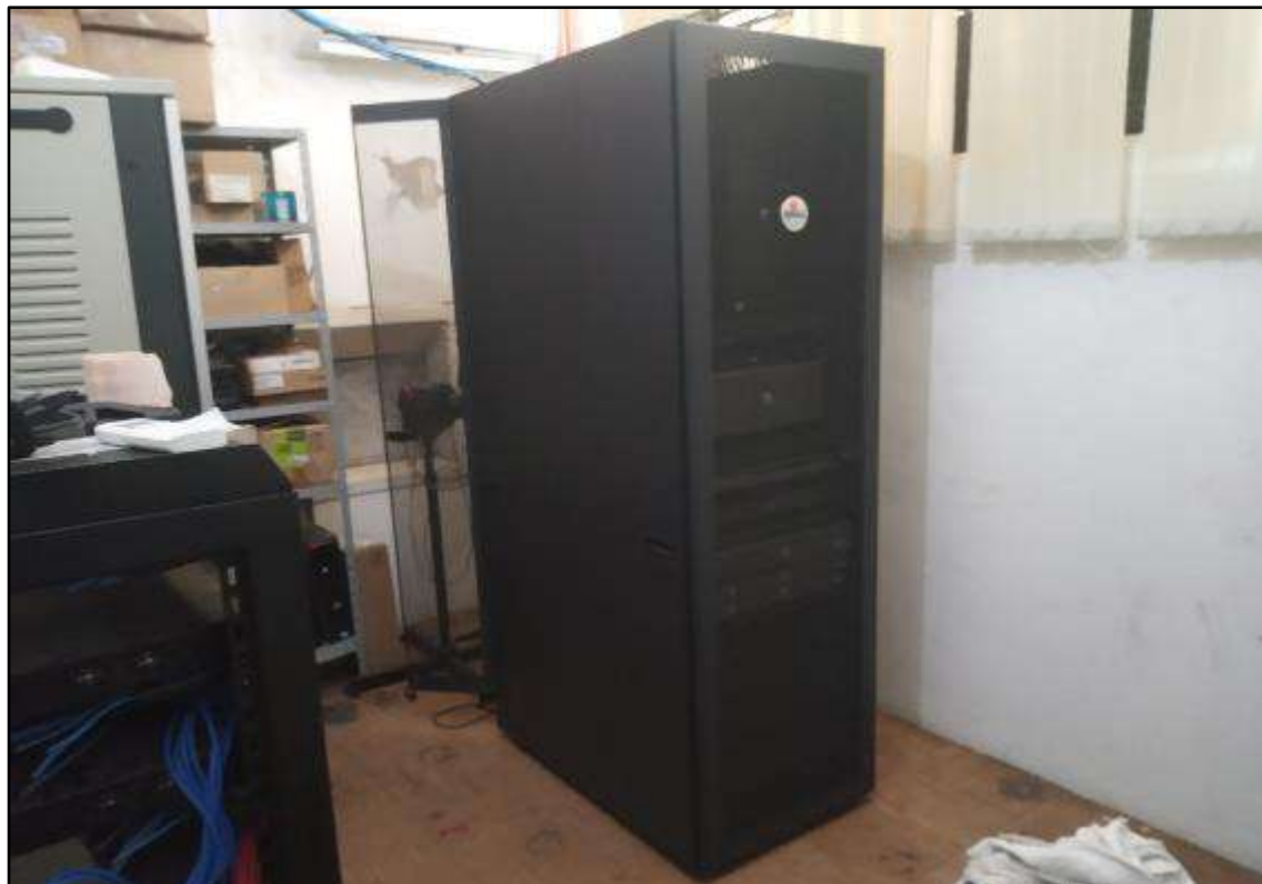
ITEM 3,052 - VISTA DO RACK ALTO DELL
