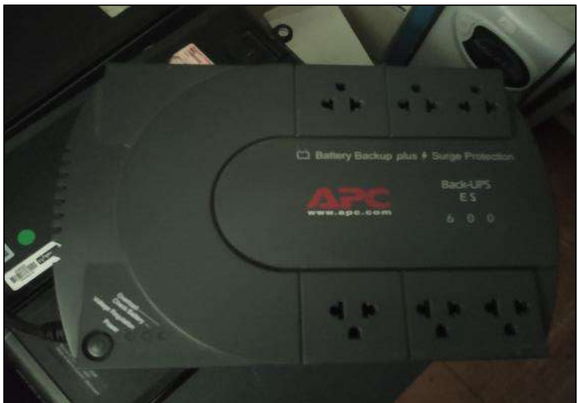
ITEM 3,009 - VISTA DO BACK UP DE BATERIA APC BACK UPS ES 600
