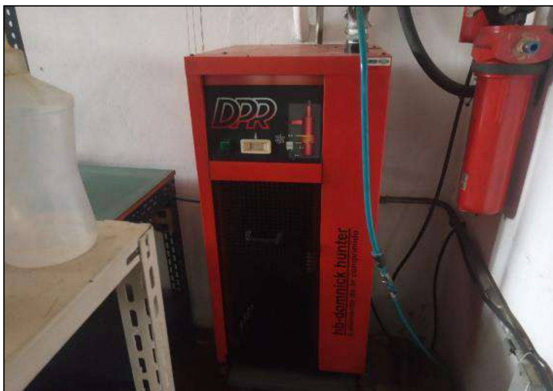
ITEM 1,043 - VISTA DO TRATAMENTO DE AR COMPRIMIDO HB DOMNICK HUNTER
