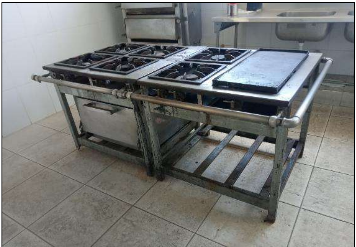
ITEM 2,026 - VISTA DO FOGÃO INDUSTRIAL 6 BOCAS COM FORNO
