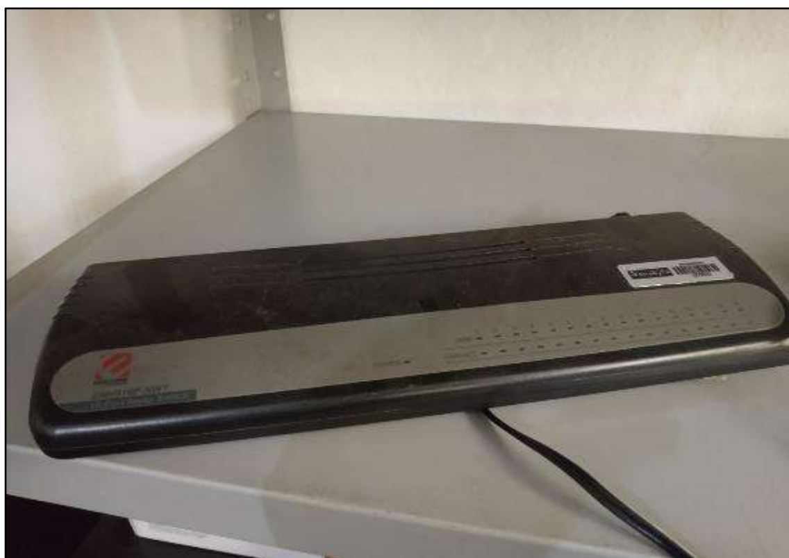
ITEM 3,093 - VISTA DO SWITCH 16 PORTAS ENCORE ENH 916P NWY
