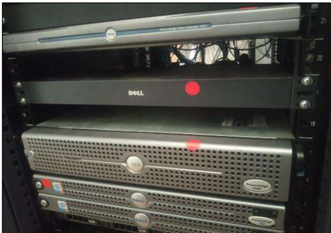
ITEM 3,063 - VISTA DO SWITCH KVM DELL 71PXP
