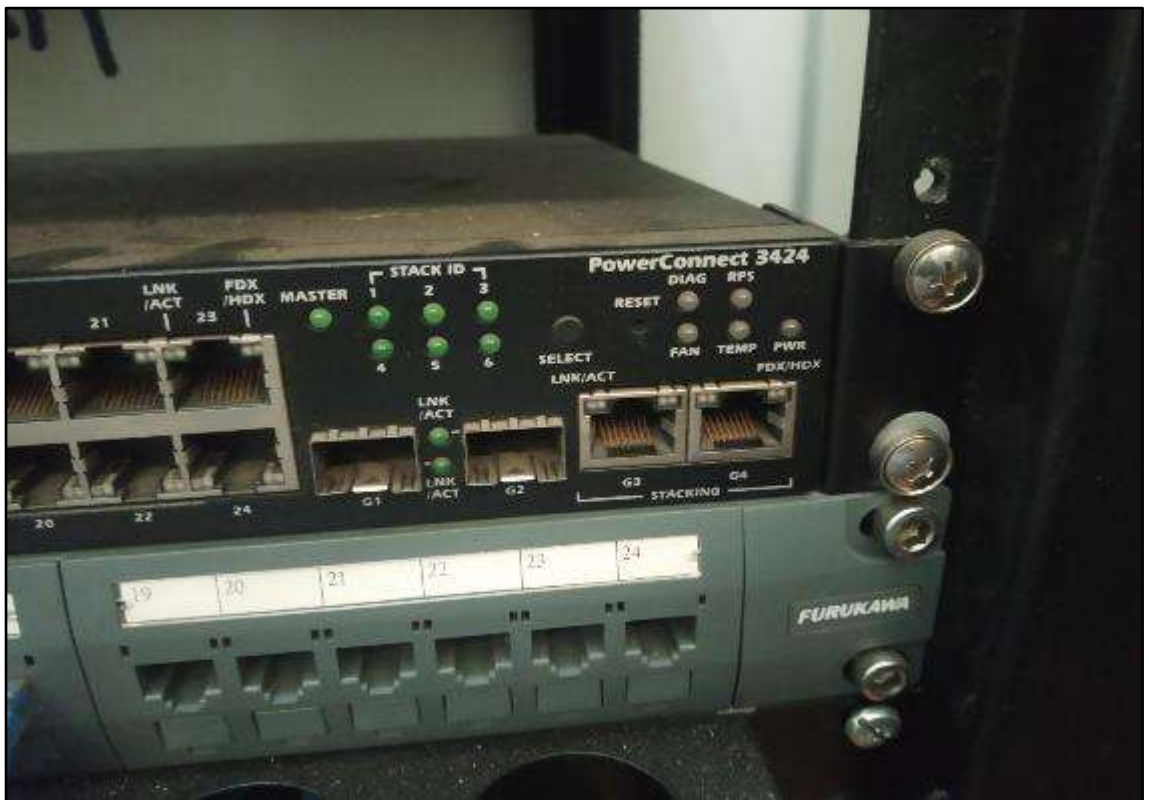
ITEM 3,040 - VISTA DO SWITCH DELL POWERCONNECT 3424
