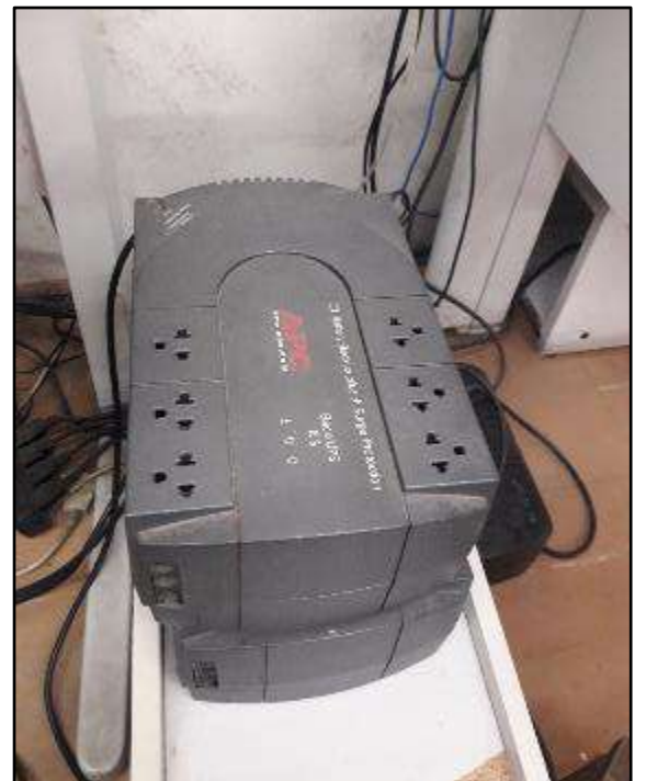
ITEM 3,143 - VISTA DO BACK UP DE BATERIA APC BACK UPS ES 600
