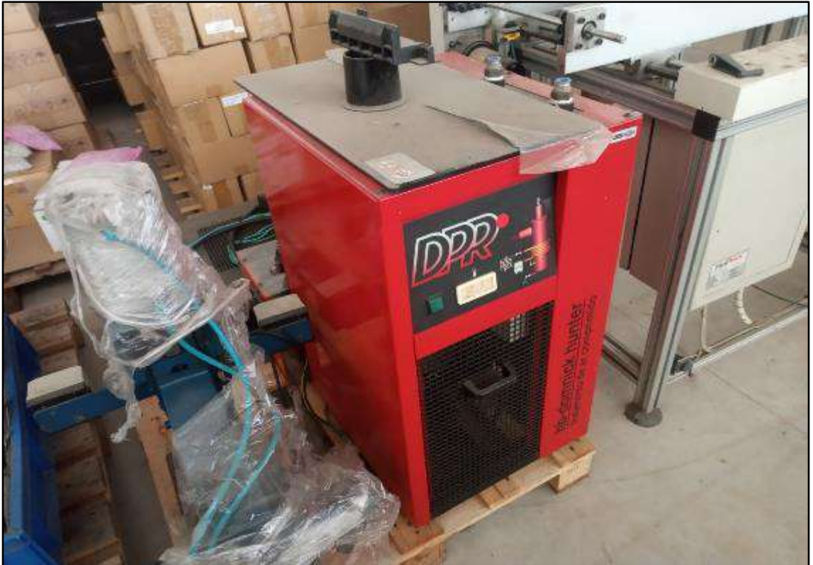
ITEM 1,025 - VISTA DO TRATAMENTO DE AR COMPRIMIDO HB DOMNICK HUNTER DPR 0020 SÉRIE: 101333/05
