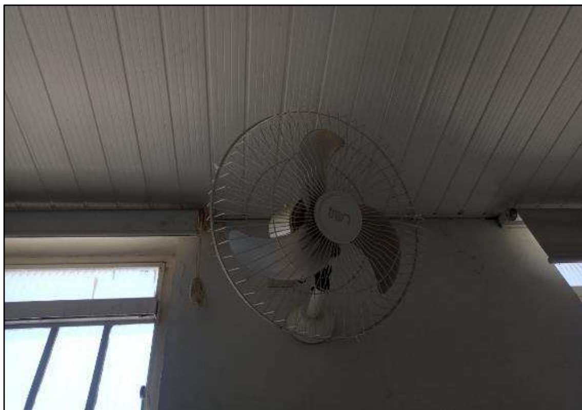
ITEM 2,004 - VISTA DO VENTILADOR DE PAREDE TRON
