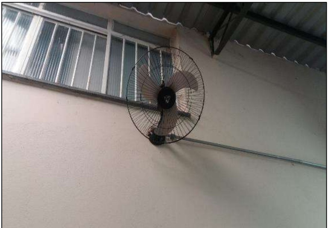
ITEM 2,177 - VISTA DO VENTILADOR DE PAREDE
