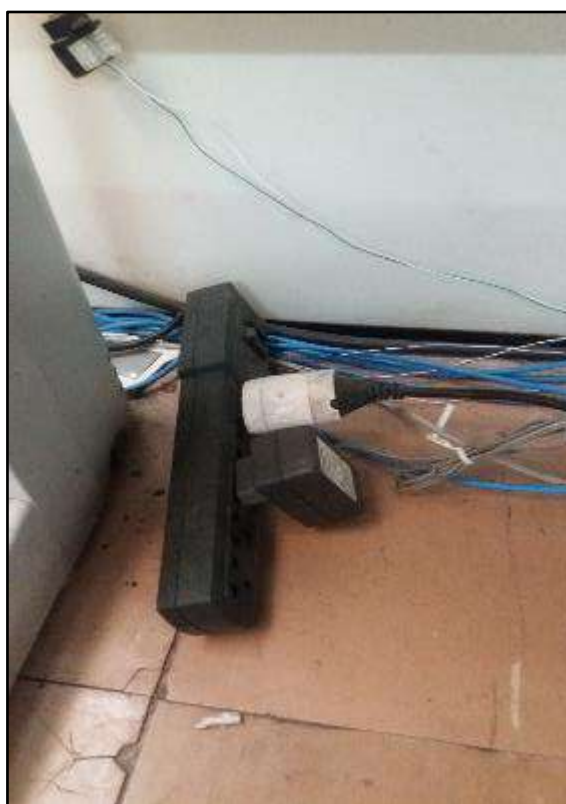
ITEM 3,173 - VISTA DO FILTRO DE LINHA
