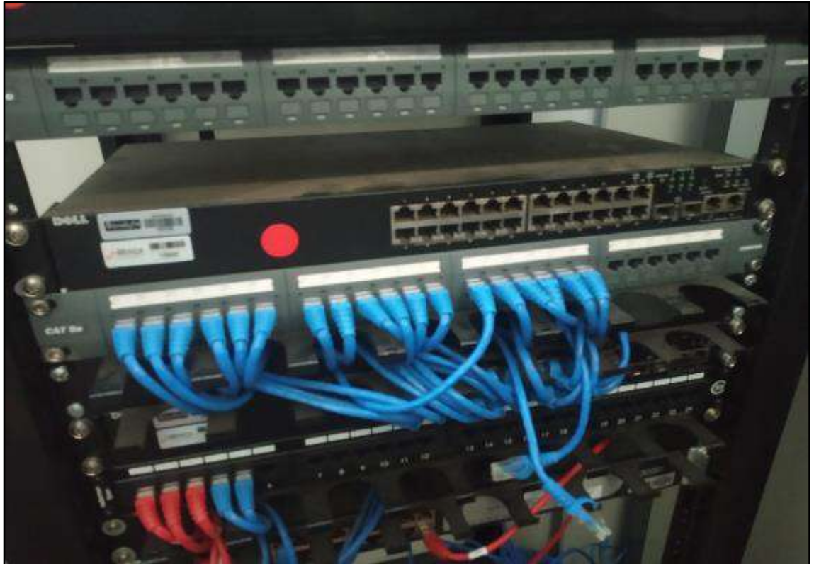
ITEM 3,040 - VISTA DO SWITCH DELL POWERCONNECT 3424
