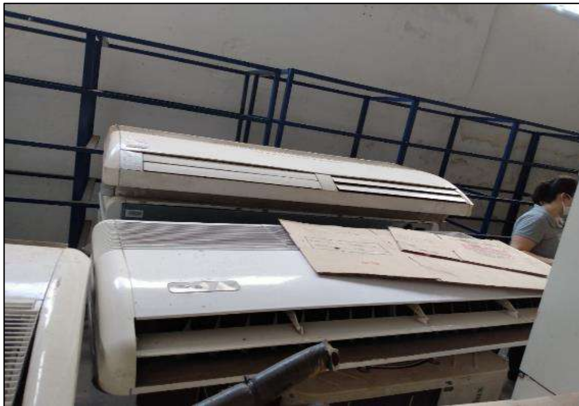
ITEM 2,114 - VISTA DO AR CONDICIONADO
