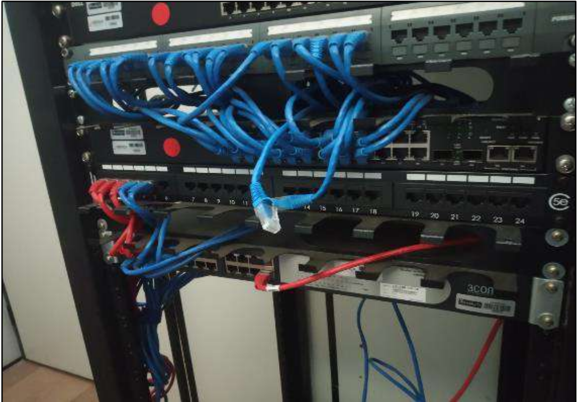
ITEM 3,041 - VISTA DO SWITCH DELL POWERCONNECT 3424
