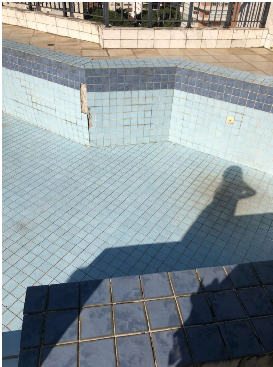
FOTO Nº 41 – Detalhe do deslocamento do revestimento.
