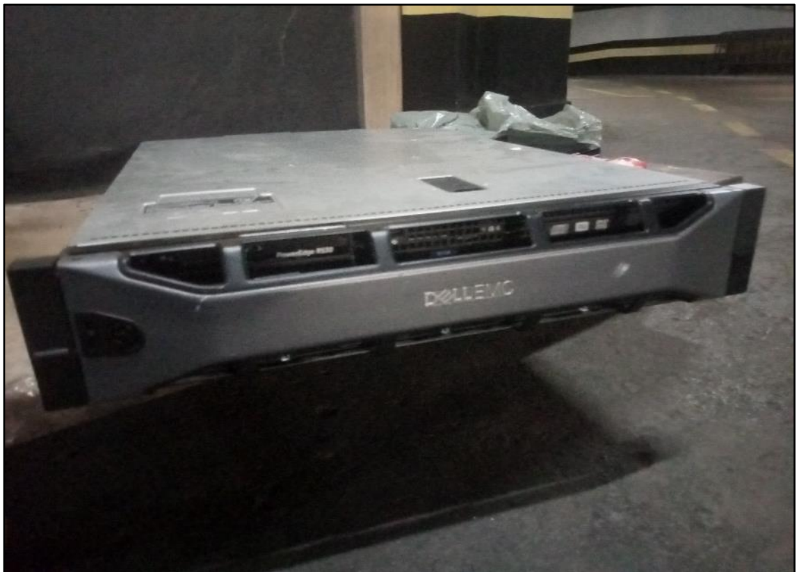
ITEM 2,020 - SERVIDOR DELL POWER EDGE R530
