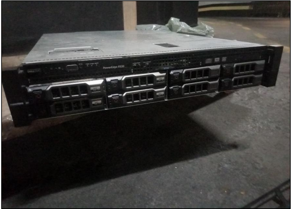
ITEM 2,020 - SERVIDOR DELL POWER EDGE R530
