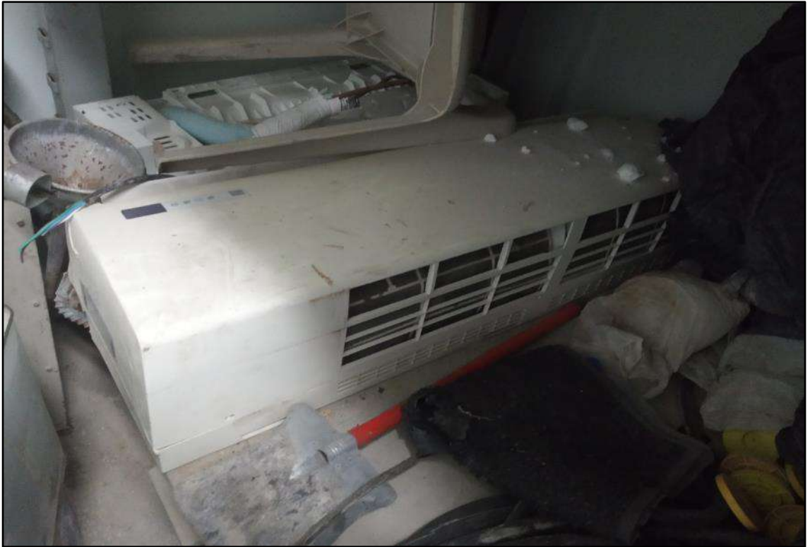
ITEM 2,006 - VISTA DO AR CONDICIONADO 22000BTU CARRIER
