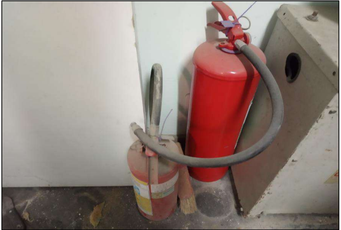
ITEM 5,001 - VISTA DO EXTINTOR
