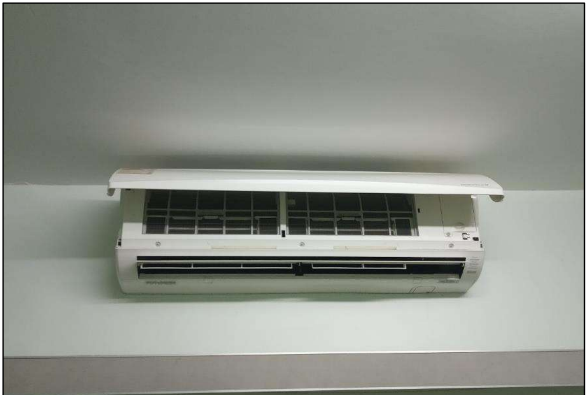
ITEM 2,026 - VISTA DO AR CONDICIONADO LG INVERTER
