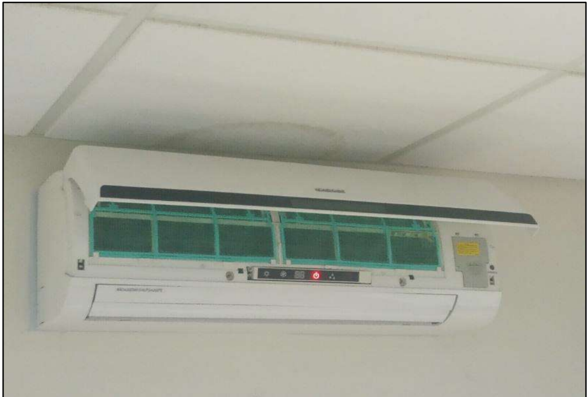
ITEM 2,016 - VISTA DO AR CONDICIONADO GREE
