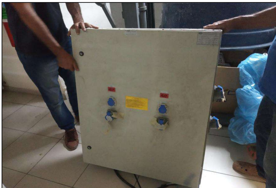
ITEM 1,010 - VISTA DO QUADRO DE LUZ MABITEC
