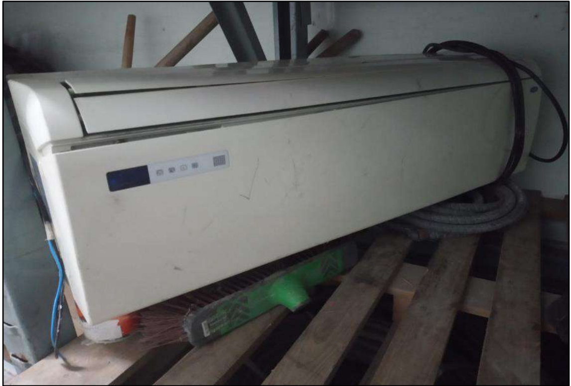
ITEM 2,005 - VISTA DO AR CONDICIONADO 22000BTU CARRIER
