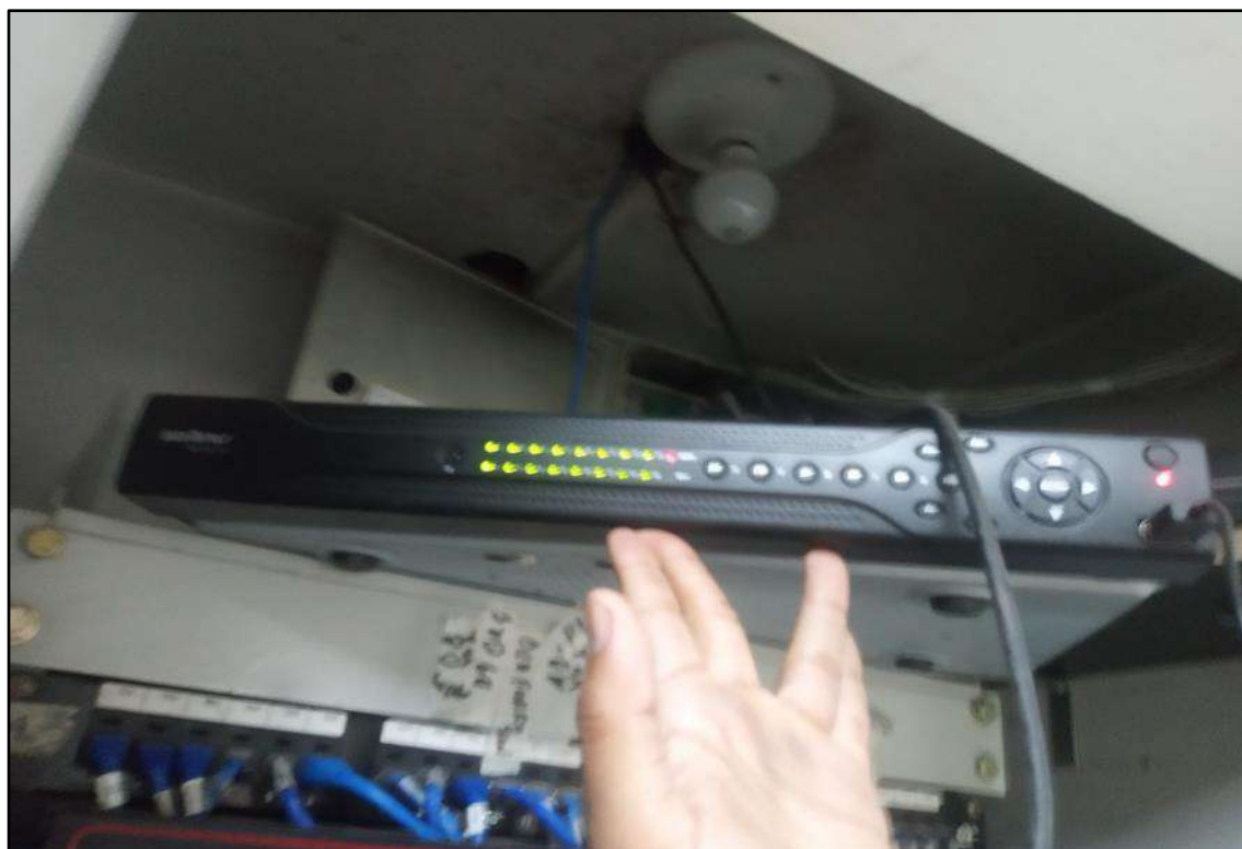
ITEM 3,021 - VISTA DO DVR INTELBRAS VD 16E 480 C
