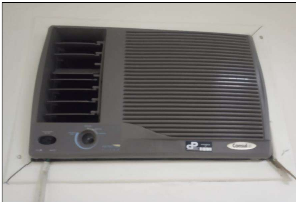
ITEM 2,018 - VISTA DO AR CONDICIONADO CONSUL
