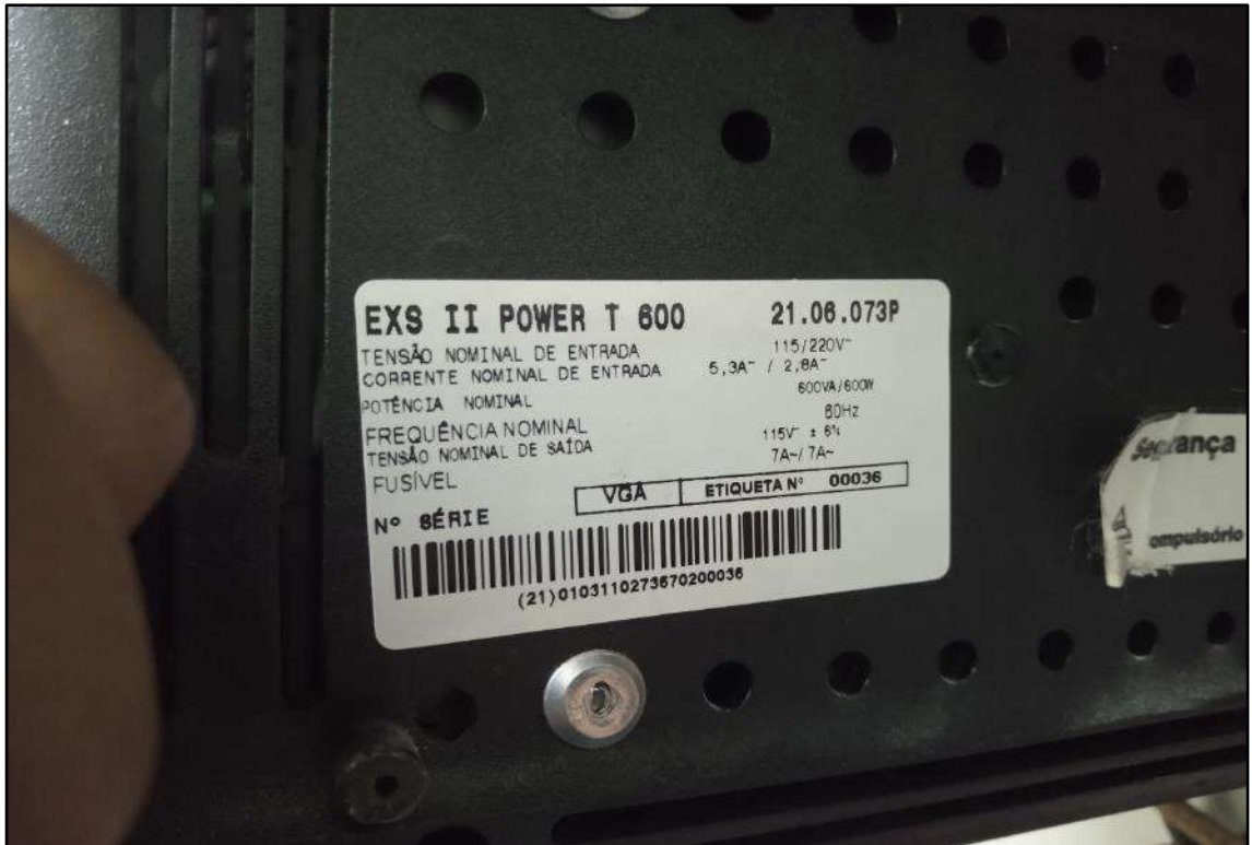
ITEM 3,013 - VISTA DA PLACA DE IDENTIFICAÇÃO DO ESTABILIZADOR ENERMAX EXS II POWER T 600
