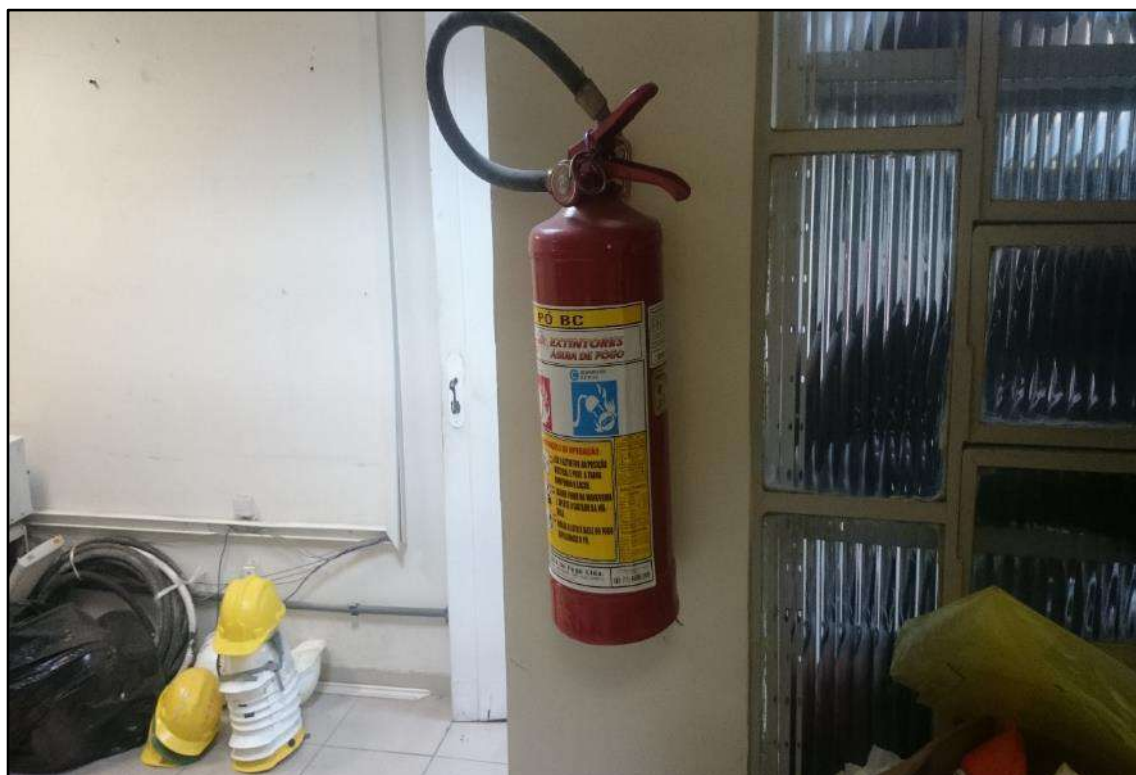
ITEM 5,069 - VISTA DOS EXTINTORES
