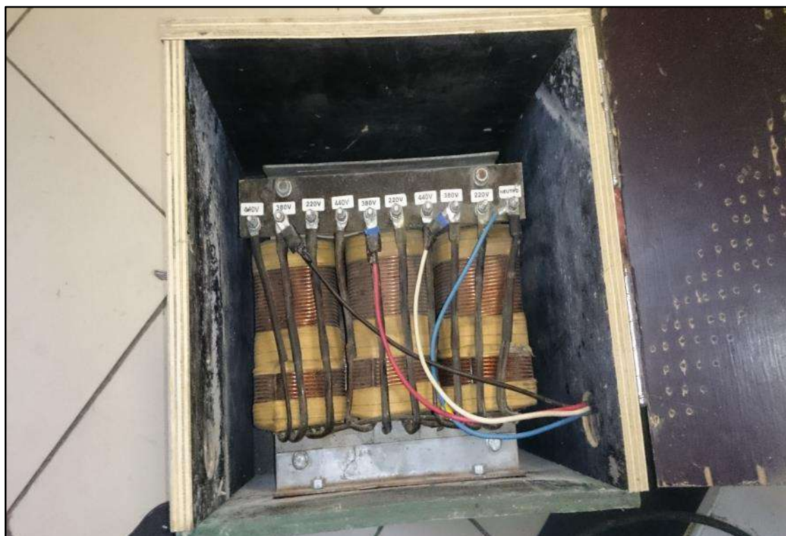
ITEM 1,038 - VISTA DO TRANSFORMADOR
