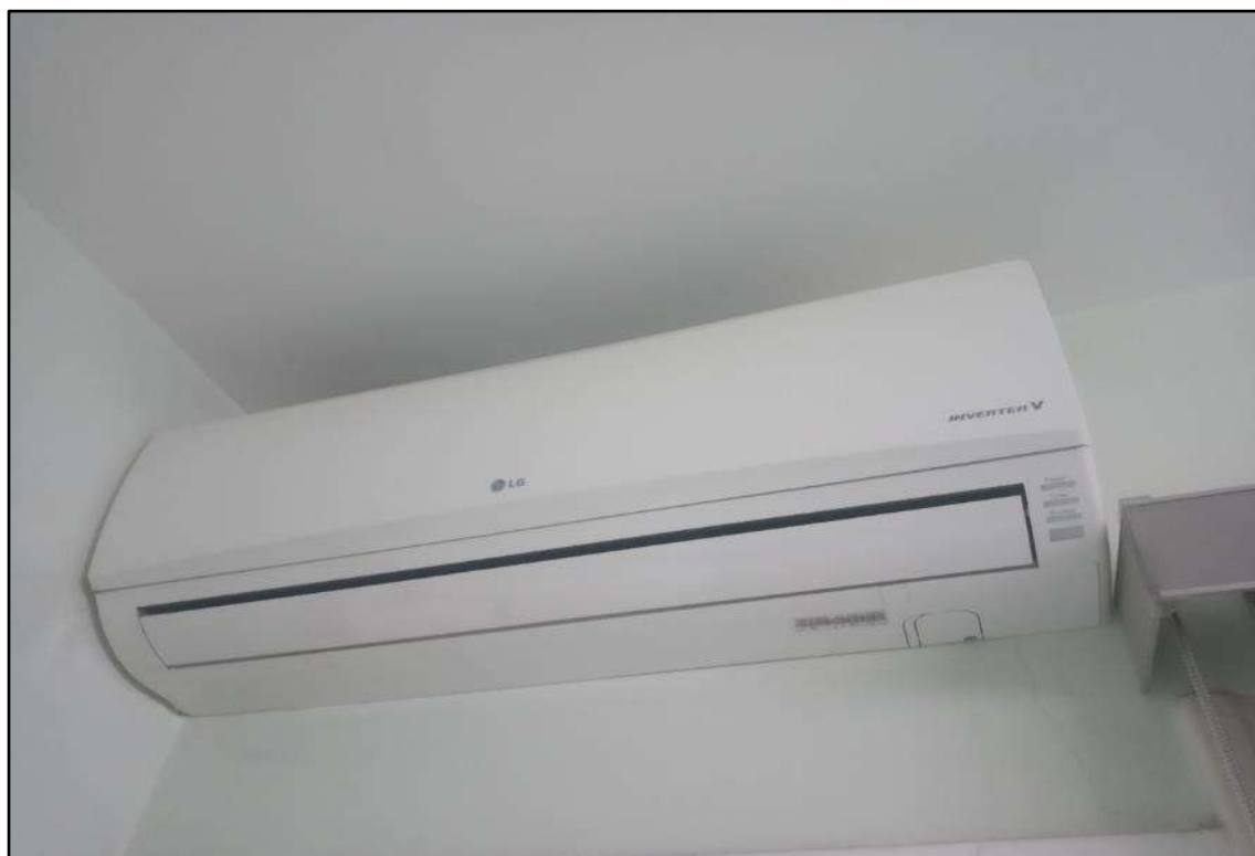
ITEM 2,029 - VISTA DO AR CONDICIONADO LG INVERTER
