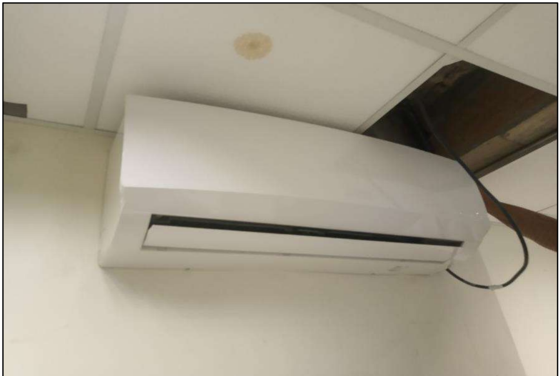
ITEM 2,023 - VISTA DO AR CONDICIONADO PHILCO
