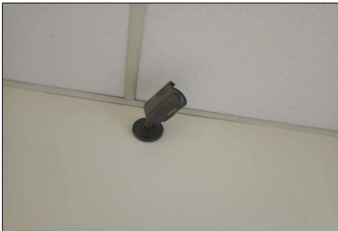
ITEM 3,028 - VISTA DA CAMERA INTELBRAS
