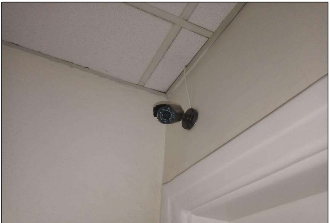
ITEM 3,028 - VISTA DA CAMERA INTELBRAS
