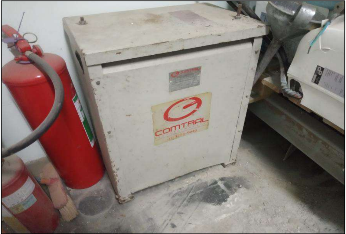
ITEM 1,001 - VISTA DO TRANSFORMADOR COMTRAL
