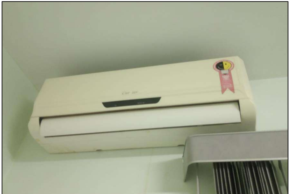
ITEM 2,021 - VISTA DO AR CONDICIONADO CARRIER
