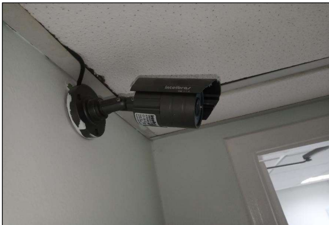
ITEM 3,028 - VISTA DA CAMERA INTELBRAS
