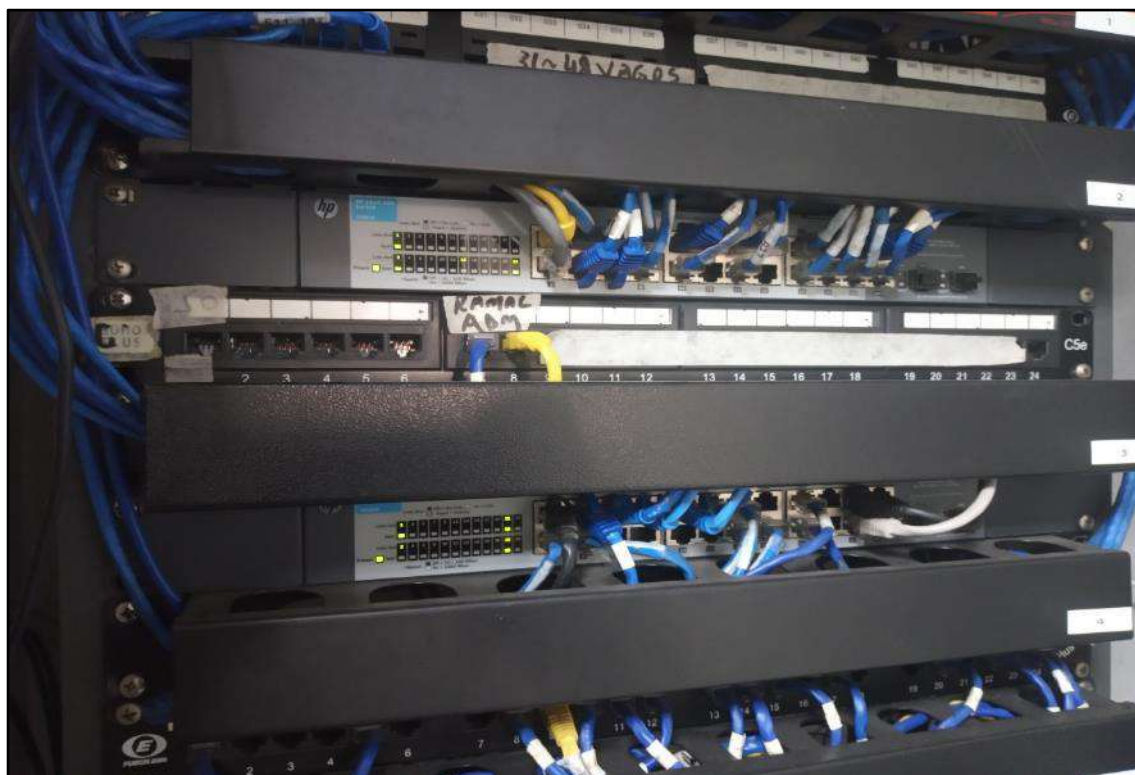
ITEM 3,022 - VISTA DO SWITCH HP 1410-24G
