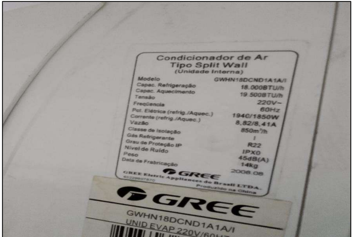
ITEM 2,025 - VISTA DO AR CONDICIONADO GREE
