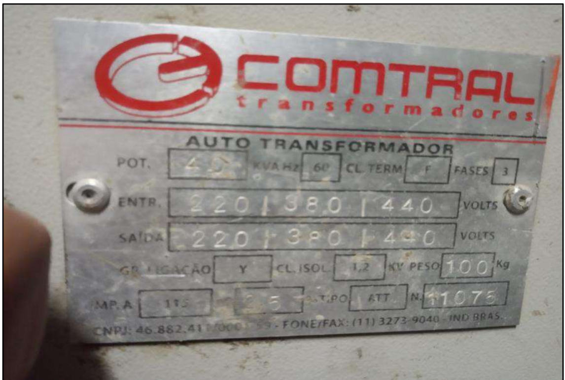
ITEM 1,001 - VISTA DA PLACA DE IDENTIFICAÇÃO DO TRANSFORMADOR COMTRAL
