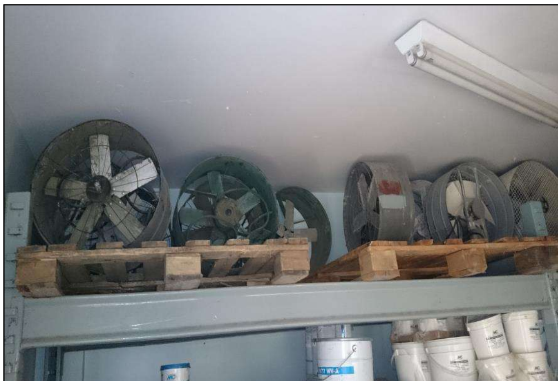
ITEM 1,032 - VISTA DO EXAUSTOR
