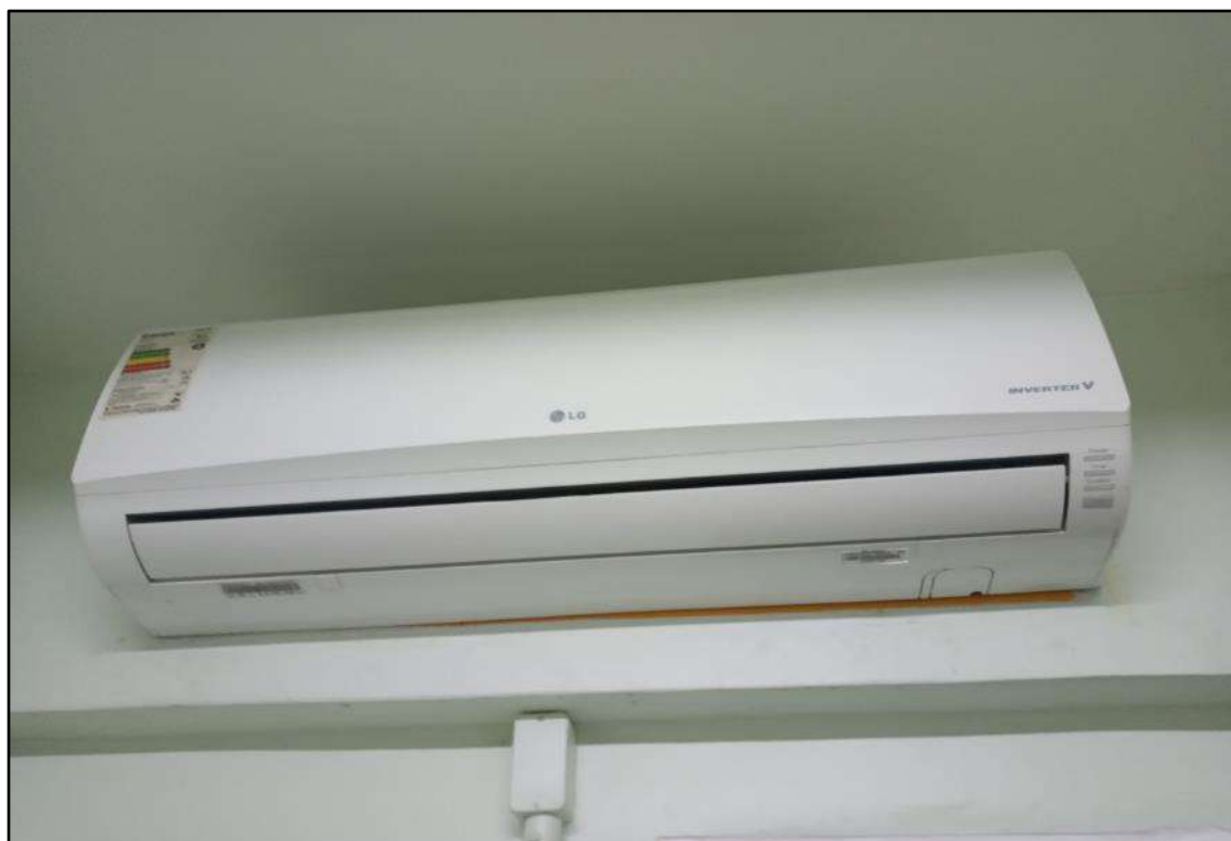
ITEM 2,027 - VISTA DO AR CONDICIONADO LG INVERTER
