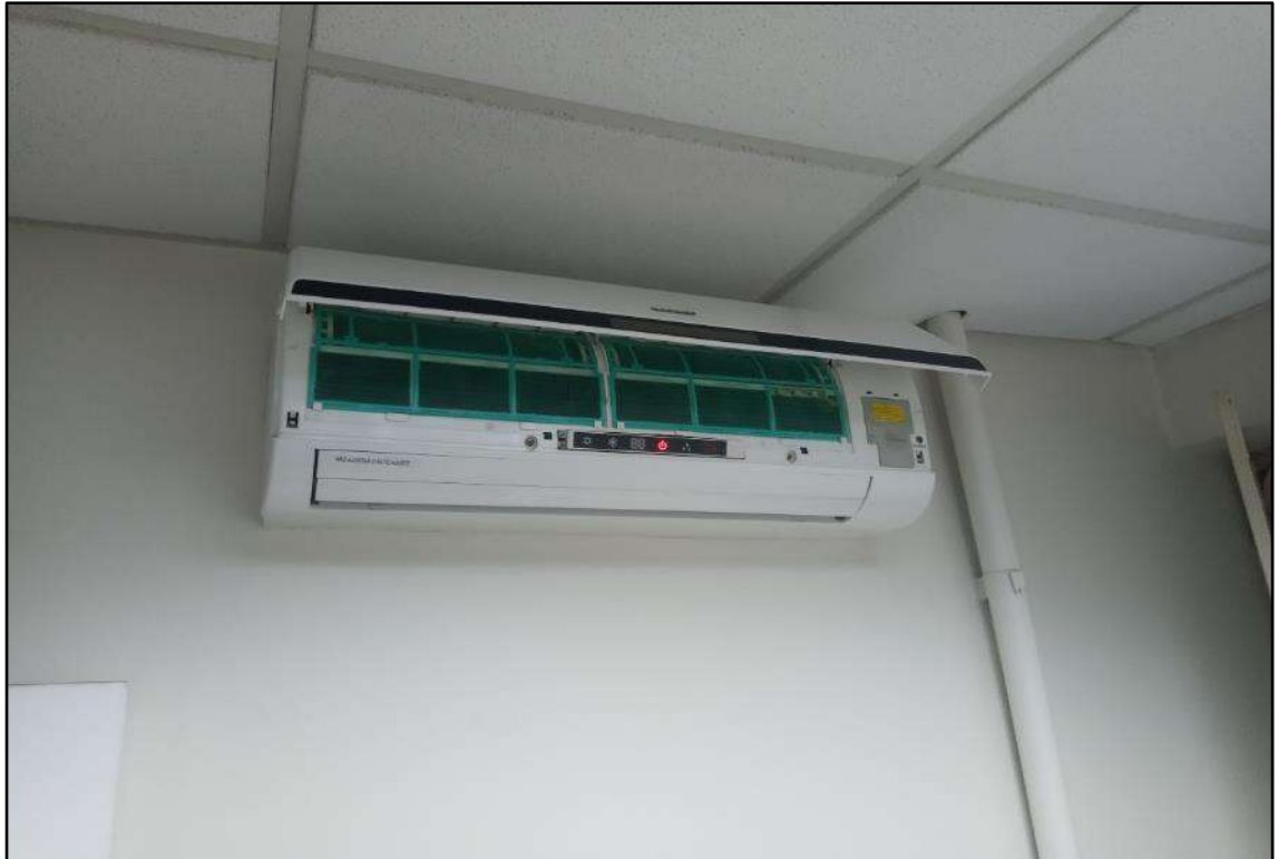
ITEM 2,017 - VISTA DO AR CONDICIONADO GREE
