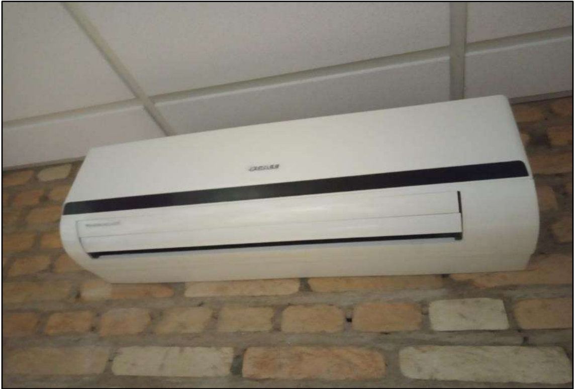
ITEM 2,015 - VISTA DO AR CONDICIONADO GREE
