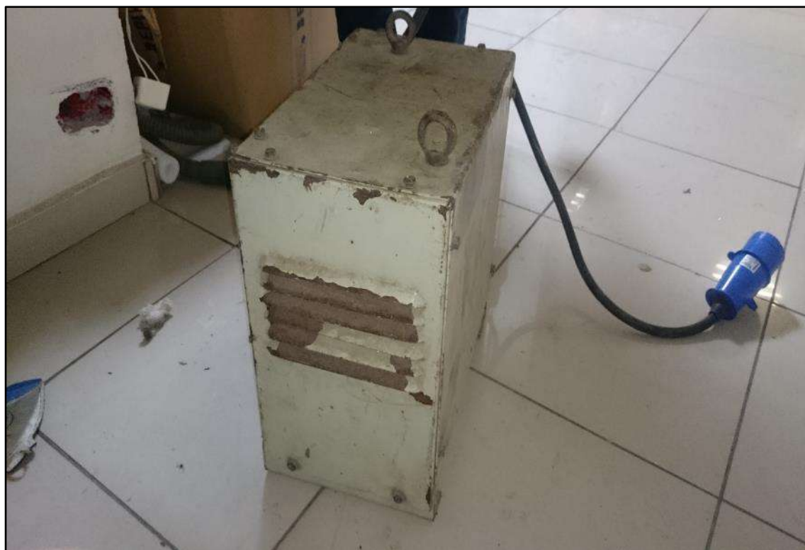
ITEM 1,037 - VISTA DO TRANSFORMADOR
