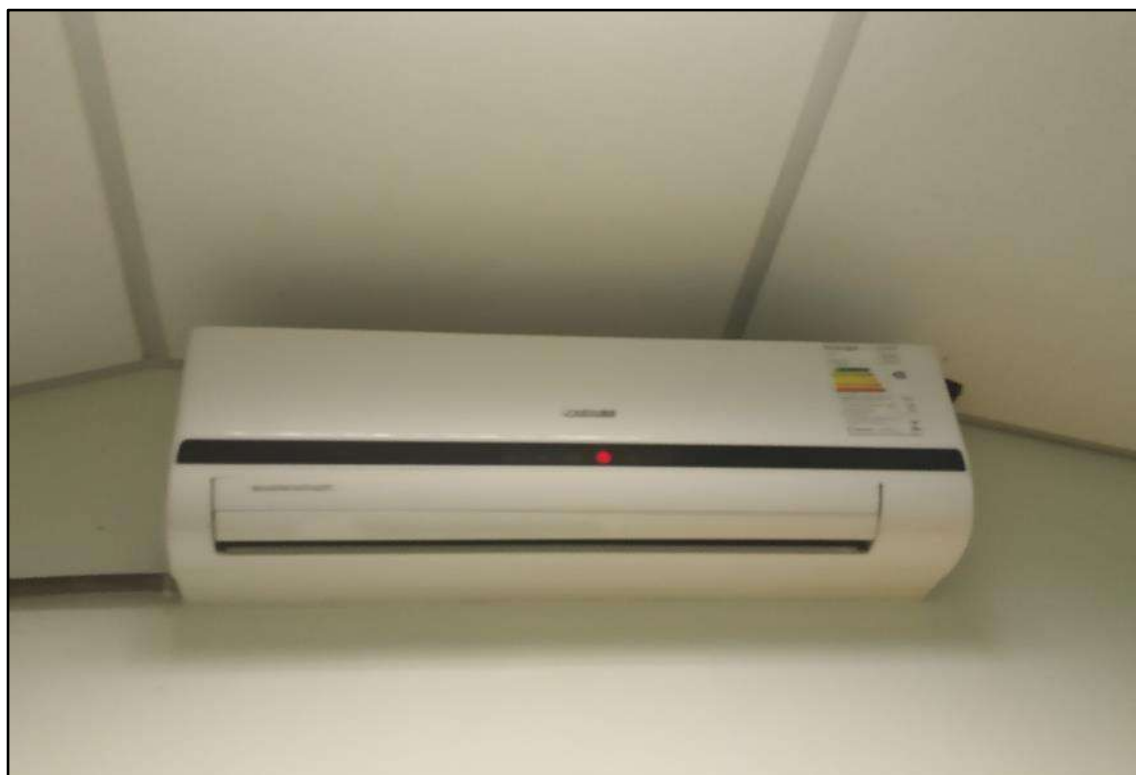
ITEM 2,022 - VISTA DO AR CONDICIONADO GREE
