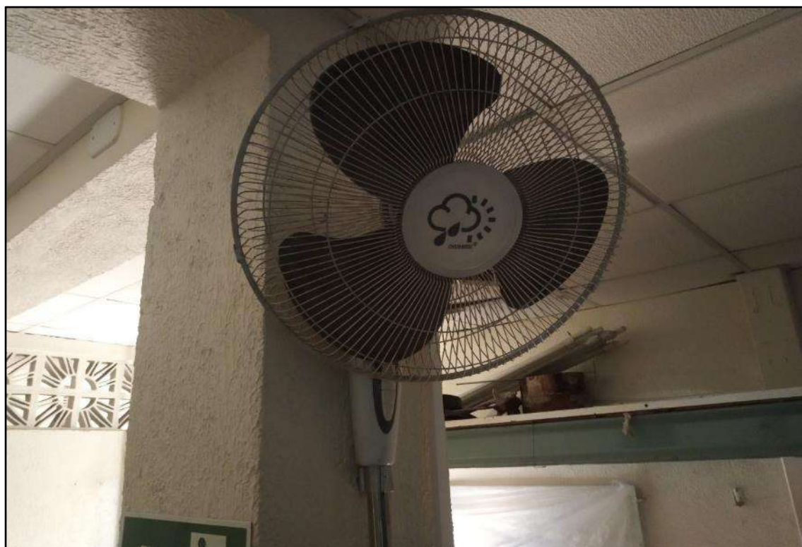
ITEM 2,010 - VISTA DO VENTILADOR DE PAREDE
