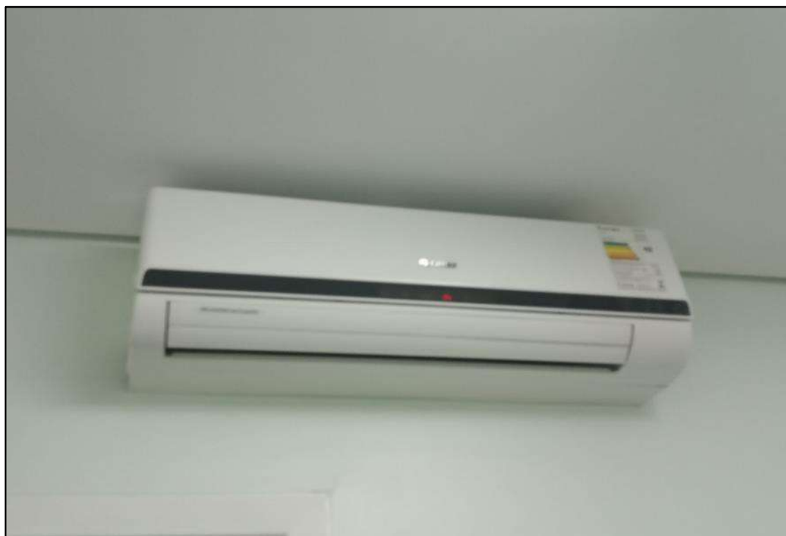
ITEM 2,019 - VISTA DO AR CONDICIONADO GREE
