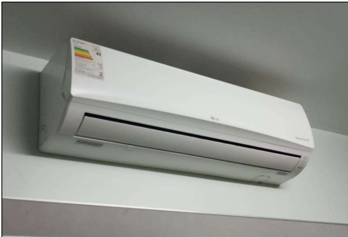
ITEM 2,001 - VISTA DO AR CONDICIONADO LG INVERTER
