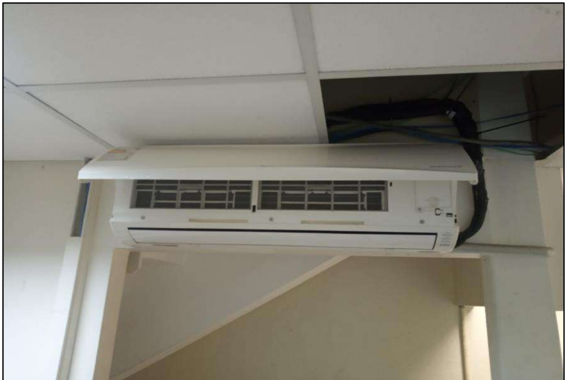
ITEM 2,024 - VISTA DO AR CONDICIONADO LG INVERTER
