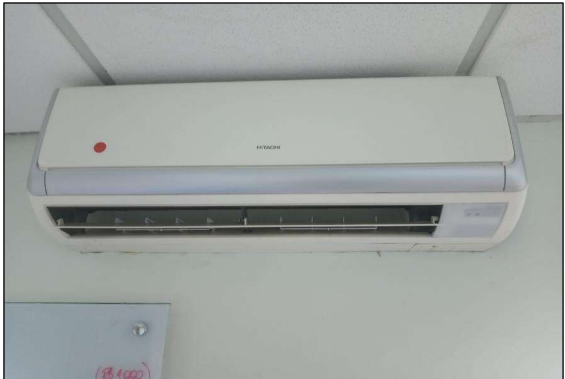
ITEM 2,020 - VISTA DO AR CONDICIONADO HITACHI
