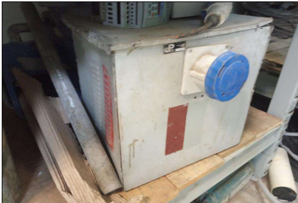
ITEM 1,017 - VISTA DO TRANSFORMADOR ELETRICO 440 P/ 220 VOLTS
