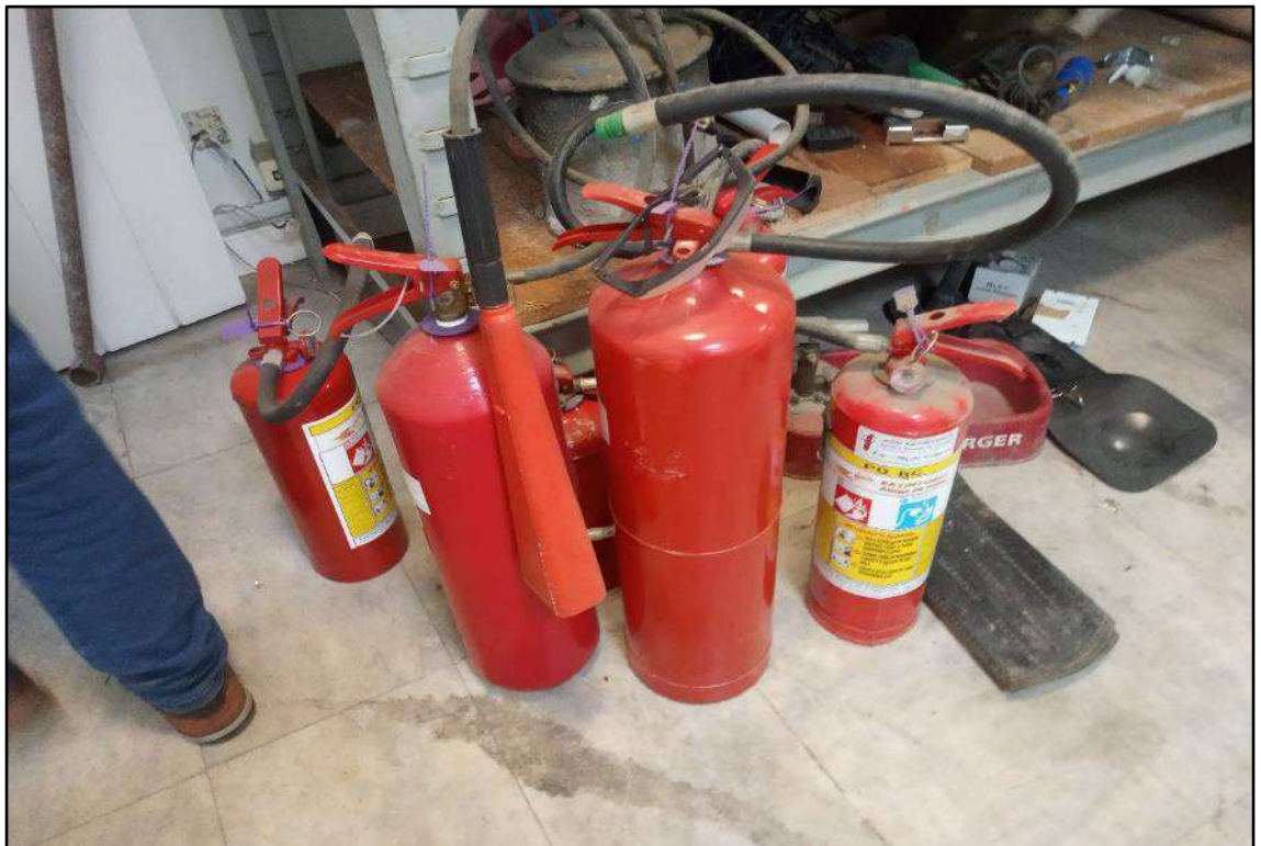
ITEM 5,001 - VISTA DO EXTINTOR
