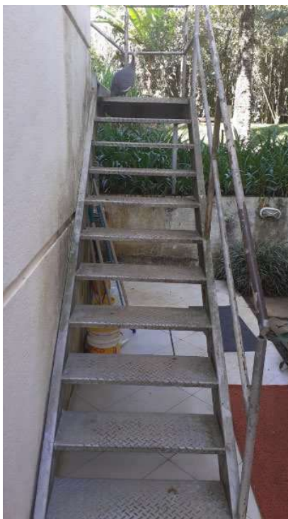
Foto 73 - Vista da escada de acesso ao segundo pavimento do imóvel registrado sob a Matrícula nº. 166.451.
