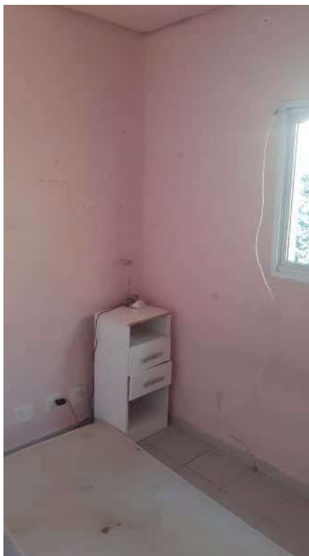
Foto 81 - Vista do terceiro dormitório do imóvel registrado sob a Matrícula nº. 166.451.
