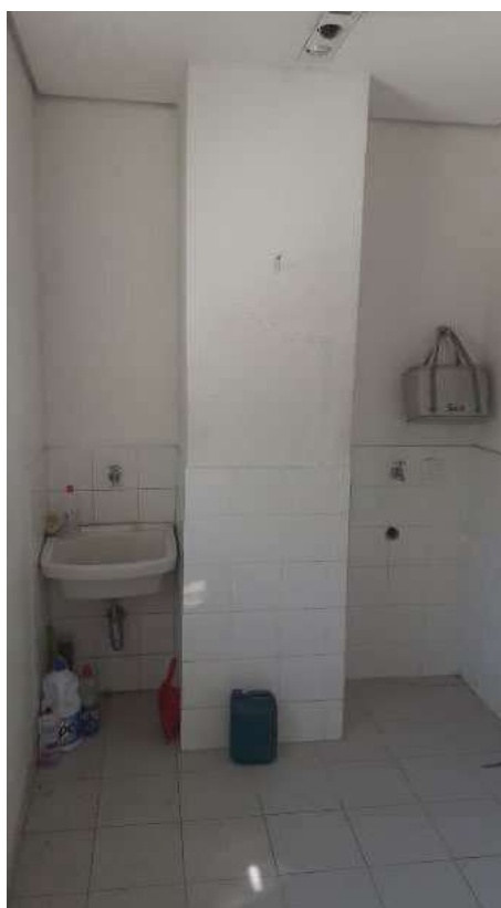
Foto 80 - Vista da área de serviços do segundo pavimento do imóvel registrado sob a Matrícula nº. 166.451.
