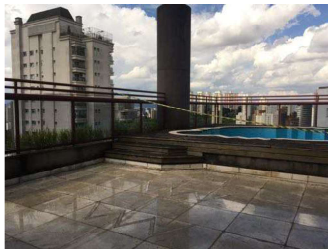
Foto 6: vista da piscina, localizada no 14º andar, notando-se na imagem que aquela área recreativa encontra-se protegida por fita de segurança zebreada, em decorrência do deck de madeira apresentar peças soltas e piscina exibir trincas em suas paredes internas.
