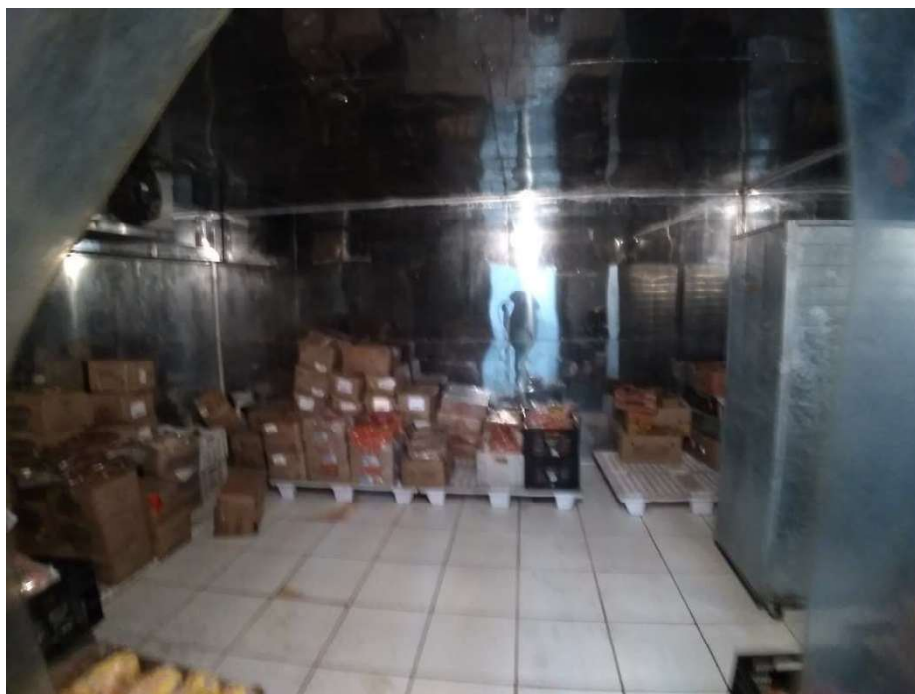
VISTA DA CABINE PRIMÁRIA.
