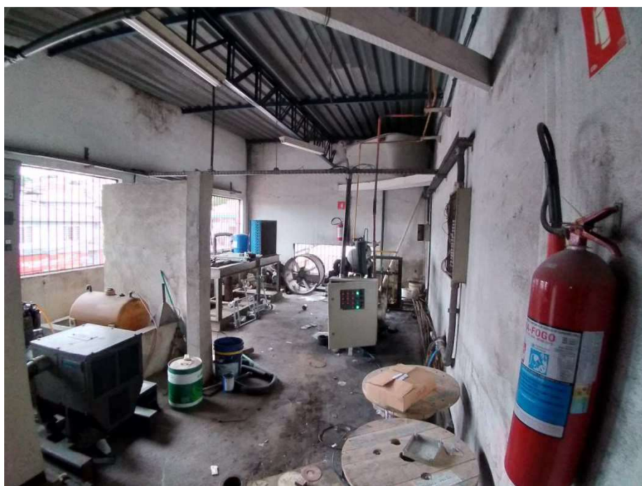
VISTA DA SALA DE MÁQUINAS.
