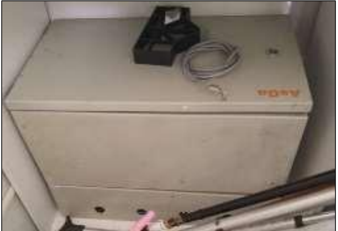
ITEM 11,077 - SWITCH PARA ATENDIMENTO AO SISTEMA DE TELECOMUNICAÇÕES
