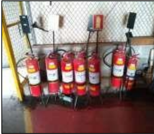
ITEM 14,035 E 14,036 - EXTINTOR TIPO A E EXTINTOR TIPO BC
