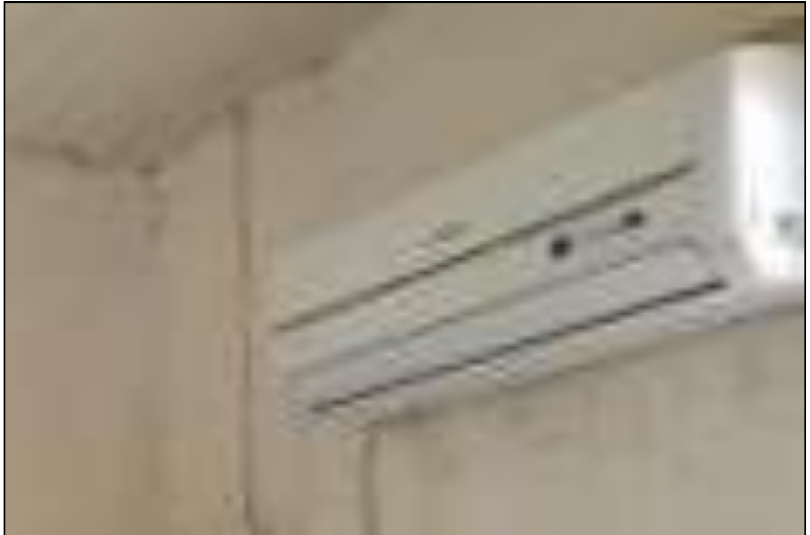
ITEM 15,005 - AR CONDICIONADO SPLIT
