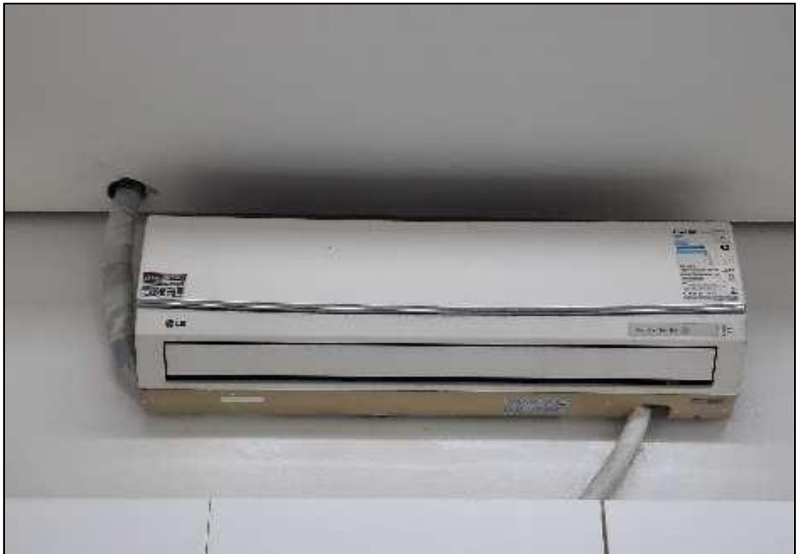
ITEM 9,006 - AR CONDICIONADO SPLIT
