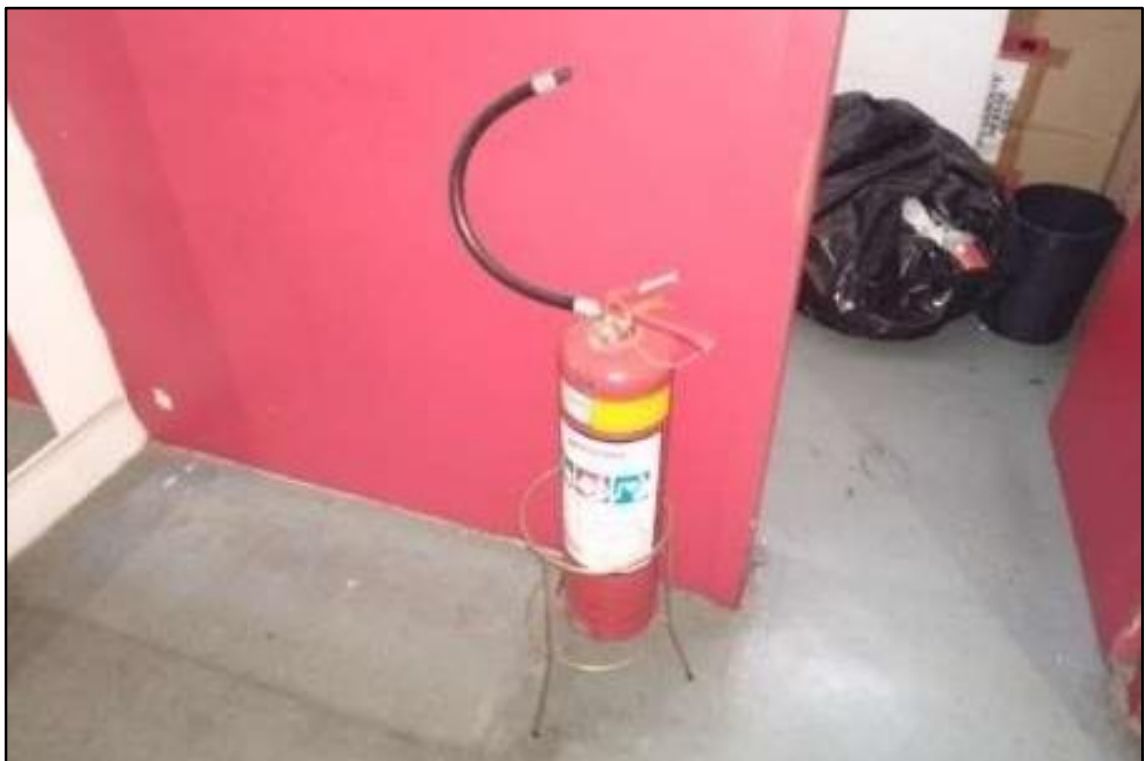
ITEM 11,094 - EXTINTOR DE INCÊNDIO
