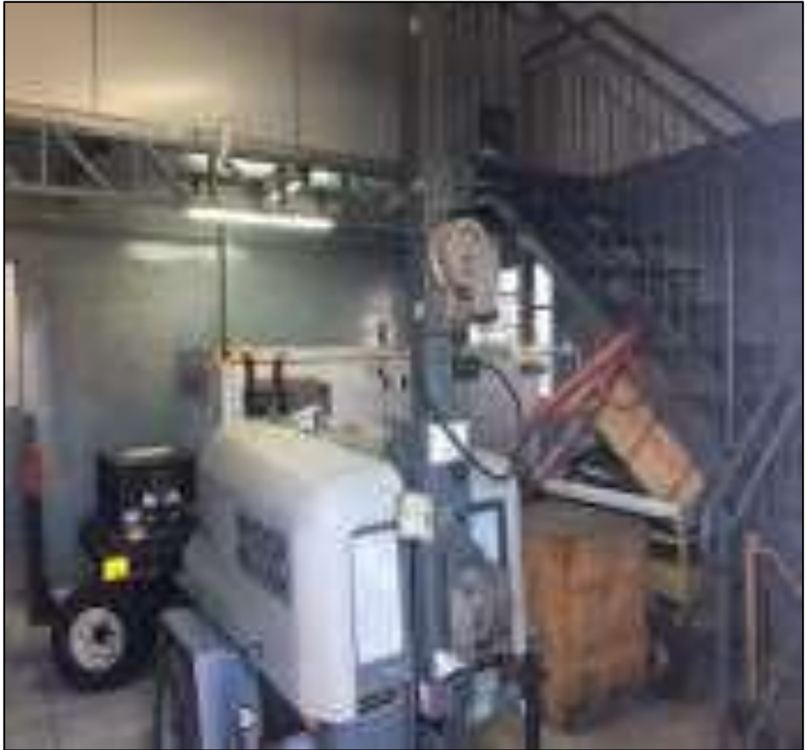
ITEM 14,005 E 14,006 - GERADOR DE ENERGIA MARCA HOBART POTENCIA 90 KVA E TORRE DE ILUMINAÇÃO WACKER NEUSON LTN 6L
