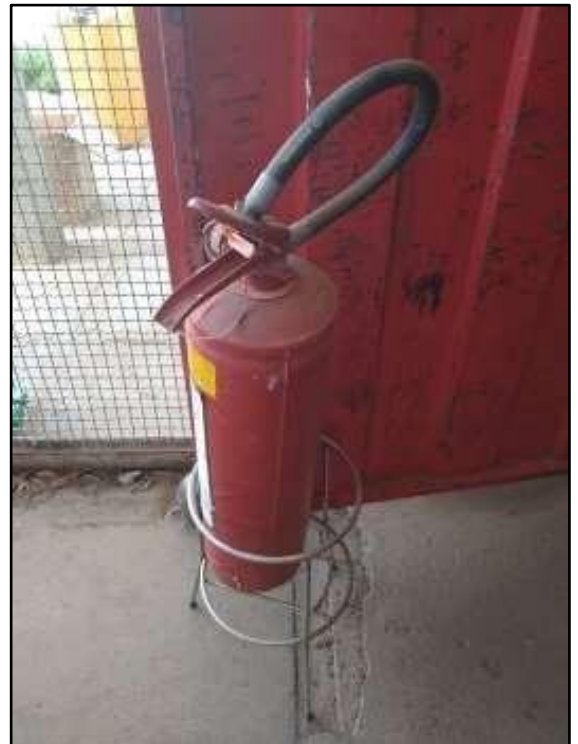
ITEM 11,013 - EXTINTOR DE INCÊNDIO
