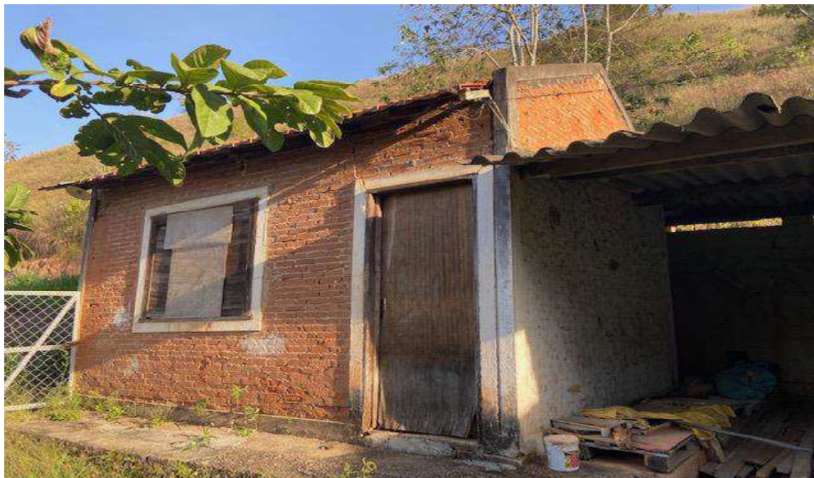
Foto 16 – Fachada da área edificada com estado de conservação ruim
