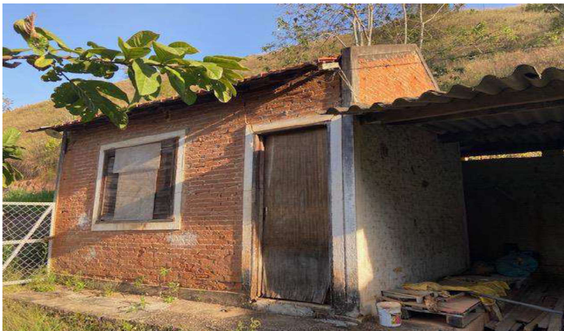
Foto 3 – Construção com estado de conservação ruim
