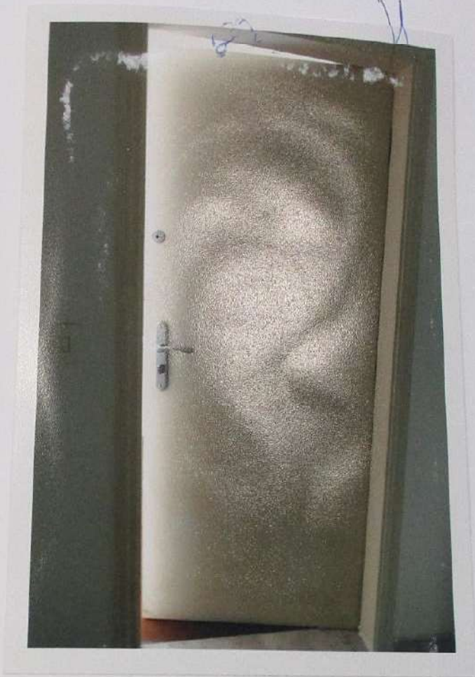
VISTA DA PORTA SOCIAL QUE DÁ ACESSO AO APARTAMENTO DE Nº 51 DO BLOCO "2", EDIFÍCIO ORQUÍDEA.
