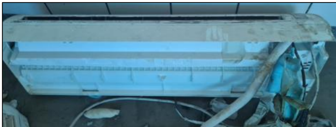
ITEM 1,006 - APARELHOS DE AR CONDICIONADO MARCA: SAMSUNG MODELO: AS24UBTNXAZ
