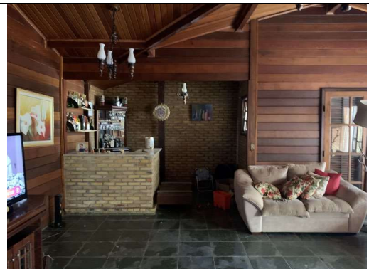
Foto 08. Detalhe do piso da sala deteriorado
