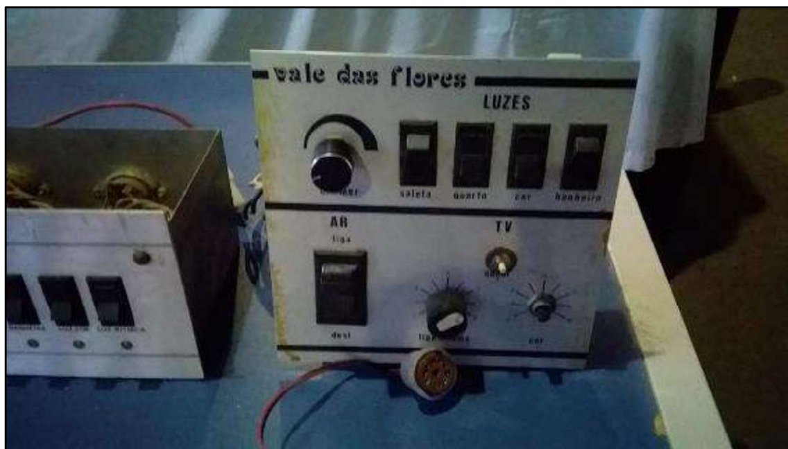
ITEM 2,050 AO ITEM 2,054 - VISTA DOS PAINÉIS DIVERSOS DE CABECEIRA DE COMANDO DE AR, LUZ, TV E MÚSICA DOS QUARTOS
