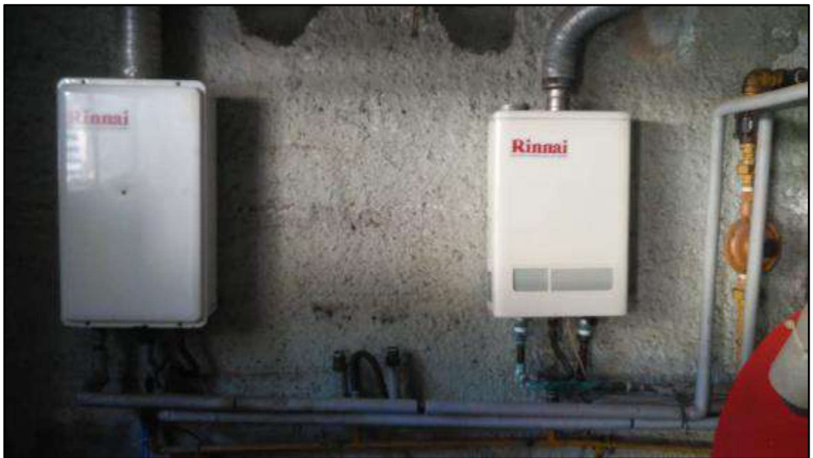
ITEM 2,004 - VISTA DOS AQUECEDORES DA MARCA RINNAI
