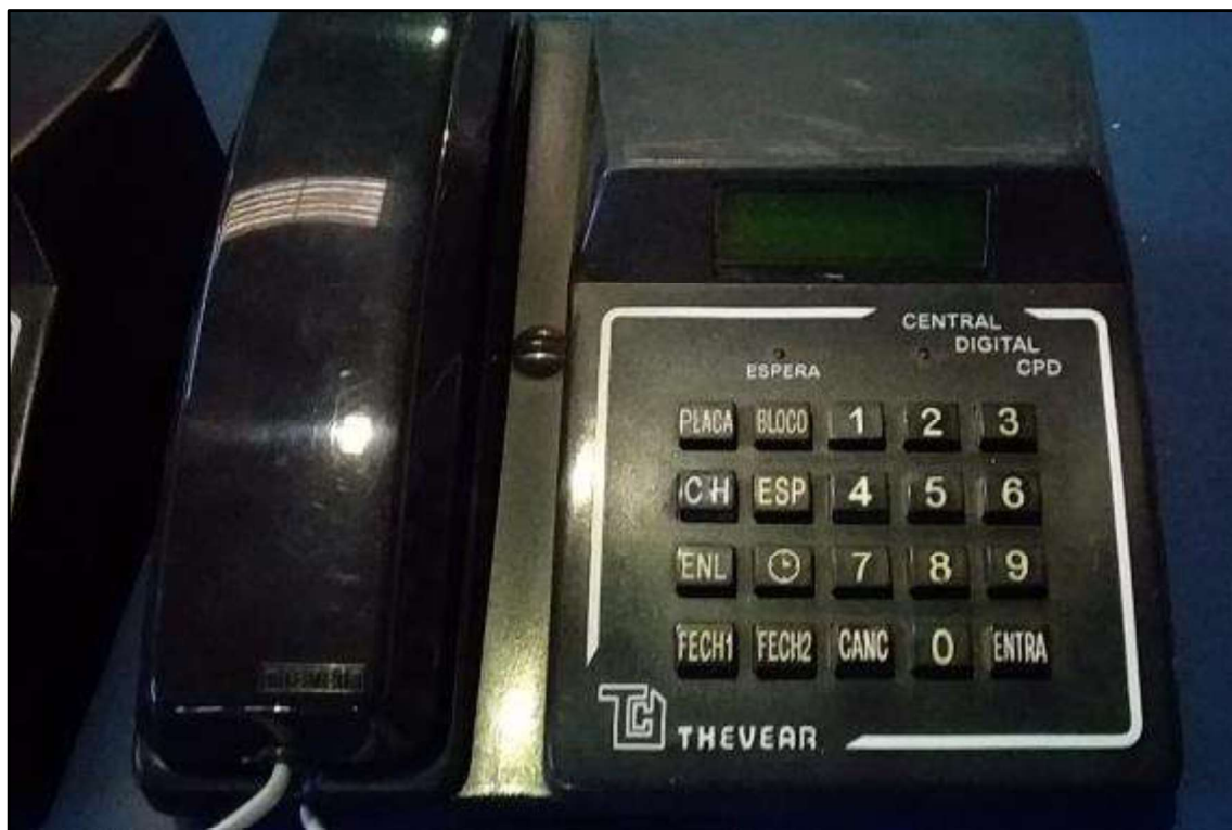
ITEM 2,056 - VISTA DO SISTEMA DE INTERFONES COM CENTRAL DA MARCA THEVEAR
