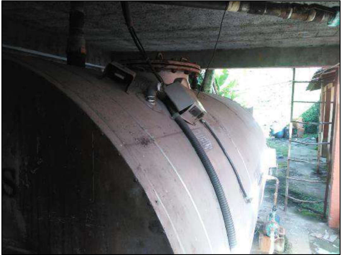
ITEM 1,003 - VISTA DA CALDEIRA A DIESEL THERMUS
