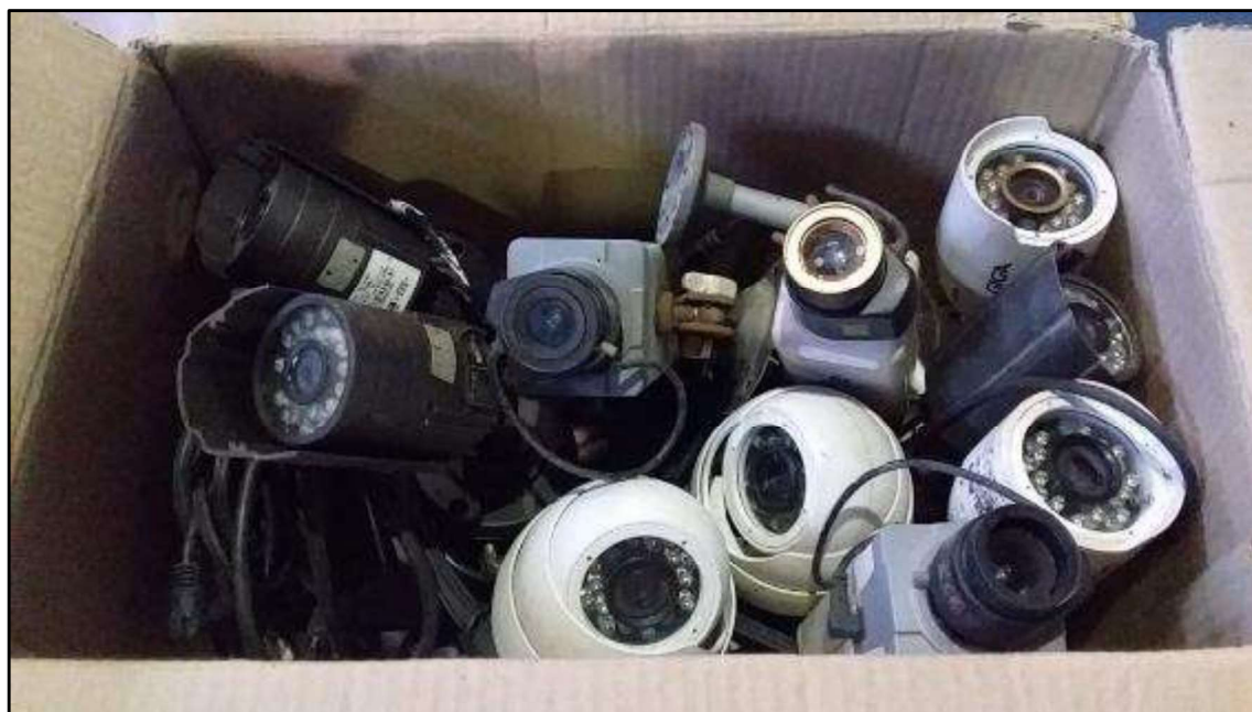
ITEM 3,003 - VISTA DAS CAMERAS DE SEGURANÇA
