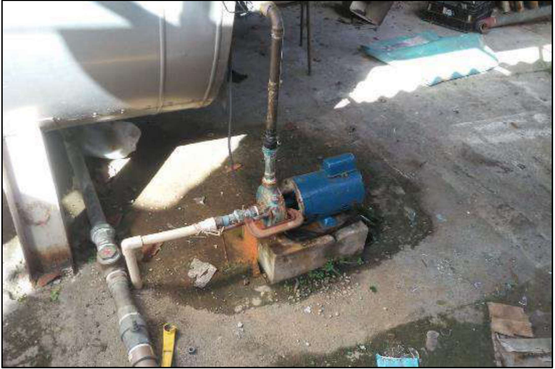
ITEM 1,001 - VISTA DAS BOMBAS DE PRESSÃO DA MARCA GRUNDFOS
