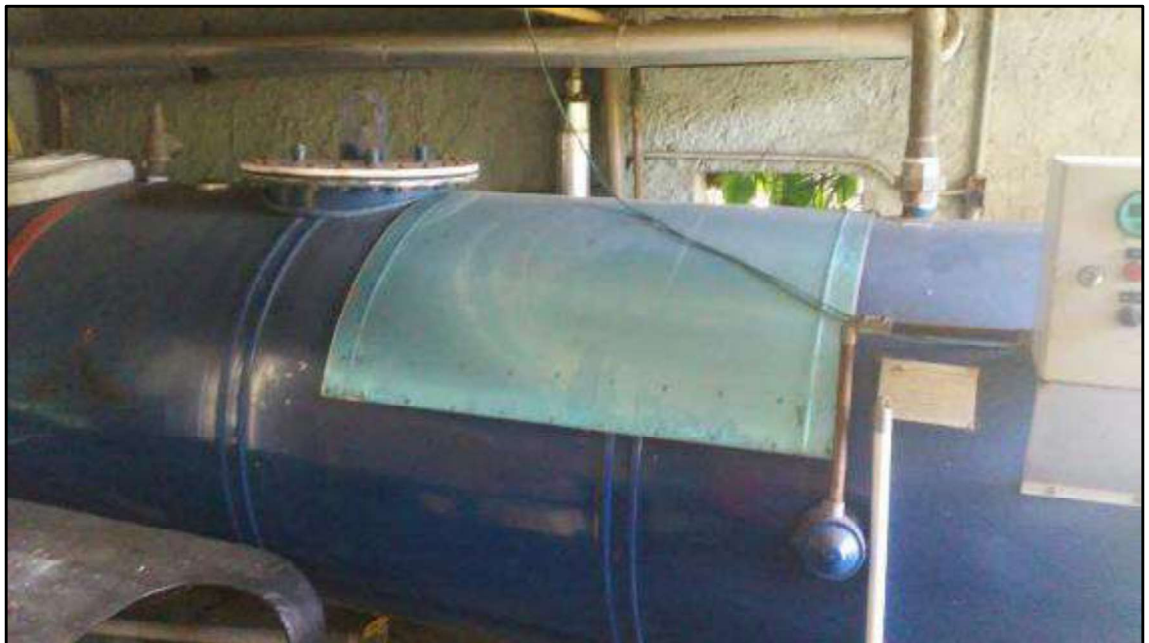
ITEM 1,003 - VISTA DA CALDEIRA A DIESEL THERMUS
