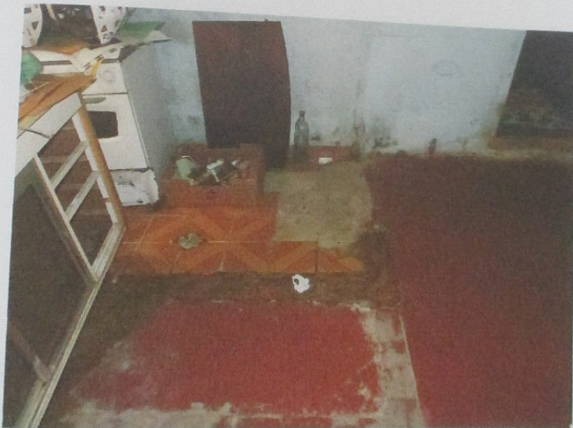
FOTO 07 - COZINHA I - PAVIMENTO TÉRREO
