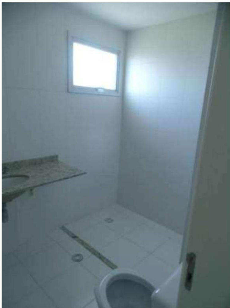
FOTO N.º 25- Tomada interna do banheiro do dormitório de n.º 02.
