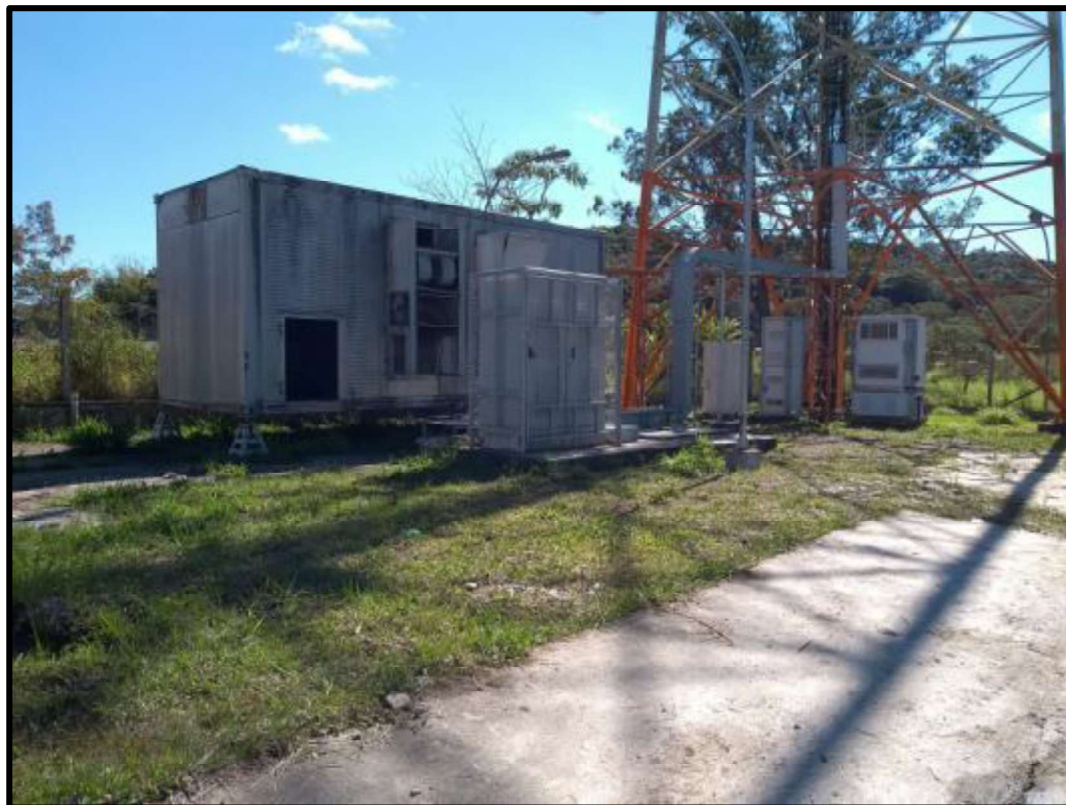
FUNDOS DO TERRENO, LOCAL EM QUE ESTÁ INSTALADA A ANTENA DE TRANSMISSÃO.
