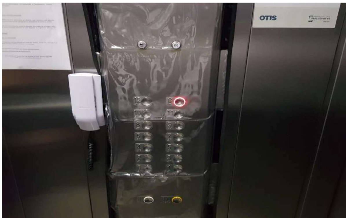
Foto 8 – Cabine de elevador
