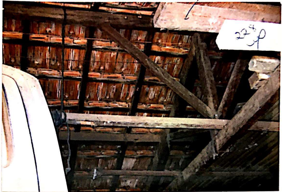
FOTO 5 MATRÍCULA 10.274: Detalhe da cobertura do salão 1, com estrutura de madeira e telhas francesas
