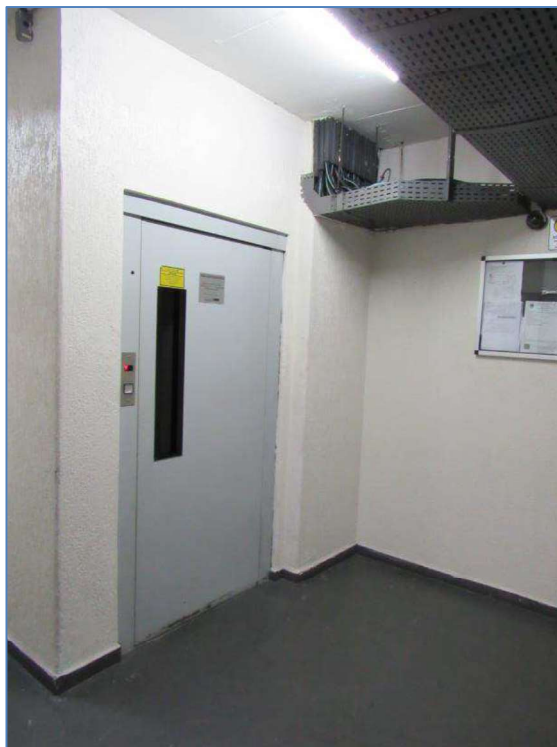
ELEVADORES NOS SUBSOLOS.
