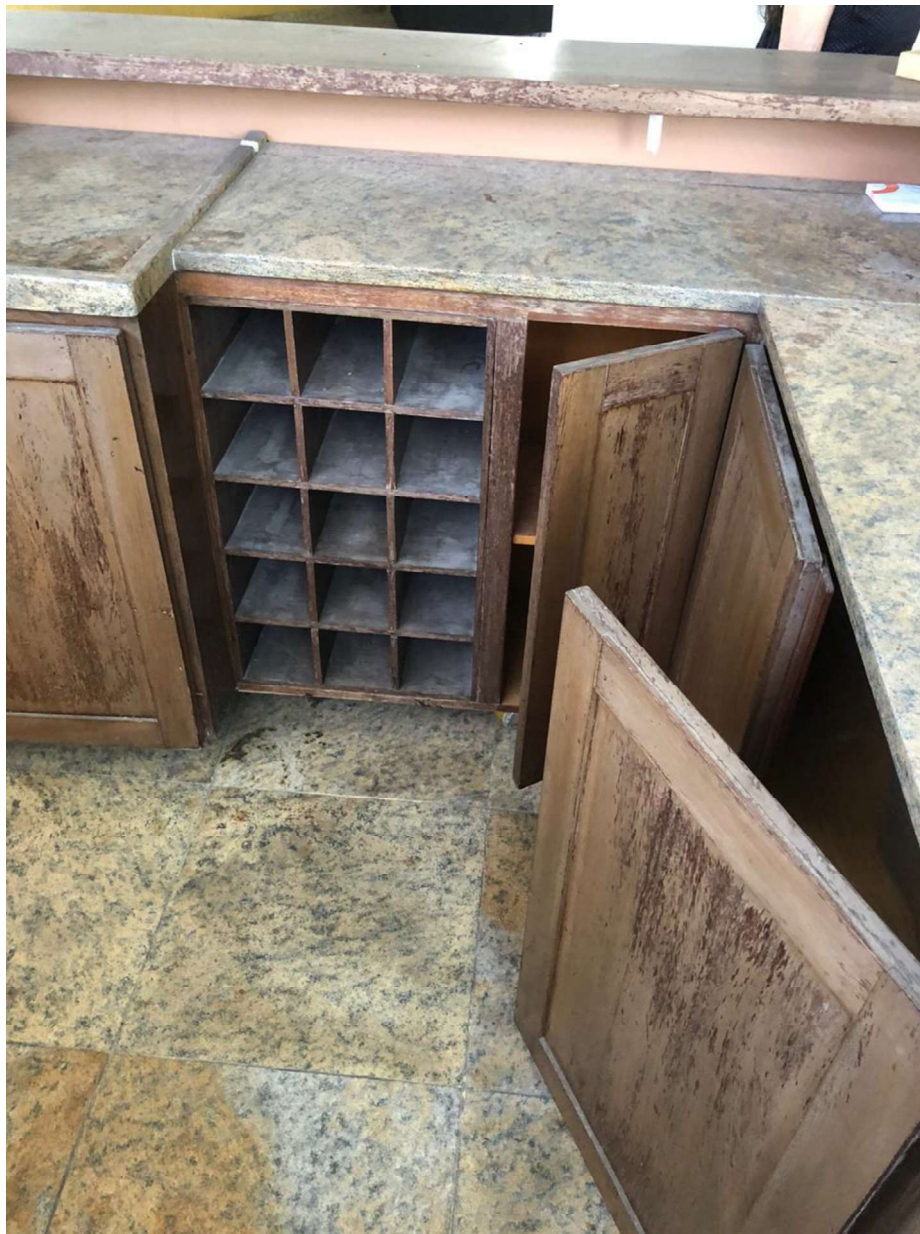
FOTO Nº 37 – Detalhe da deterioração dos armários no bar.
